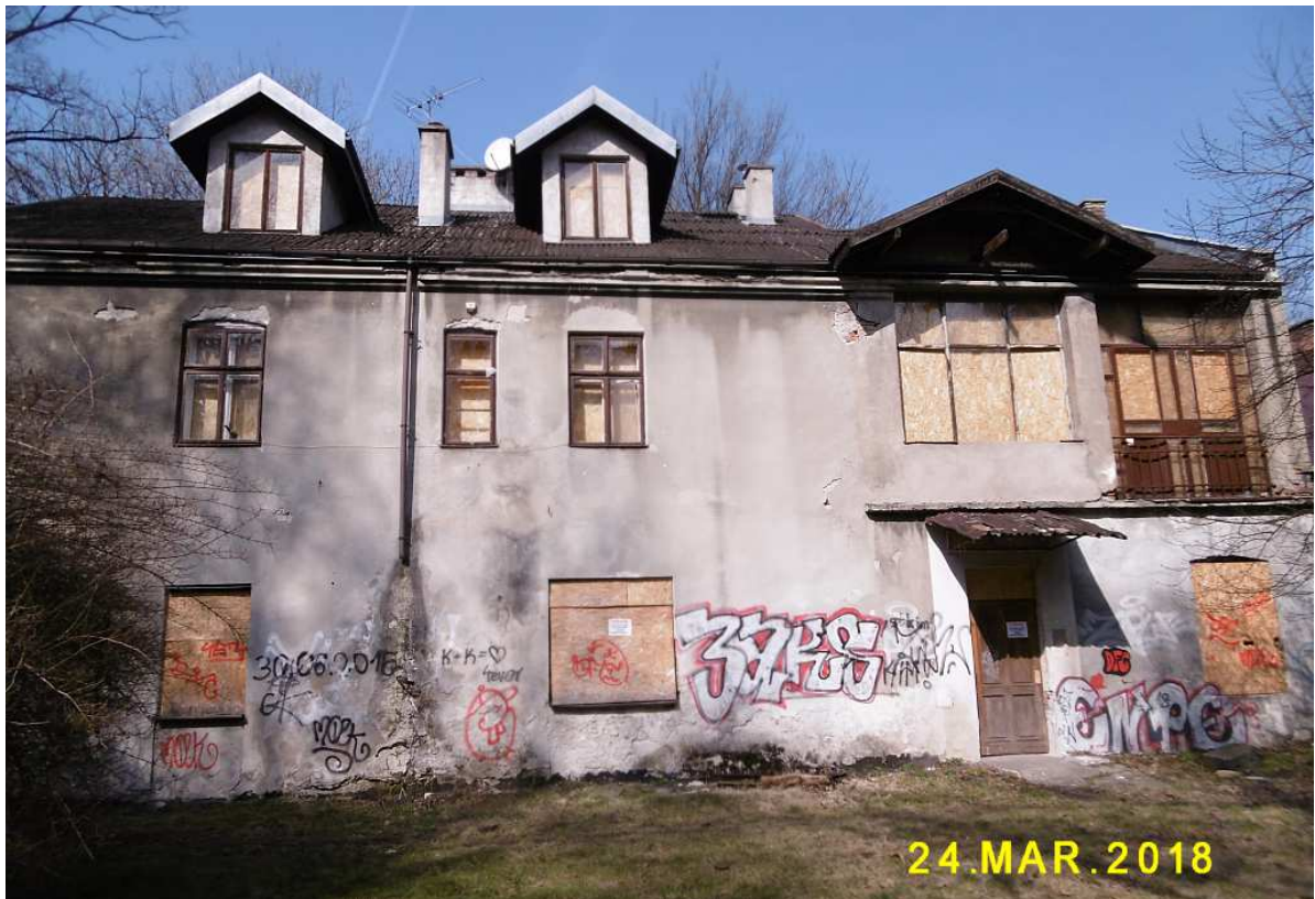
Fot. nr 153 (153-156). Systematycznie dewastowana fasada dworu, który jeszcze w roku 2015 był w dobrym stanie.
