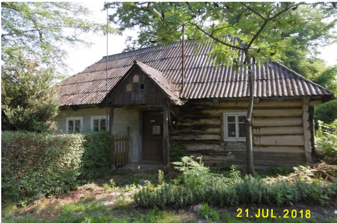
Fot. nr 282. Mocno zniszczony już dom z ulicy Jezerskiego 3, którego powstał w II połowie XIX wieku
