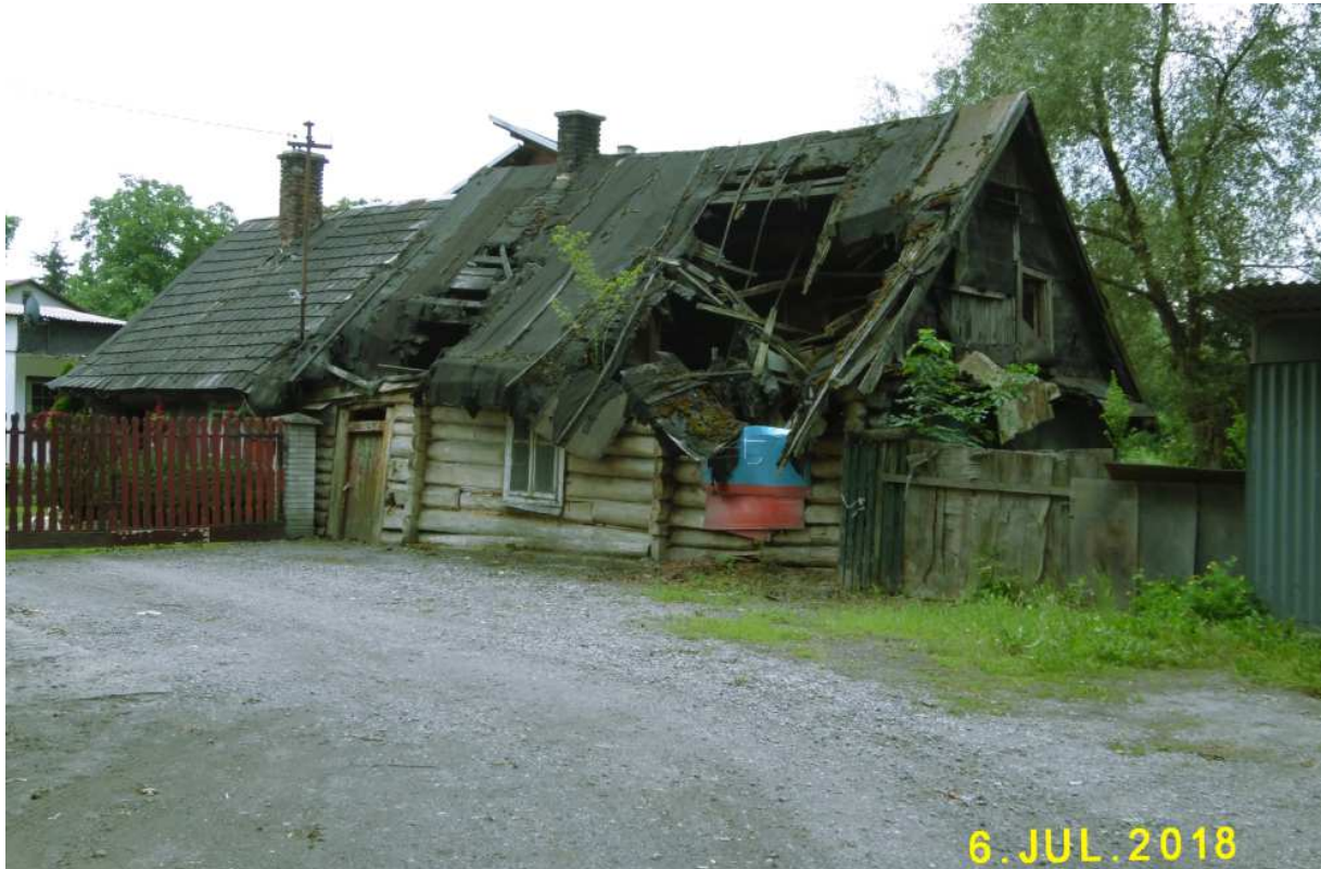
Fot. nr 257. Ukryta na tyłach posesji z ulicy Wańkowicza 157 (pod nr 161?) piękna kiedyś chałupa, dziś w stanie totalnej ruiny.
