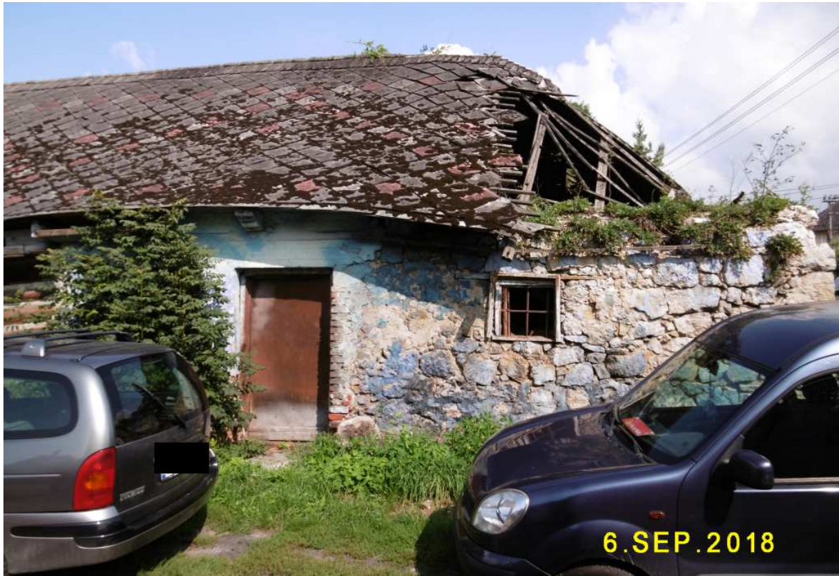
Fot. nr 146. Uszkodzona stajnia, dobudowana do korpusu chałupy w czasie okupacji hitlerowskiej.
