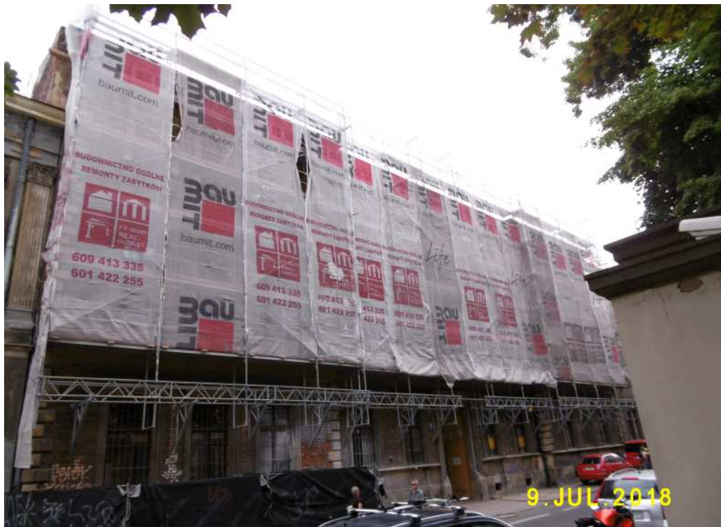
Fot. nr 69 (69-70). Kamienica spod nr 11A na etapie remontu i dobudowania oficyny.
