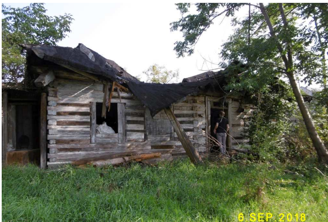
Fot. nr 136 (136-137). Agonia pięknej kiedyś chałupy z ulicy Skotnickiej 208.
