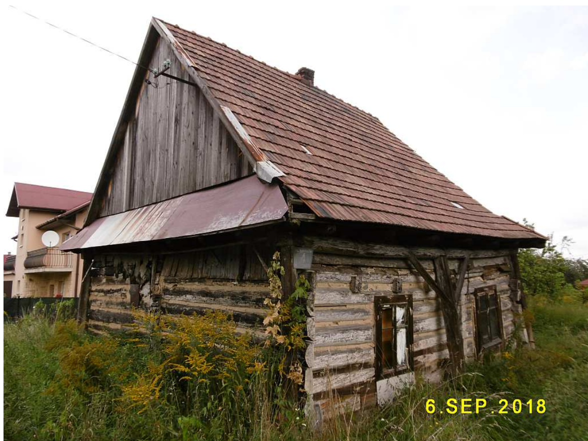
Fot. nr 151. Inny relikw z Bronowic Wielkich, mocno zniszczona już chałupa z ulicy Budrysów 4.
