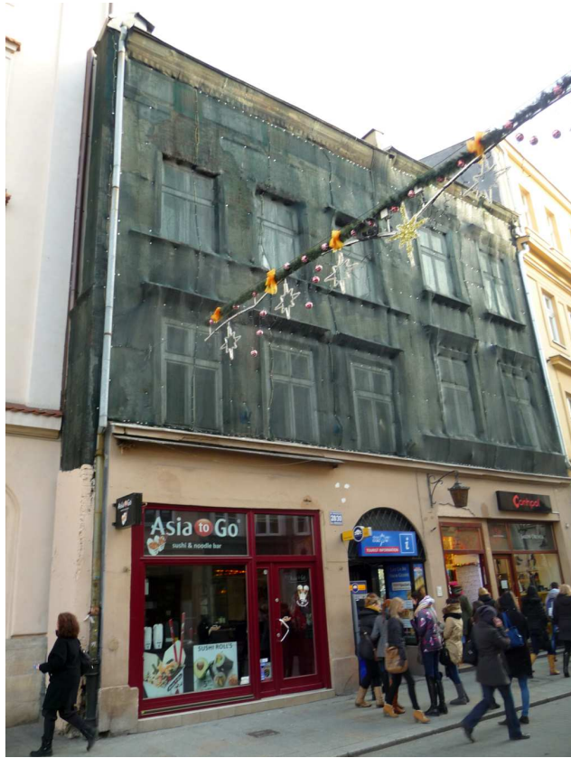
Fot. nr 6 (6-7). Ciągłe czekające na odnowę fasady kamienice spod nr: 28 i 30. (04.12.2013)
