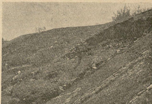
Ryc. 3. Osuwisko w Sadowiu na linii kolejowej Kraków—Warszawa, u góry na prawo widoczna niska osuwiska, na dole na lewo przesunięte masy tworzą tzw. jezora (fot. R. Krajewski)
