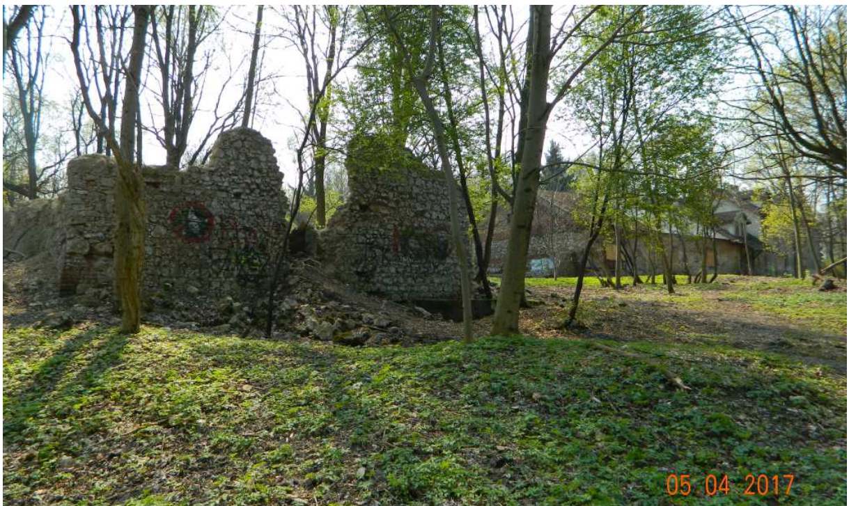
Fot. nr 171. Ruina budynku gospodarczego w sąsiedztwie ulicy Albańskiej.
