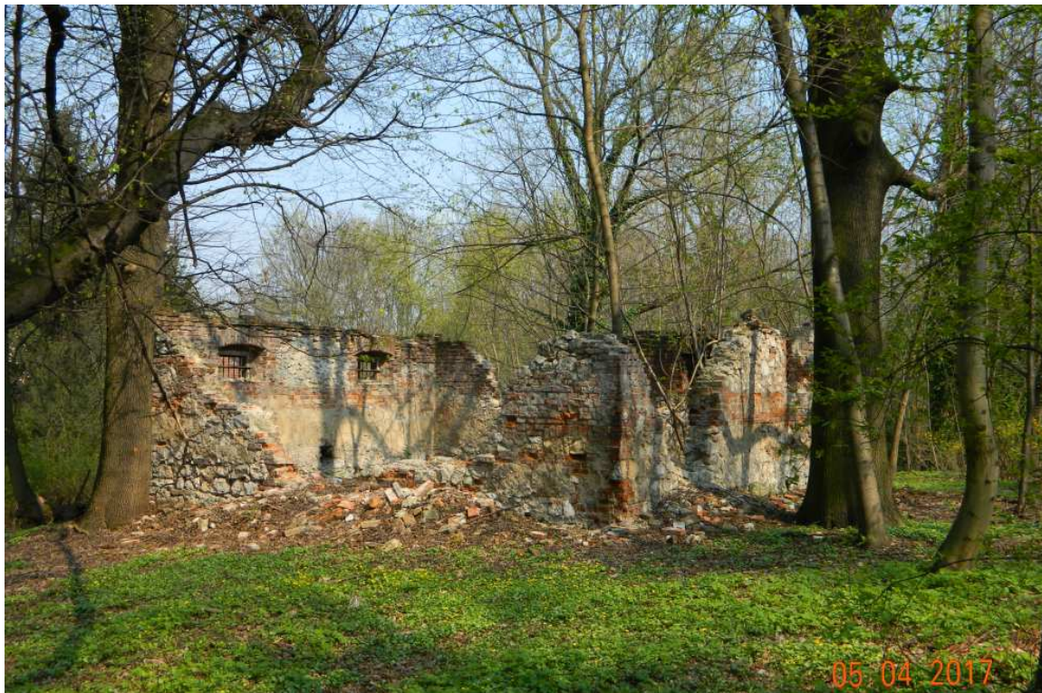
Fot. nr 159. Ruina budynku gospodarczego dawnego dworu Bemów w sąsiedztwie ulicy Estońskiej.
