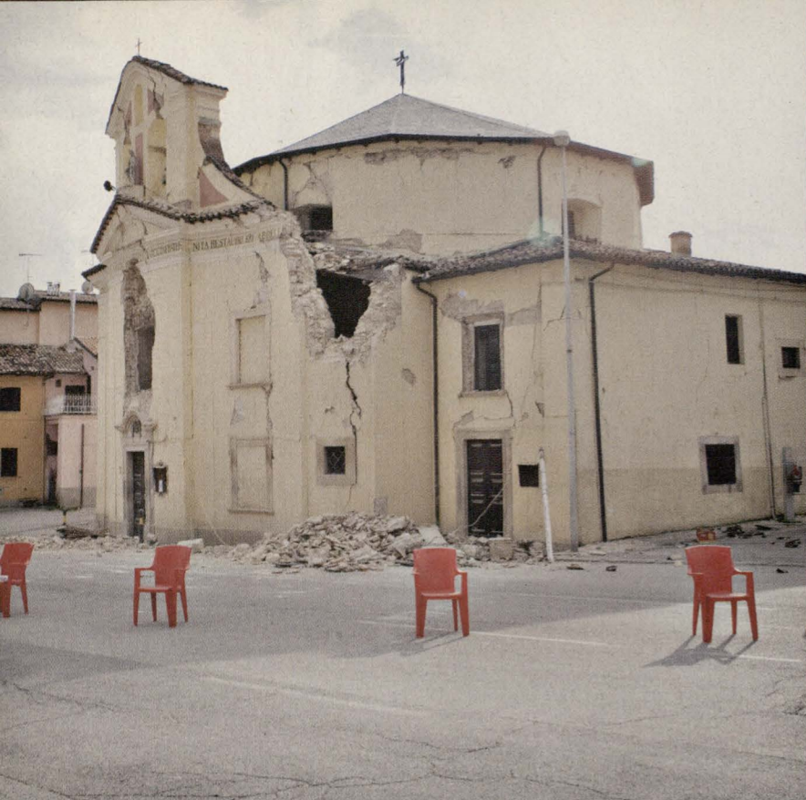
Paganica w prowincji Abruzja to zabytkowe miasteczko. Niektóre spośród zniszczonych budynków mają nawet tysiąc lat
