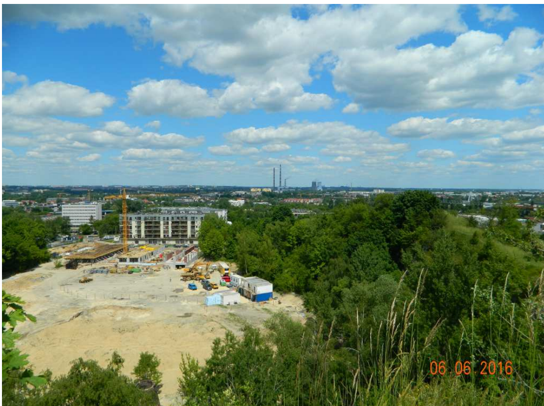
Fot. nr 82 (82-83). Trwa zabudowa niecki dawnego kamieniołomu miejskiego, który w czasie II wojny światowej był miejscem katorżniczej pracy więźniów KL Płaszów.
