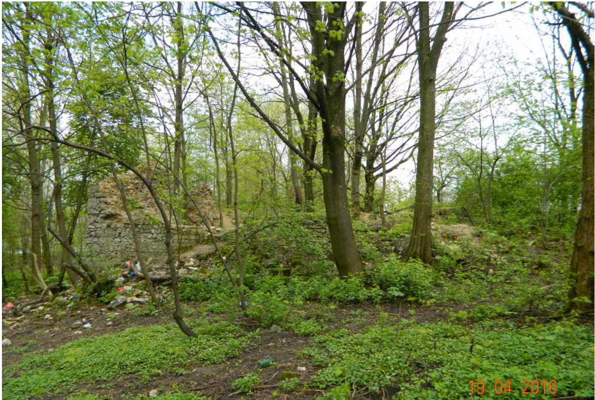
Fot. nr 107 (107-109). Ruina dawnego budynku gospodarczego w sąsiedztwie ulicy Albańskiej.
