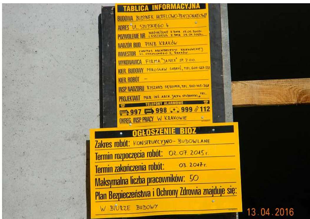
Fot. nr 97. Żeby nie było wątpliwości, kto jest właścicielem posesji i inwestorem budowy nowego hotelu, w miejscu wzorcowego wręcz założenia willowo-ogrodowego sprzed ponad 150 lat, które miało być chronione w PZP, ale „oczywiście” jego uchwalenie zbyt się ślimaczyło. To CARITAS Archidiecezji Krakowskiej.
