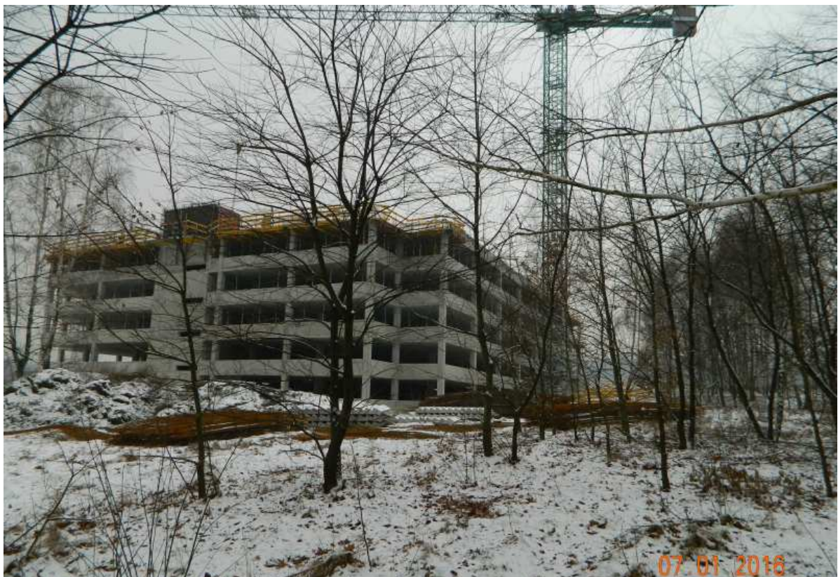
Fot. nr 232 (232-235). Spojrzenia na plac budowy kompleksu szpitalnego od strony osiedla Rząka.
