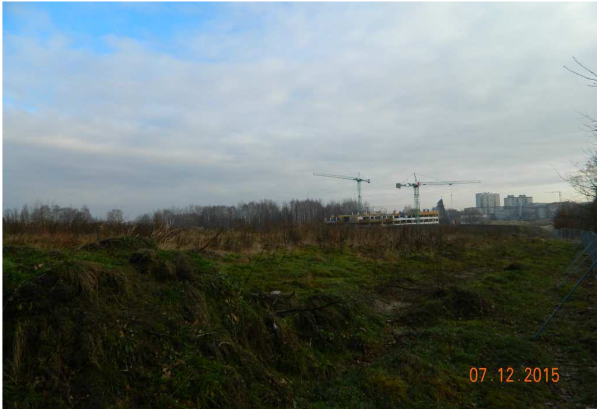
Fot. nr 225 (225-229). Kilka migawek z placu budowy centrum medycznego UJ. Po okresie całkowitej stagnacji tempo jego budowy jest ostatnio imponujące.
