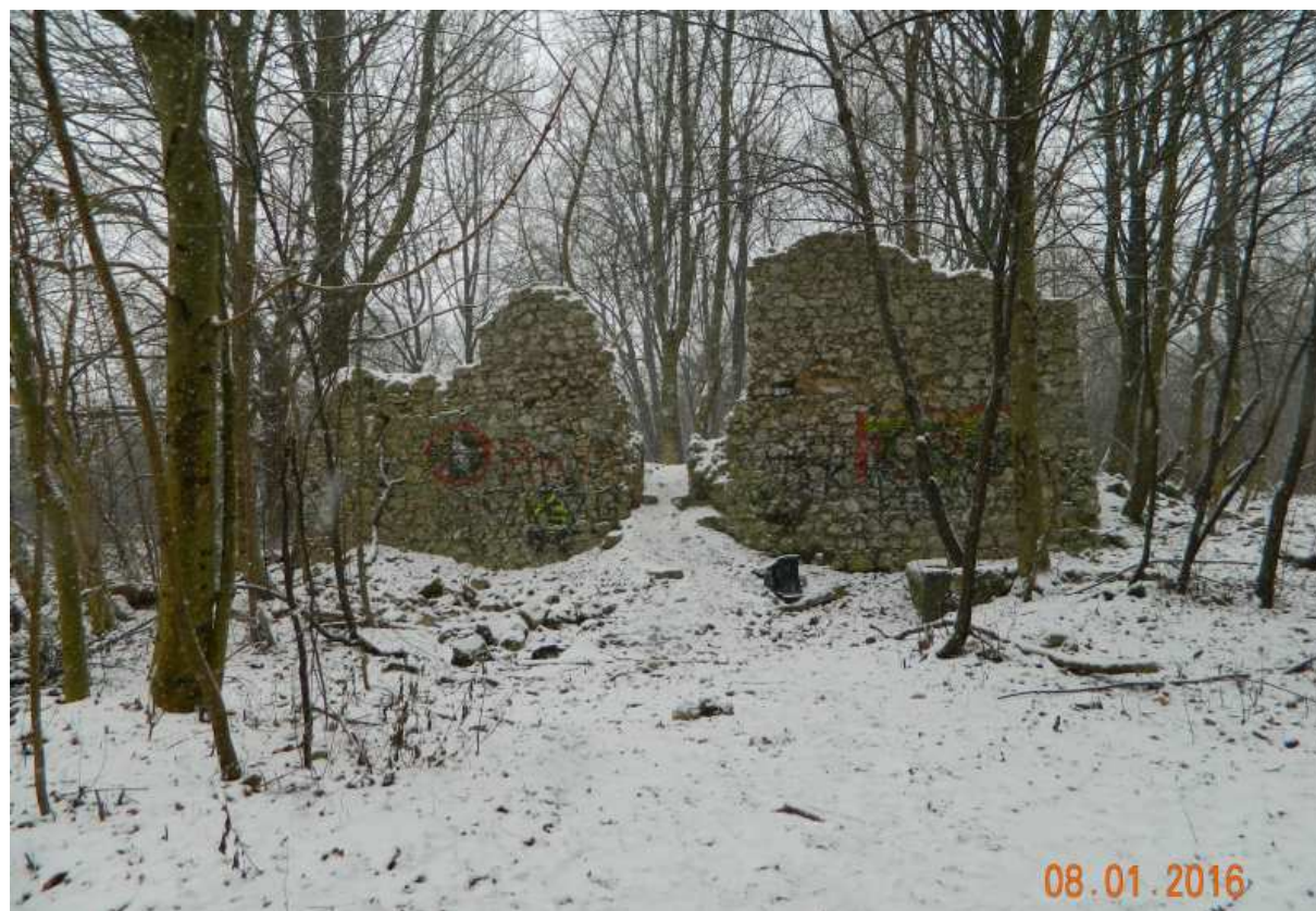
Fot. nr 66. Ruina budynku gospodarczego w sąsiedztwie ulicy Albańskiej.
