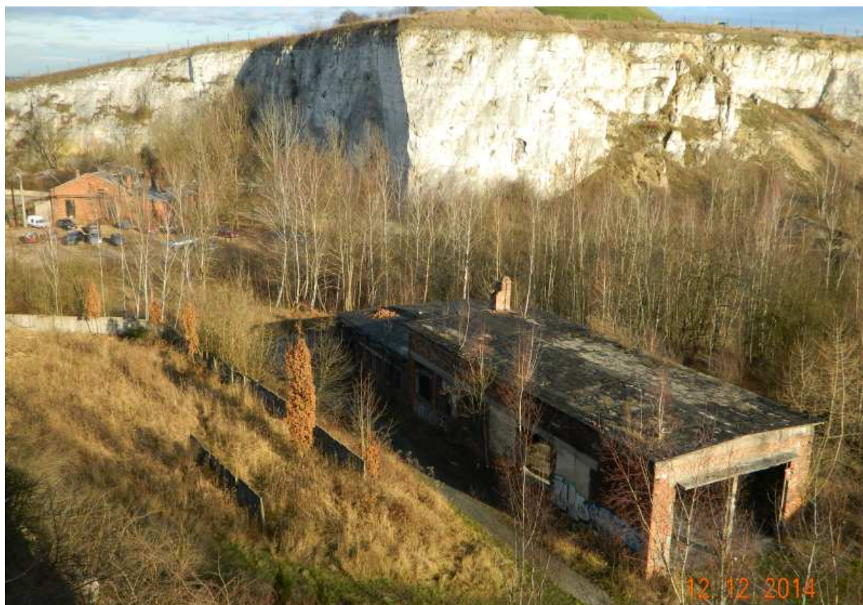
Fot. nr 65 (65-66). Ruina innego budynku z terenu dawnego kamieniołomu, przy instalacji przeróbki mechanicznej wapienia na kruszywo.
