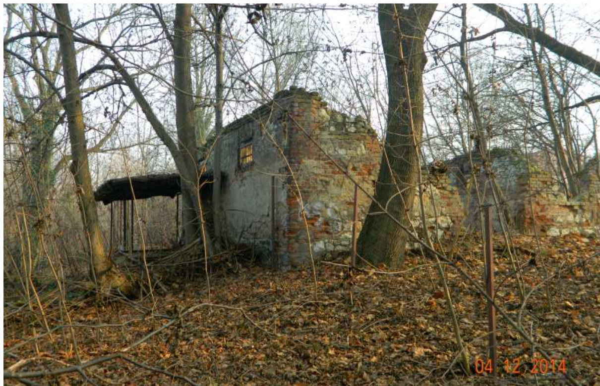
Fot. nr 177 (177-179). Ruina kolejnego budynku gospodarczego na styku ulic: Estońskiej i Laszczyki.
