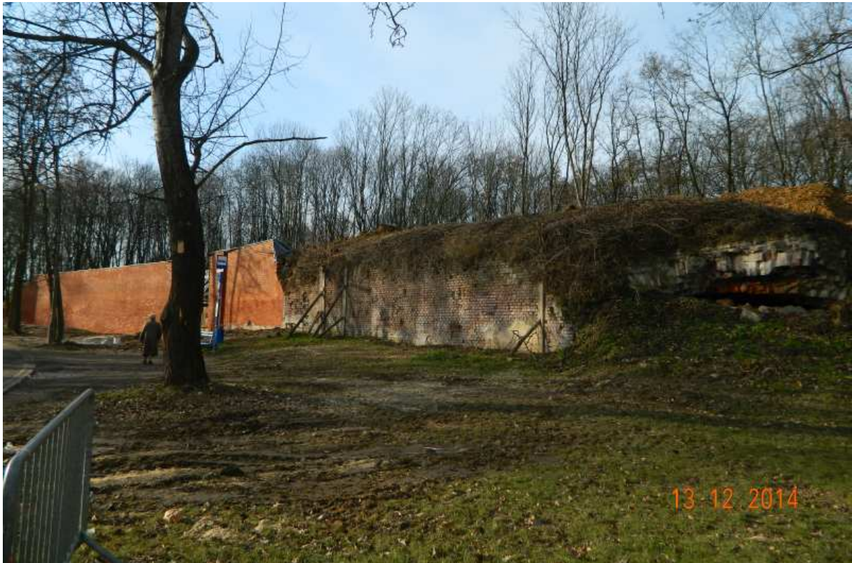
Fot. nr 17 (17-19). Trwają prace rewaloryzacyjne przy bastionie nr II i kurtynie I-II fortu.
