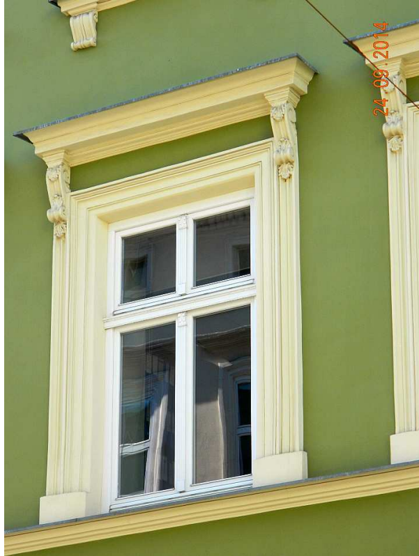
Fot. nr 7 (7-8). Nowa okna plastikowe jednak z odtworzonymi detalami w postaci głowiczek.
