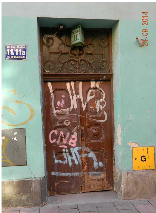
Fot. nr 19. Wołający o pomstę do nieba stan drzwi kamienicy z ulicy św. Marka 11/11a.
