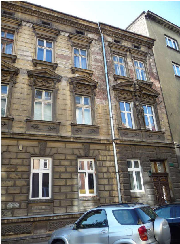
Fot. nr 78 (78-79). Mocno już zniekształcona plastikowymi oknami fasada eklektycznej kamienicy z Łobzowskiej 14, z lat 1885-87, autorstwa Wandalina Beringera. (17.09.14)
