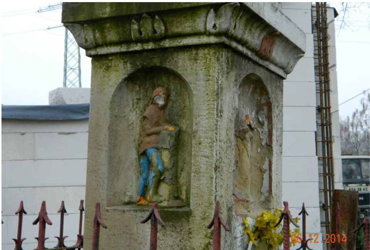
Fot. nr 275. Wymyte przez wodę pozostałości po figurach w licu i lewym boku przyziemia.
