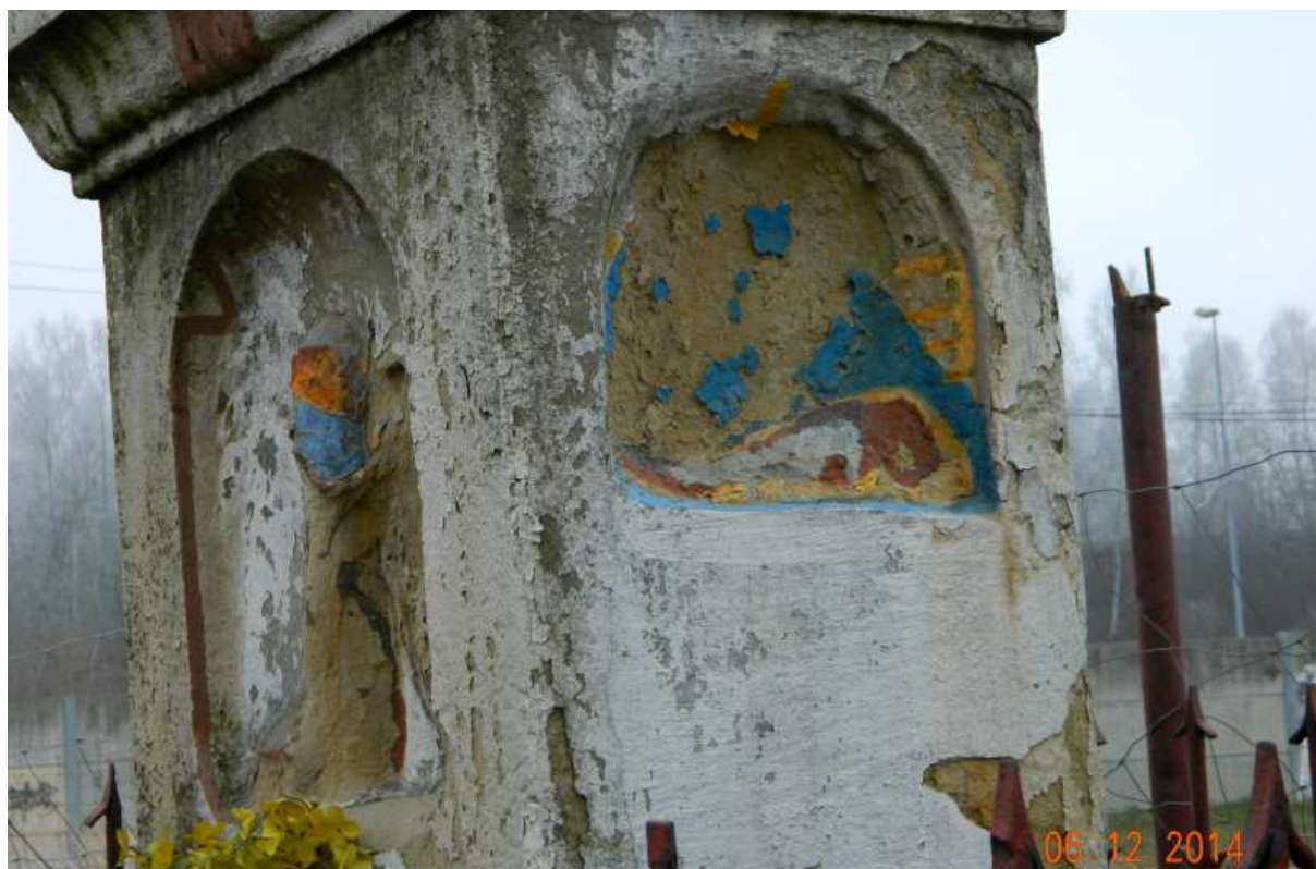
Fot. nr 280. Kompletnie nieczytelne postacie w licu i prawym boku przyziemia.
