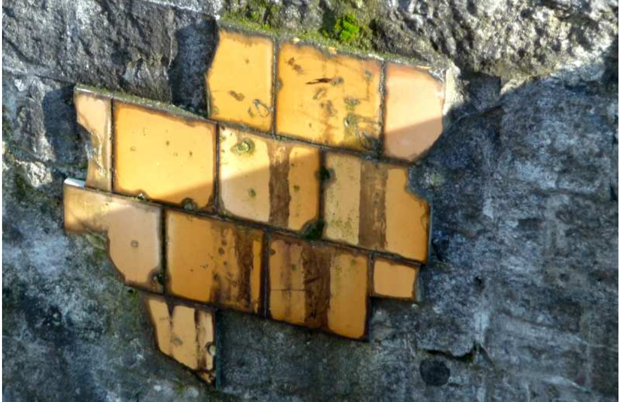
Fot. nr 20. Pozostałości płytek z dawnego wyłożenia basenu. (23.02.14)
