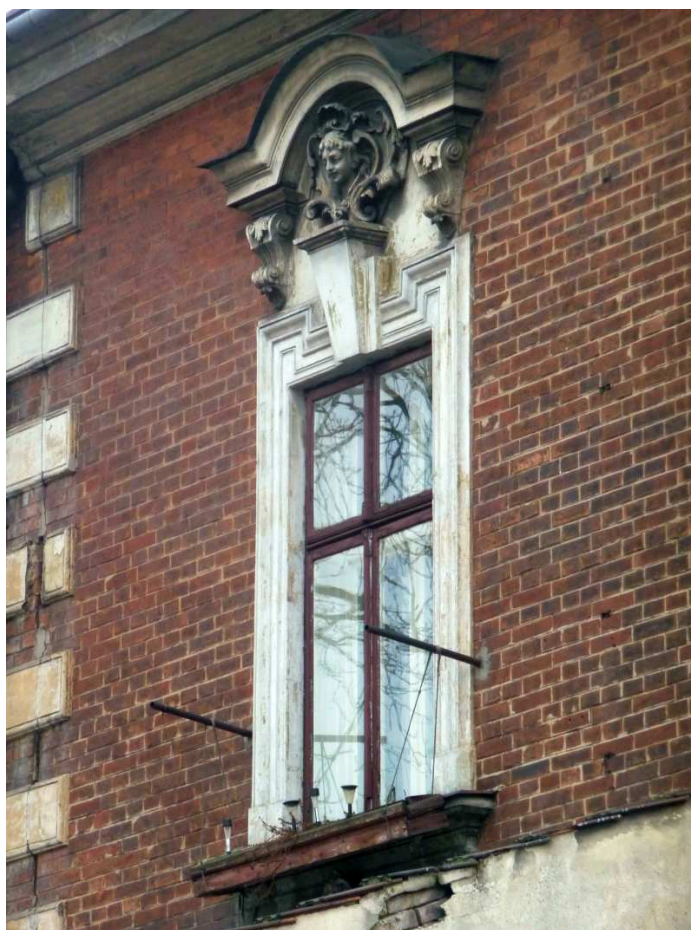
Fot. nr 80 (80-82). Detale pałacyku. Jedyne, zachowane oryginalne okno. (27.02.14)
