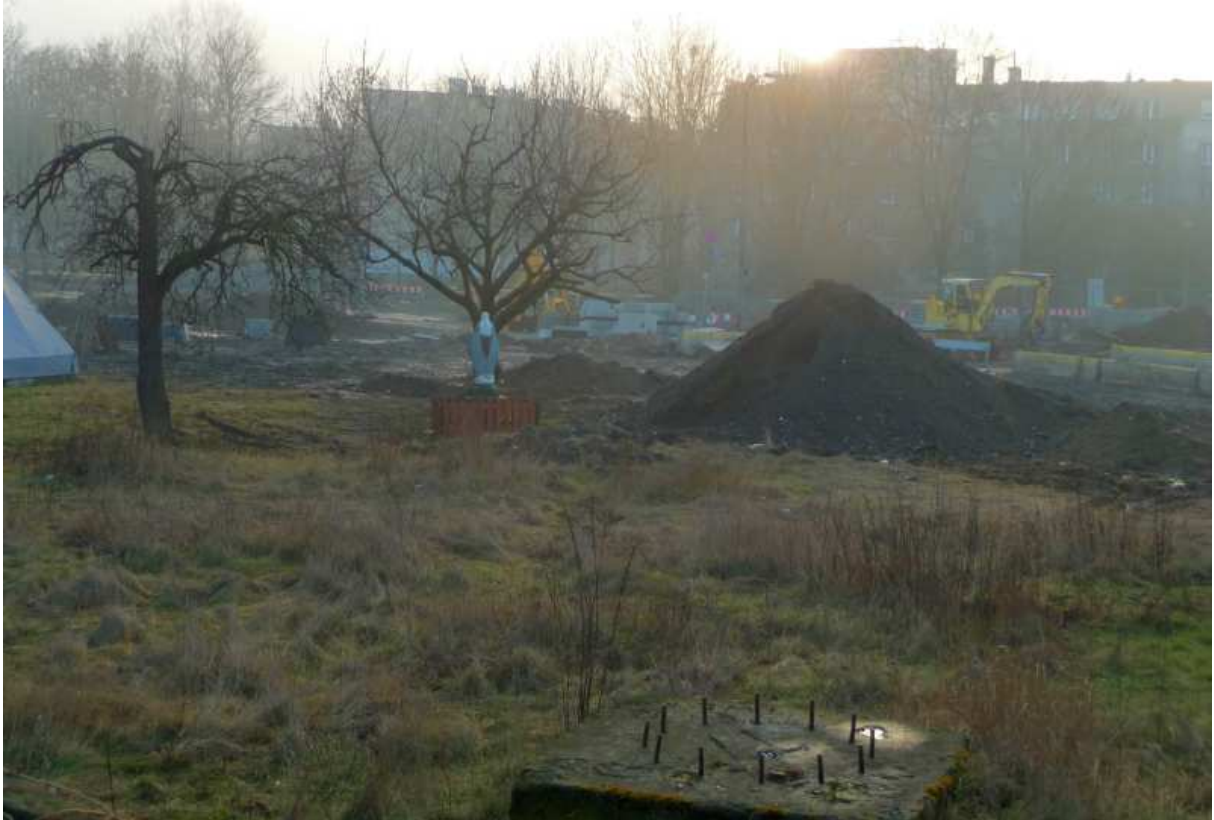
Fot. nr 201. Teren wokół kapliczki podczas końcowego etapu prac wyburzeniowych fragmentu zabudowy ulicy Barskiej (nr 65-69). (13.02.14)
