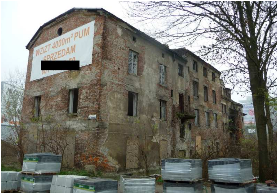
Fot. nr 191 (191-197). Ostatnie już fotografie zrujnowanego fragmentu międzywojennej zabudowy ul. Barskiej (nr: 65-69), oczekującej na rozbiórkę. (17.11.13)
