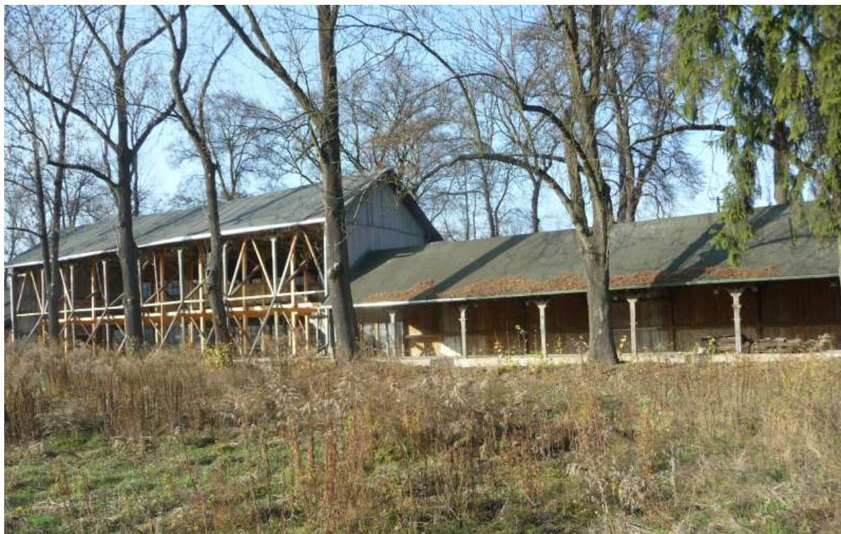
Fot. nr 10 (10-11). Tylna część reprezentacyjnego budynku dawnej strzelnicy, którego stan od chwili przejścia strzelnicy przez Gminę woła o pomstę do nieba. (17.11.13)
