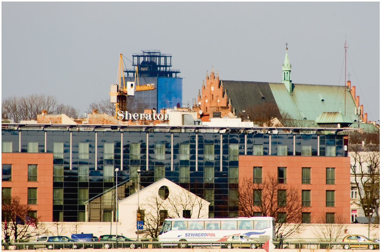
11. Zdjęcie zrobione z Bulwarów Wiślanych, od strony Dębnik. Widać wyraźnie stosunek wysokości szkieletu do bryły kościoła Dominikanów
