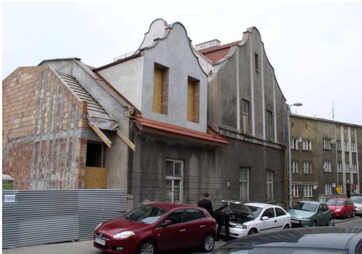
Fot. nr 83. Przebudowywany domek z naroża z ulicą Podskale. (23.04.09)
