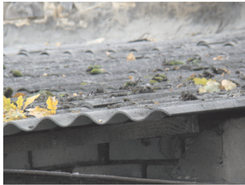
Na naszych dachach i w obejściach jest jeszcze wciąż dużo azbestu. Będzie lepiej
