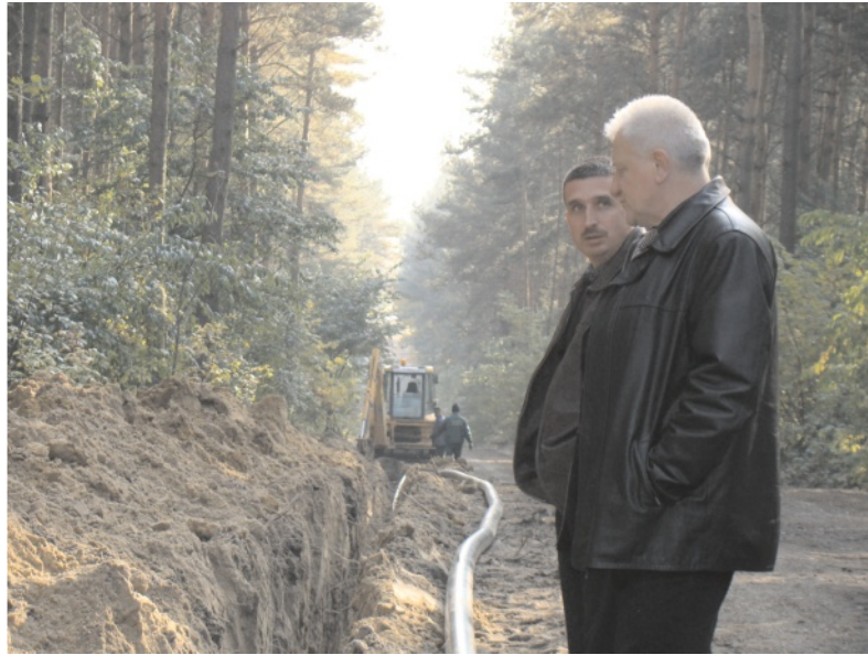
Burmistrz Jan Łaksa i dyrektor WZWiK Adam Kamionka oglądają prace przy nowym wodociągu
