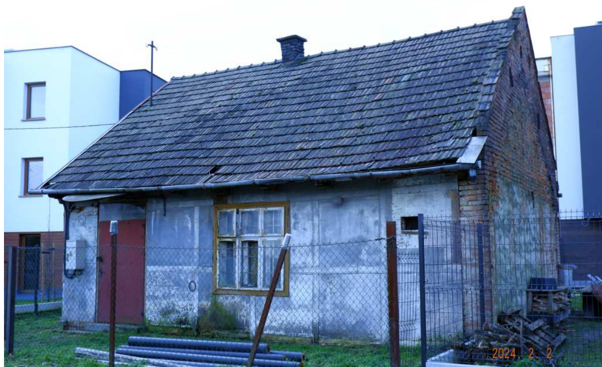
Fot. nr 300 (300-301). Mocno zniekształcona fasada.
