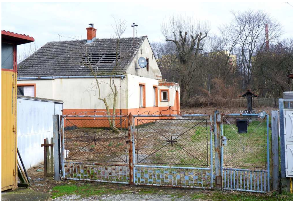
Fot. nr 491. Ruina domu z ulicy Zadworze 6. (14.02.2024)
