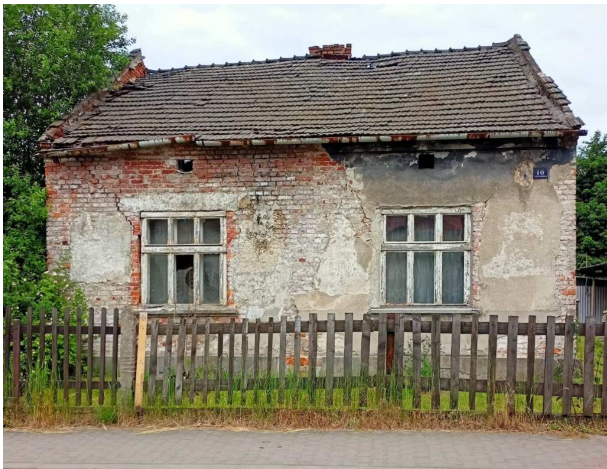
Fot. nr 571. Kolejna ruina podmiejskiego domu, tym razem pod nr 16. (06.06.2023)
