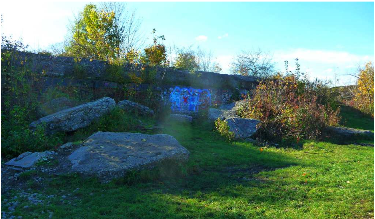
Fot. nr 400 (400-402). Zrujnowane koszary fortu, których w połowie lat 50. nie udało się rozebrać na materiał budowlany. (02.11.2023)
