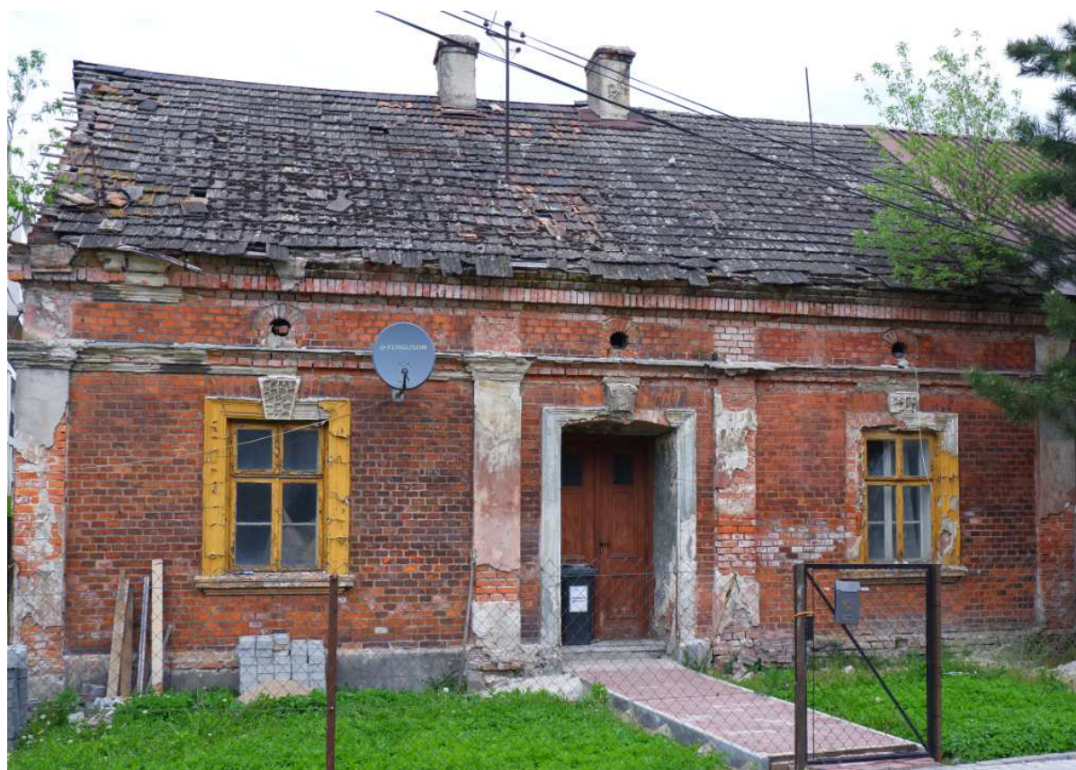
Fot. nr 546. Ostatnie chwile podmiejskiego domu z ulicy Wodnej 38, wybudowanego na początku XX wieku. Oryginalna fasada z oknami typu skrzynkowego. Aż wierzyć się nie chce, że taki obiekt może zniknąć. (13.05.2023)
