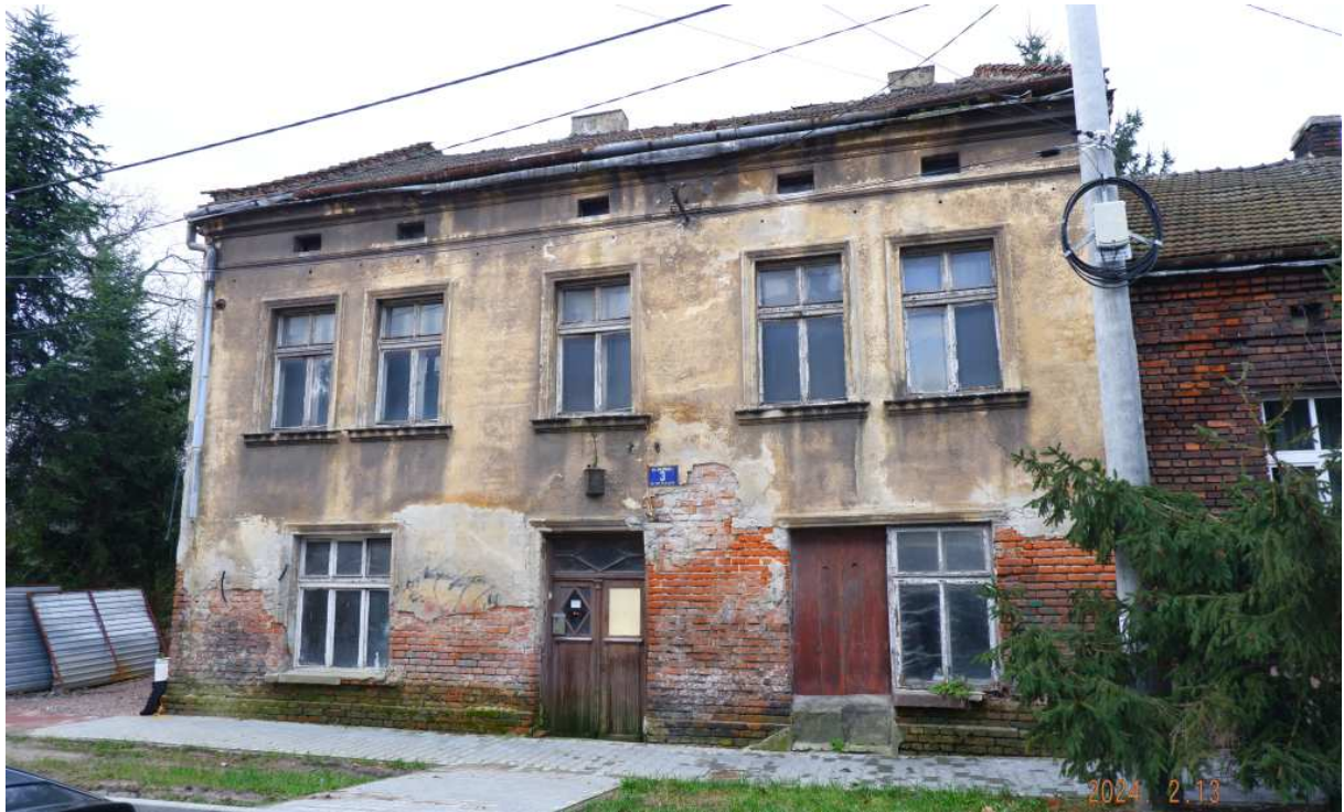
Fot. nr 515. Opuszczona kamieniczka pod nr 3.
