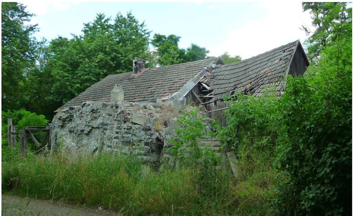
Fot. nr 470 (470-471). Ruina zdeformowanej chałupy w zagrodzie pod nr 1. (26.06.2023)
