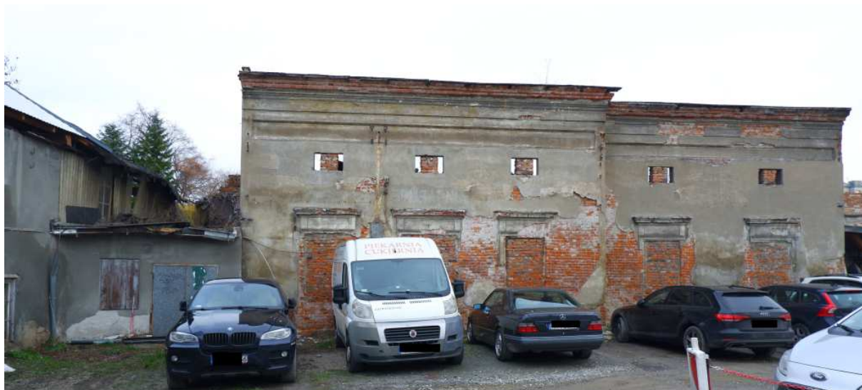
Fot. nr 43 (43-44). Jaki los czeka popadające w coraz większą ruinę zabudowania oficyny? (17.12.2023)
