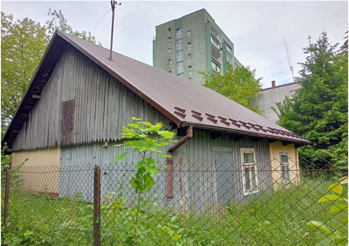
Fot. nr 567 (567-568). Popadający w ruinę dom przy ulicy Górników 7. (06.06.2023)
