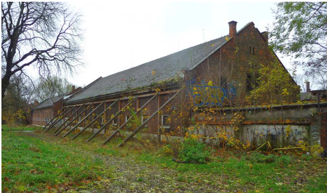
Fot. nr 551 (551-552). Popadający w ruinę dawny folwark Jerzmanowskiego „Na Wrzosach” przy ulicy Żniwnej 1. (20.11.2023)
