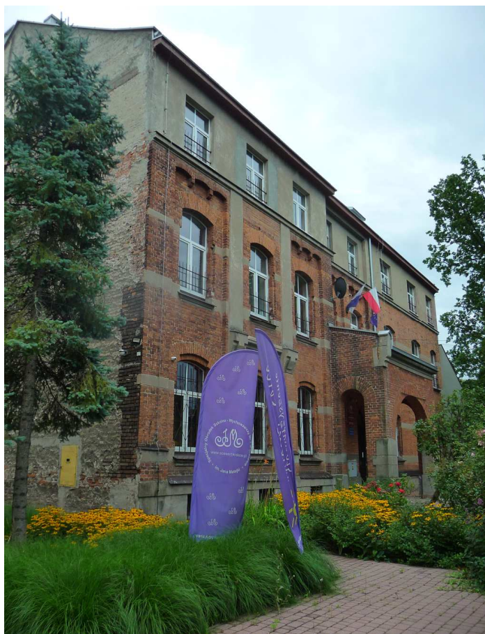
Fot. nr 376. Zniekształcony nadbudową gmach szkolny z ul. Szwedzkiej 42. (01.08.2023)
