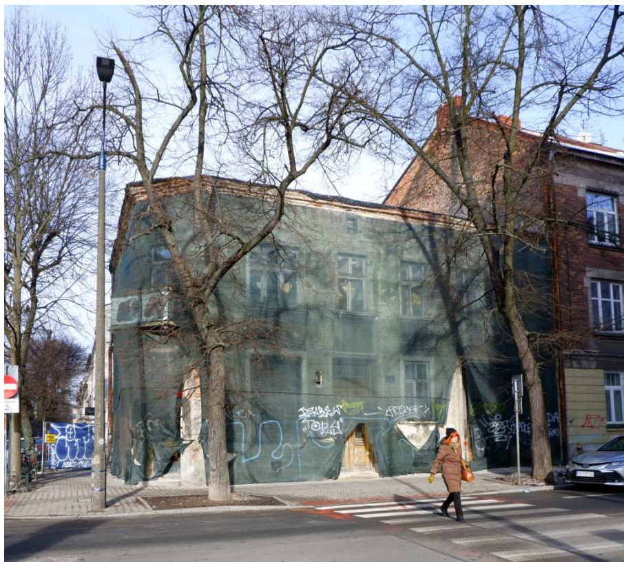
Fot. nr 184. Kamieniczka z początku XX wieku z naroża ulic: Senatorskiej 5 i Filareckiej 1. Początek prac rozbiórkowych
