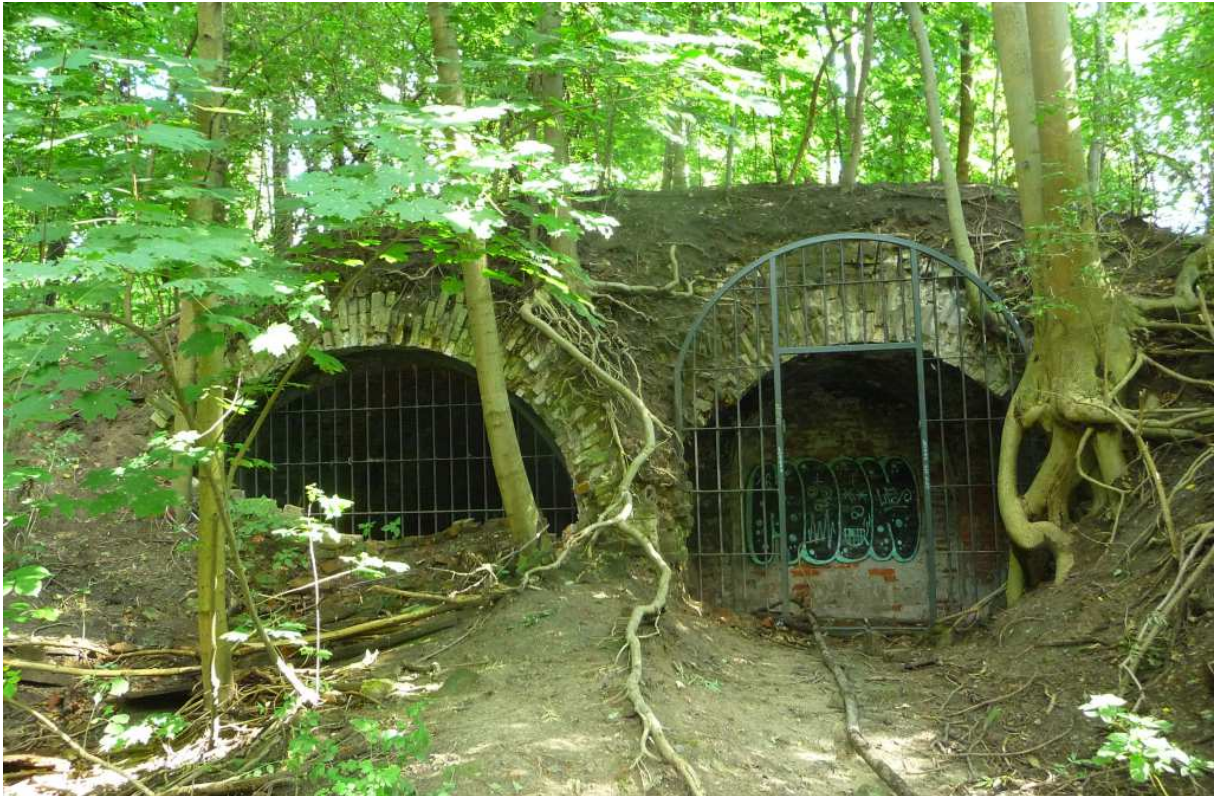
Fot. nr 277 (277-278). Zachowane reliktury Lunety Grzegórzeckiej, jednego z pierwszych fortów powstałej po roku 1850 Twierdzy Kraków. (03.09.2023)
