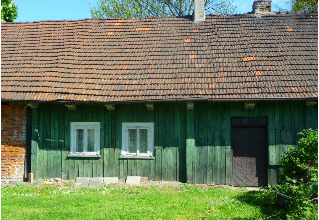
Fot. nr 601. Lewy fragment domu z nieroginalnymi już oknami. (11.05.2023)
