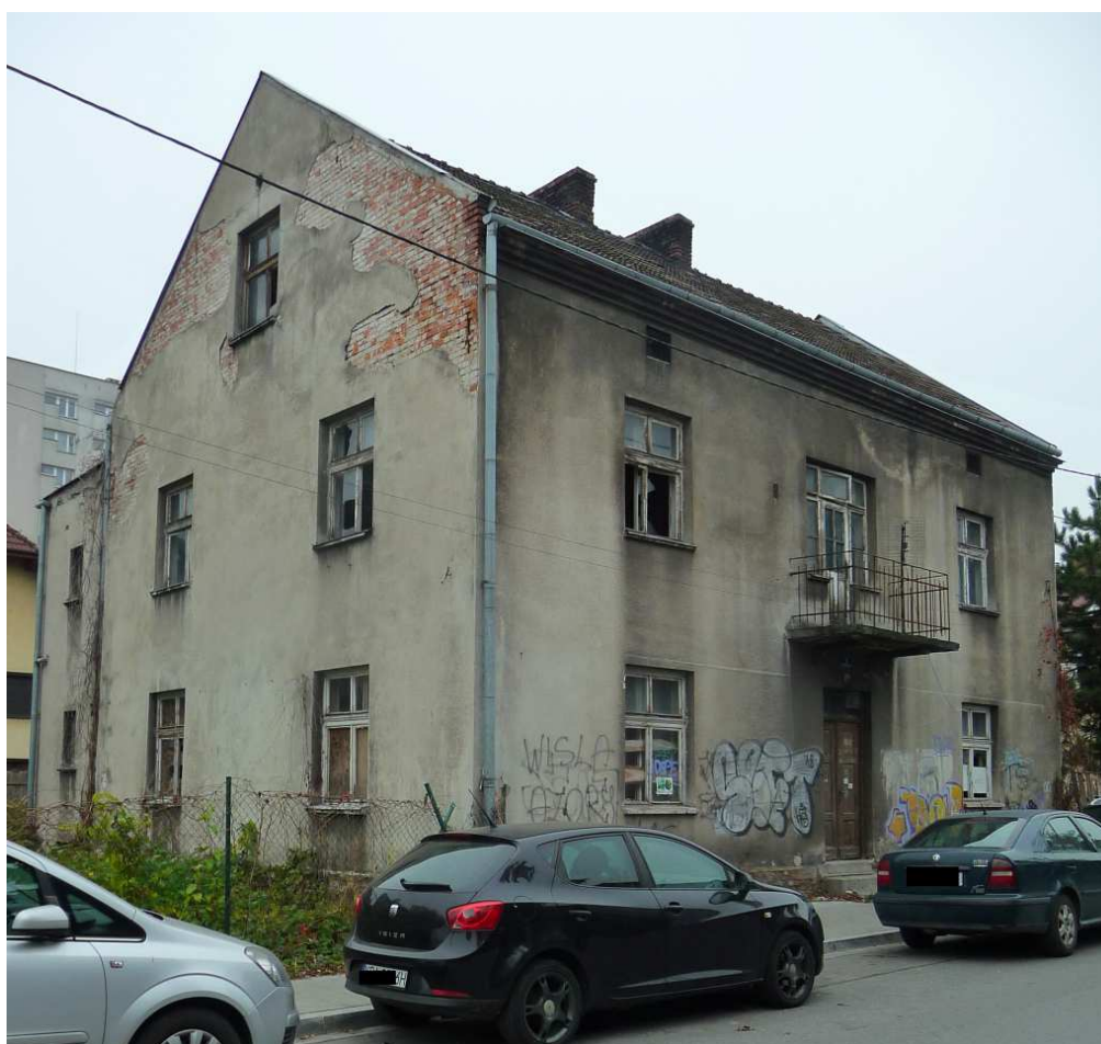
Fot. nr 115. Opuszczona od lat kamieniczka z ulicy Mehofera 4. (14.11.2022)
