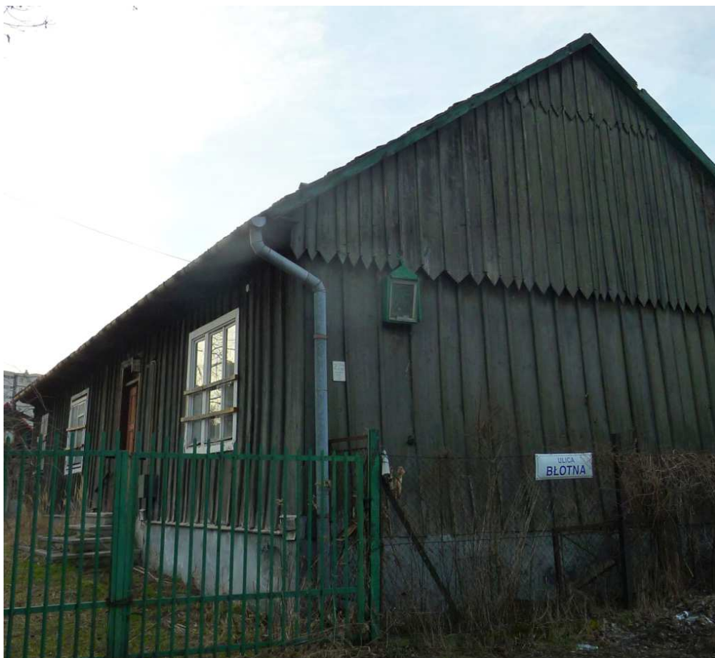
Fot. nr 382. Pokryta szalunkiem z desek fasada z nieoryginalnymi oknami i ściana szczytowa. (07.03.2023)
