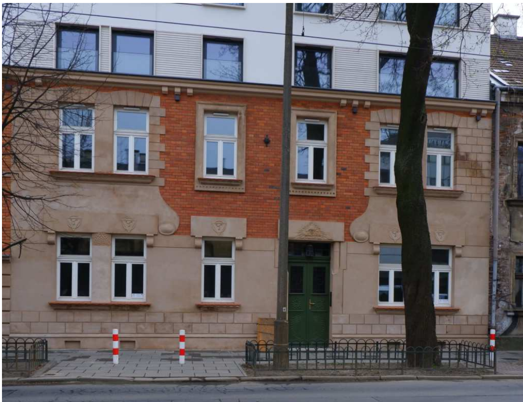
Fot. nr 60 (60-61). Zniszczony dom Pod Opatrznością spod nr 62. (29.03.2022)
