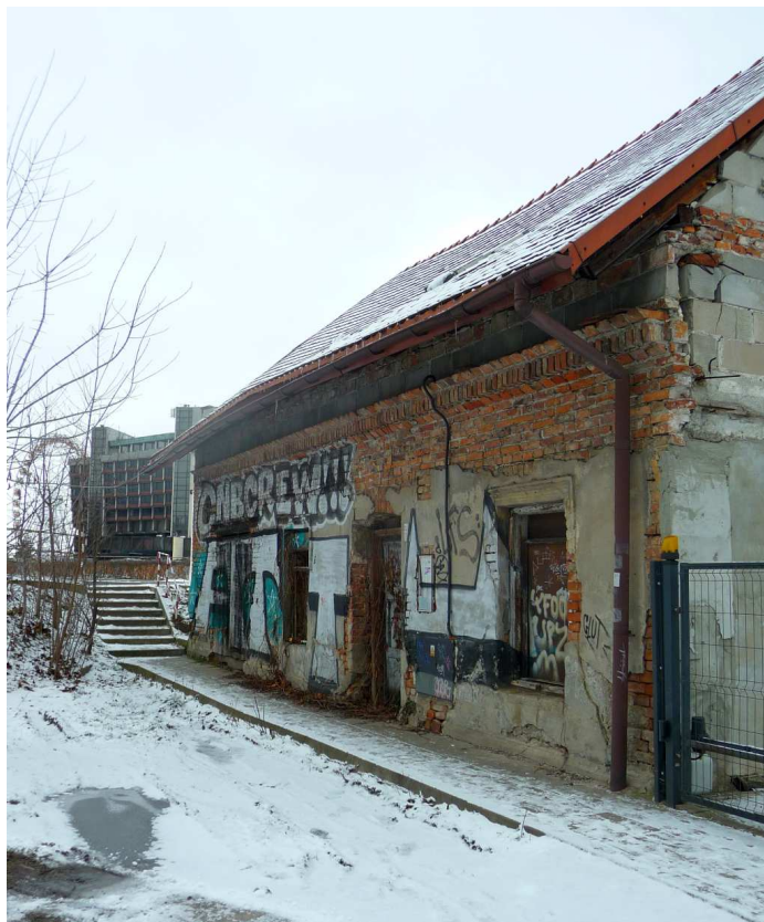
Fot. nr 290. Ruina murowanego domu o numerze 6. (05.02.2023)
