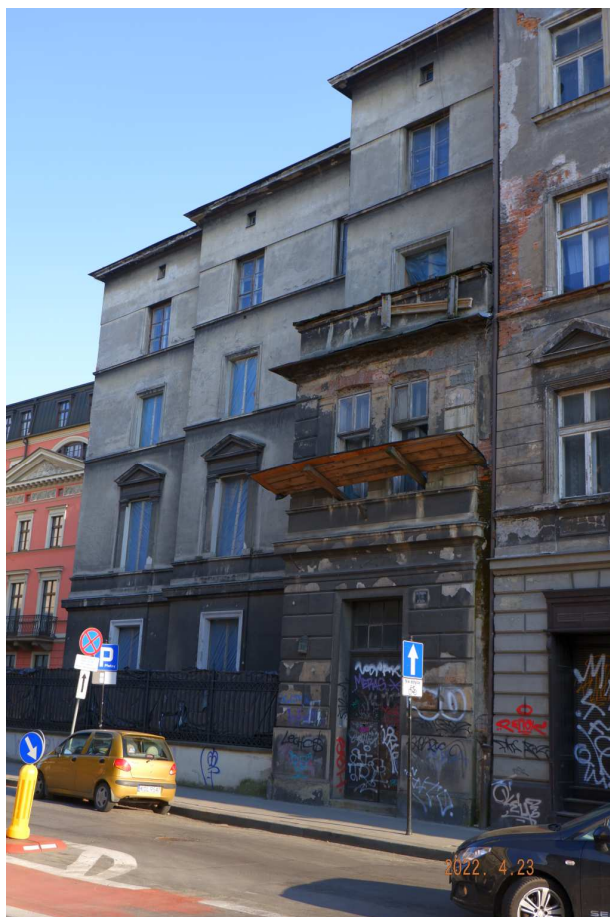
Fot. nr 24. Oczekująca od lat na remont kamienica z ulicy Krupniczej 18.
