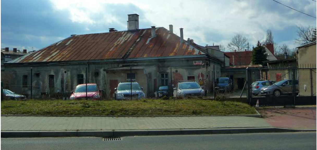
Fot. nr 306. Dawne zabudowania fabryczne z ulicy Dembowskiego 1, w których w przeszłości, w XIX wieku, mieścił się też szpital. (08.03.2023)
