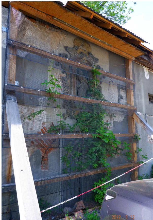
Fot. nr 1a. Rokokowa figura z roku 1753 na ścianie jednego z budynków oficyny kościoła Karmelitów przy ulicy Karmelickiej 19-25, która została częściowo zabezpieczona do prac konserwatorskich. Ściana, której groziło zawalenie, została na szczęście wzmocniona.
