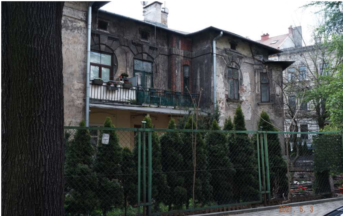
Fot. nr 207. Fragment od strony ul. Grabowskiego z ciągle oryginalnym I. piętrem.
