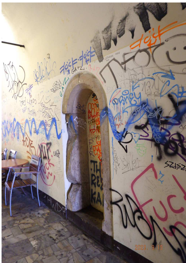
Fot. nr 17. Obramienie drzwi w zdewastowanej ścianie ciągu Pasażu Bielaka.
