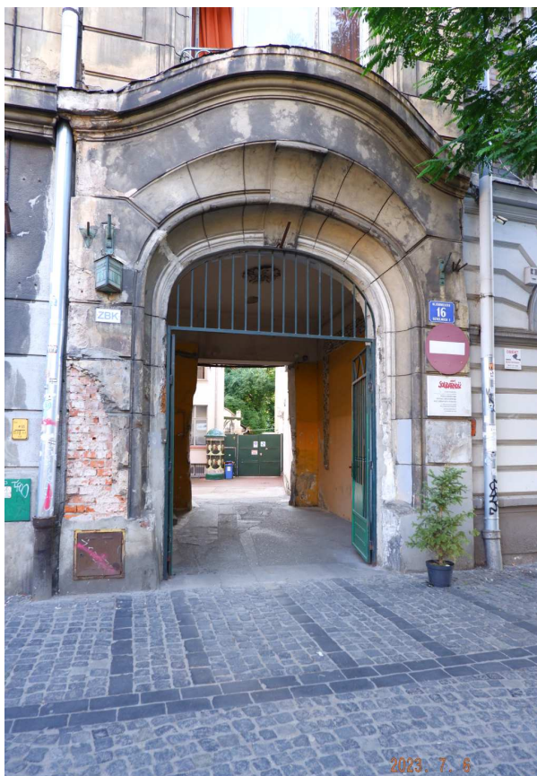
Fot. nr 154. Sień kamienicy pod nr 16; w tle pusta przestrzeń po korycie Młynówki.
