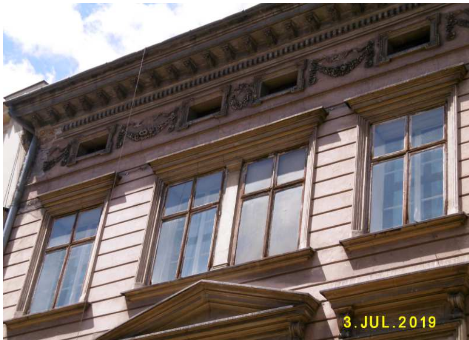
Fot. nr 92. Oryginalne drewniane okna o cienkich szprosach, otwierane na zewnątrz na poziomie II. piętra, które niebawem znikną.
