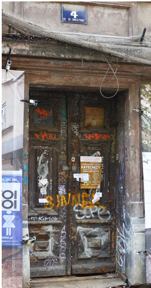
Fot. nr: 161-170. W ciągu ulicy Krupniczej. Fot. nr 161. Drzwi czekającej od lat na remont kamieniczki pod nr 4. (17.12.2023)
