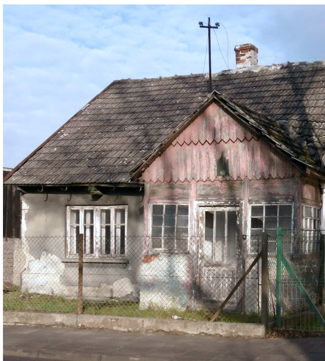
Fot. nr 517. Będący w ruinie, zapewne blisko 100-letni dom z oszklonym gankiem z ulicy Rżackiej 45. Oryginalny, lewy fragment elewacji frontowej.(09.01.2023)
