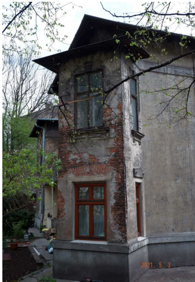
Fot. nr 206. Narożny wykusz z oryginalnymi jeszcze oknami I piętra
