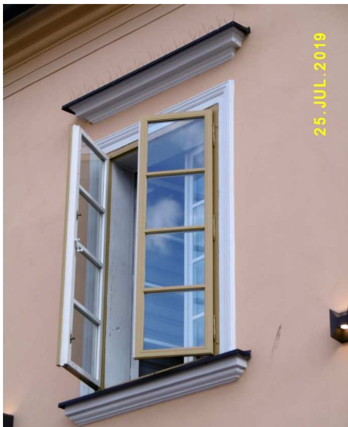
Fot. nr 34. Żeby tak jeszcze po remoncie został odtworzony lufcik .....
