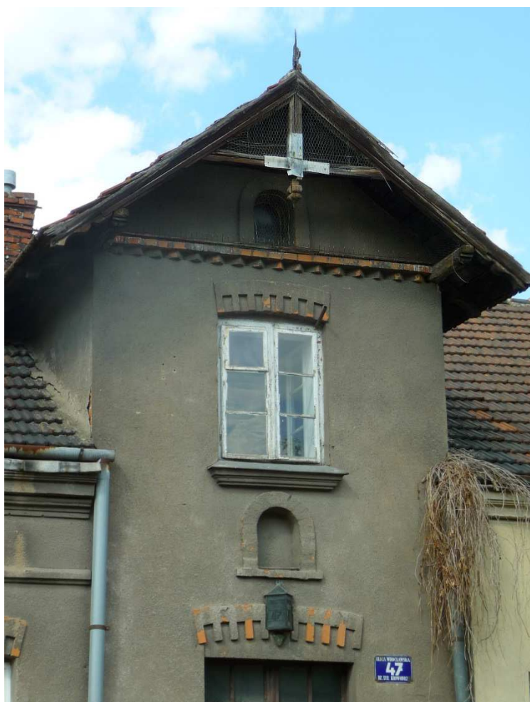
Fot. nr 294. Facjata nad wejściem domu pod nr 47 i jej oryginalna stolarka. (23.04.2023)
