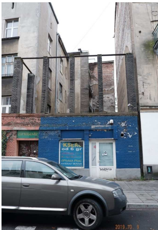
Fot. nr 192. Ostała do niedawna konstrukcja wiszącego (kiedyś) ogrodu przy kamienicy z ulicy Rajskiej 20.
