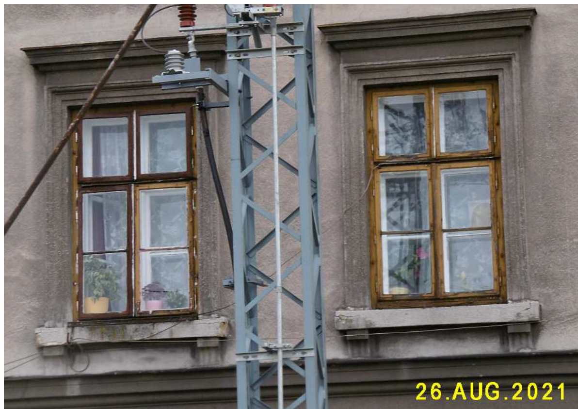
Fot. nr 481. Dwa z trzech pozostałych w fasadzie oryginalnych okien typu skrzynkowego.
