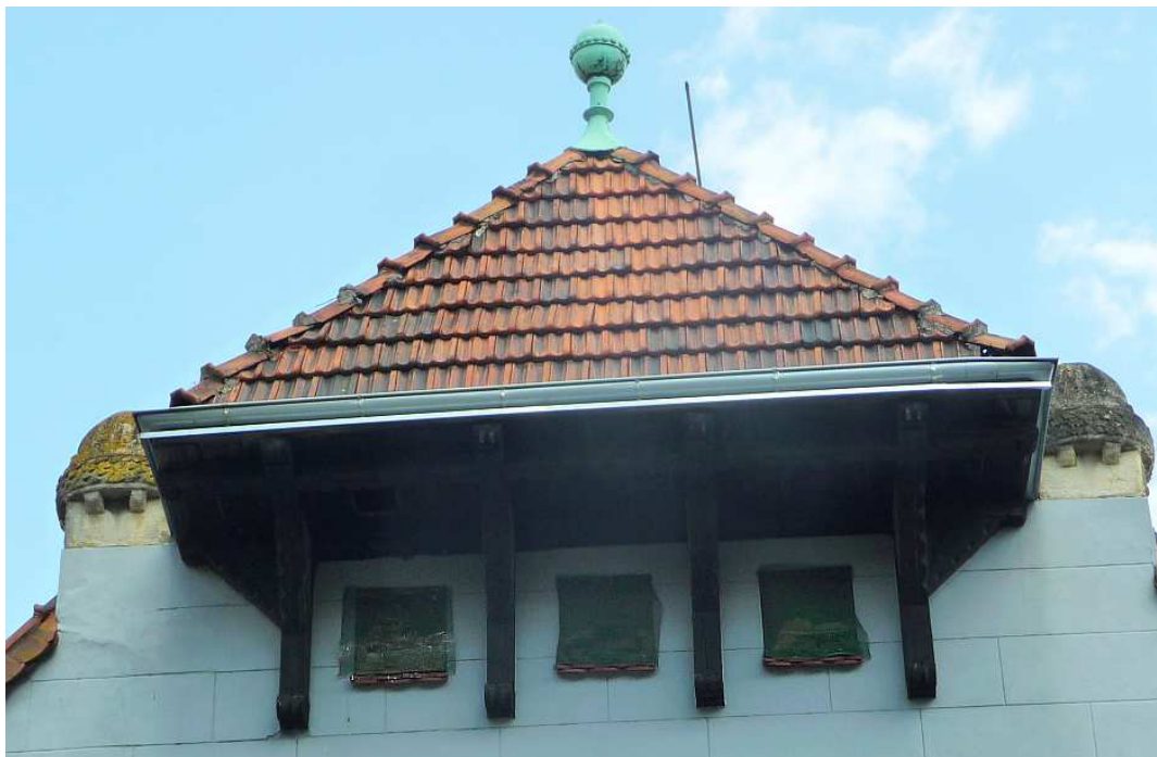
Fot. nr 287. Dom pod nr 15 przy ulicy Kujawskiej, dzieło Jana Rzymkowskiego z roku 1912. Zwieńczenie fasady. (23.04.2023)
