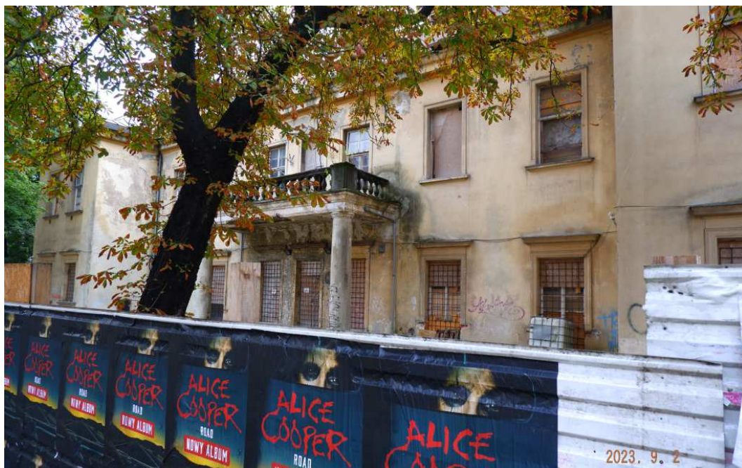
Fot. nr 277 (276-278). Fasada obiektu w oczekiwaniu na remont.
