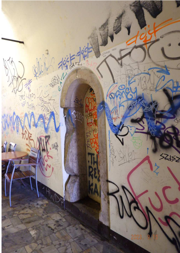
Fot. nr 41. Obramienie drzwi w zdewastowanej ścianie ciągu Pasażu Bielaka.
