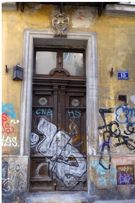
Fot. nr 100. Potwornie zniszczone eklektyczne drzwi
