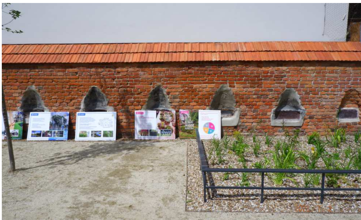
Fot. nr 62. Pozostałości po podłach dla koni na murze dawnego dziedzińca c.k. koszar.
