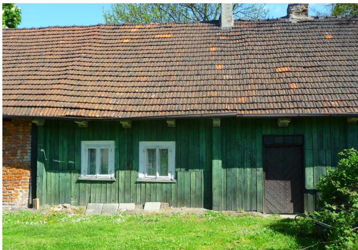
Fot. nr 504. Lewy fragment domu z nieroginalnymi już oknami. (11.05.2023)
