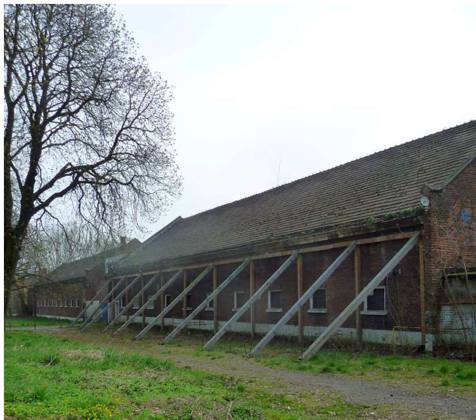
Fot. nr 372 (372-373). Popadający w ruinę dawny folwark Na Wrzosach. (10.04.2023)
