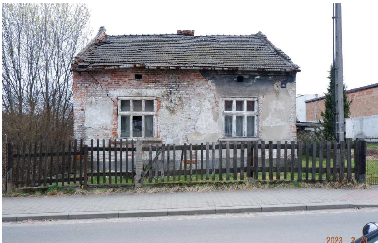
Fot. nr 395 (395-396). Kolejna ruina podmiejskiego domu, z ulicy Morawiańskiego 16.
