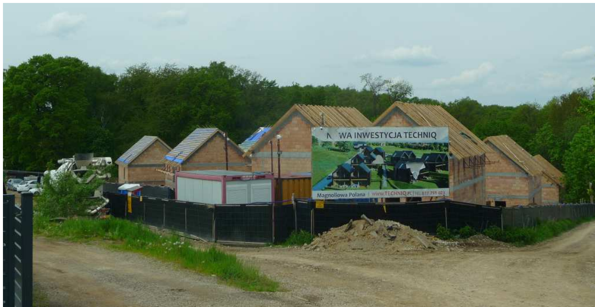
Fot. nr 605 (605-606). Fragment zabudowy przy krzyszkowickim lesie i burząca krew w (moich) żyłach nazwa betonowego blokowiska: MAGNOLIOWA POLANA. „Betonowe parki” mnożą się w Krakowie i jego okolicach jak grzyby po deszczu. (16.05.2023)
