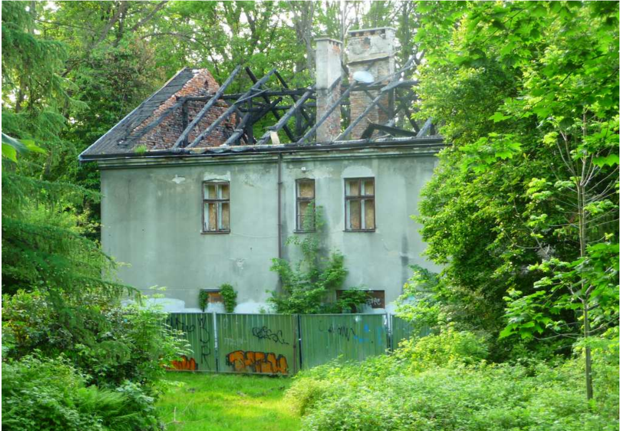
Fot. nr 264 (264-267). Stary dwór Bemów z niedawno spalonym dachem. (28.05.2023)
