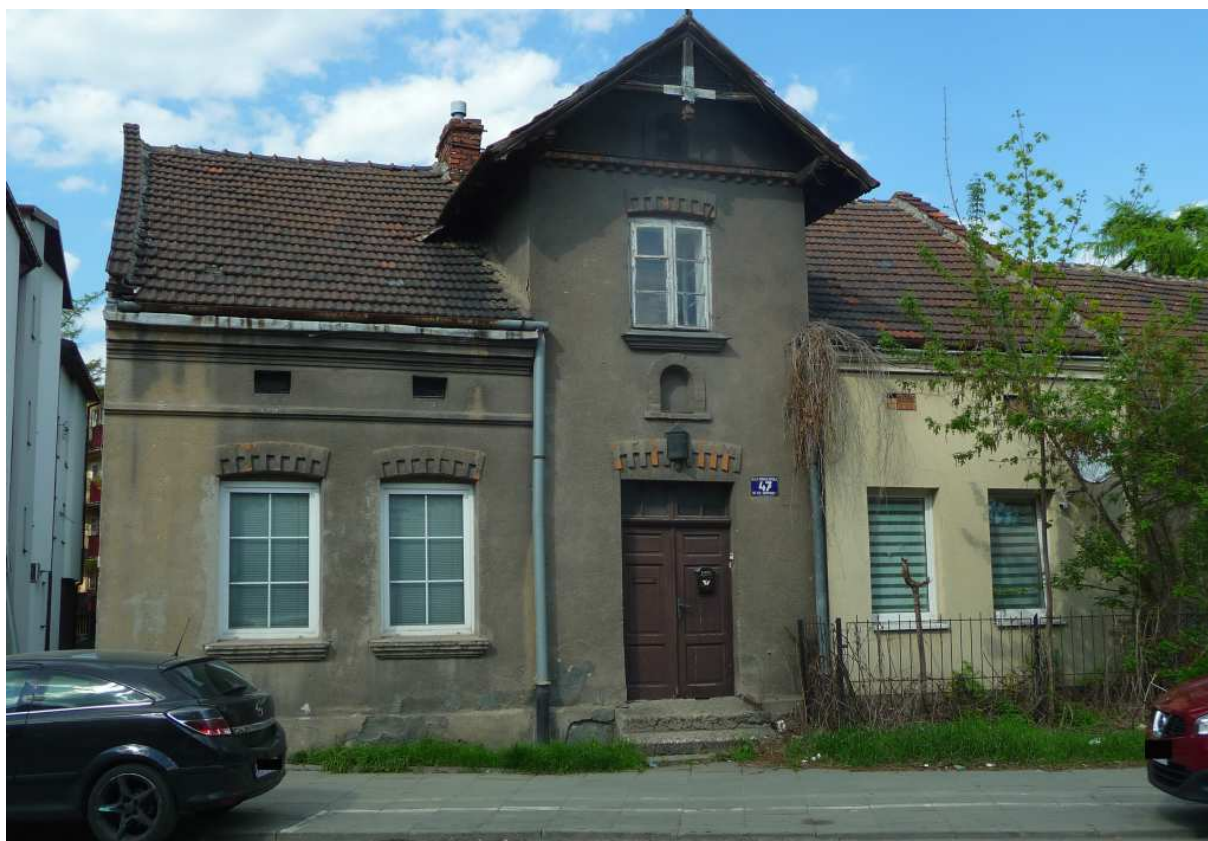
Fot. nr 248. Fasada domu pod nr 47, gdzie w parterze nie ma już oryginalnych okien. (23.04.2023)
