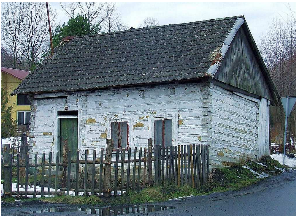
Fot. nr 353. Wiekowa chałupa z Podchybia koło Lanckorony – zdjęcie wykonane przez Łukasza Opałka (11.03.2011).
