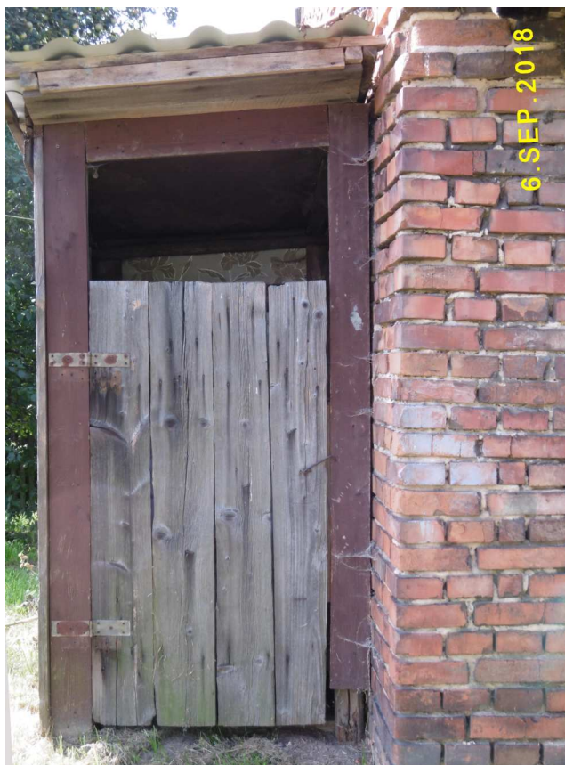
Fot. nr 203. Wspomnienie dawnego wychodka.
