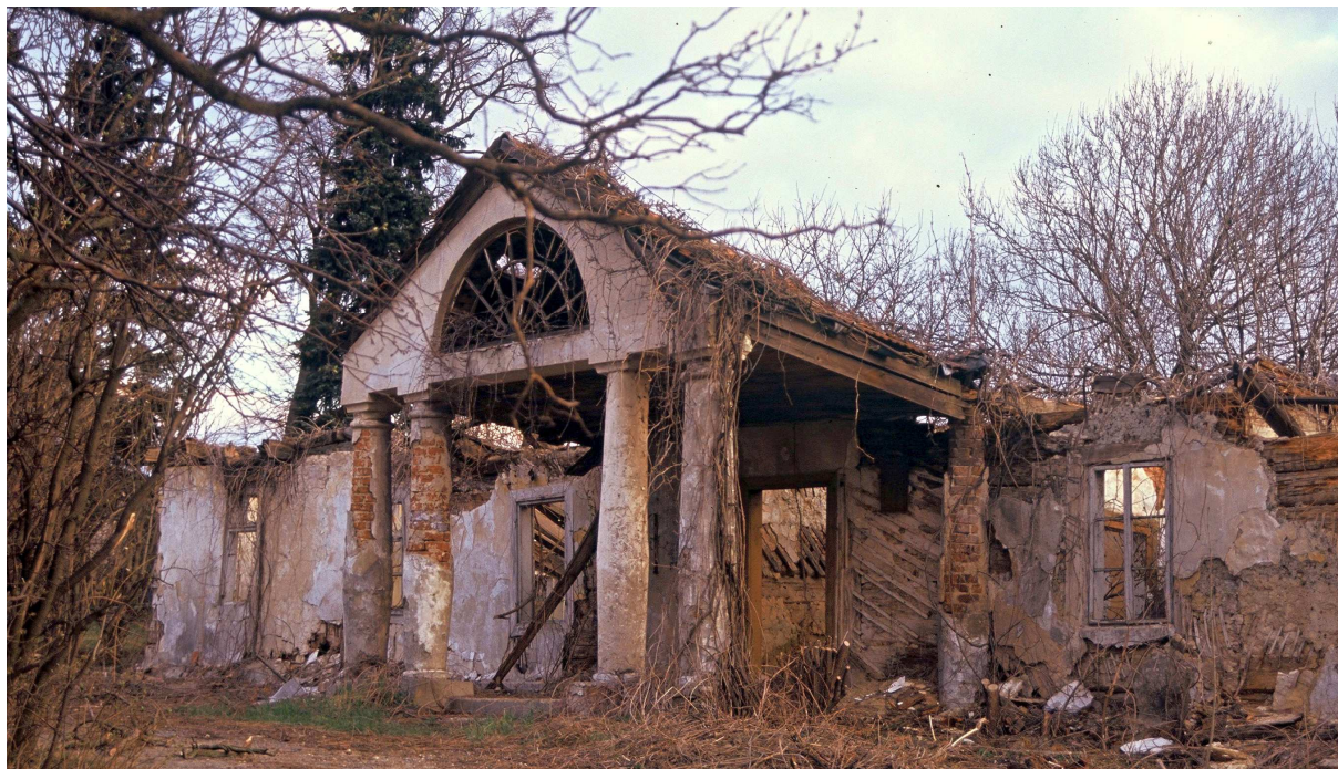
Fot. nr 263. Ruina dworu – stan z połowy lat 80. (fot. Ewa Panek). Dziś po budynku dworskim pozostała kupa gruzu.
