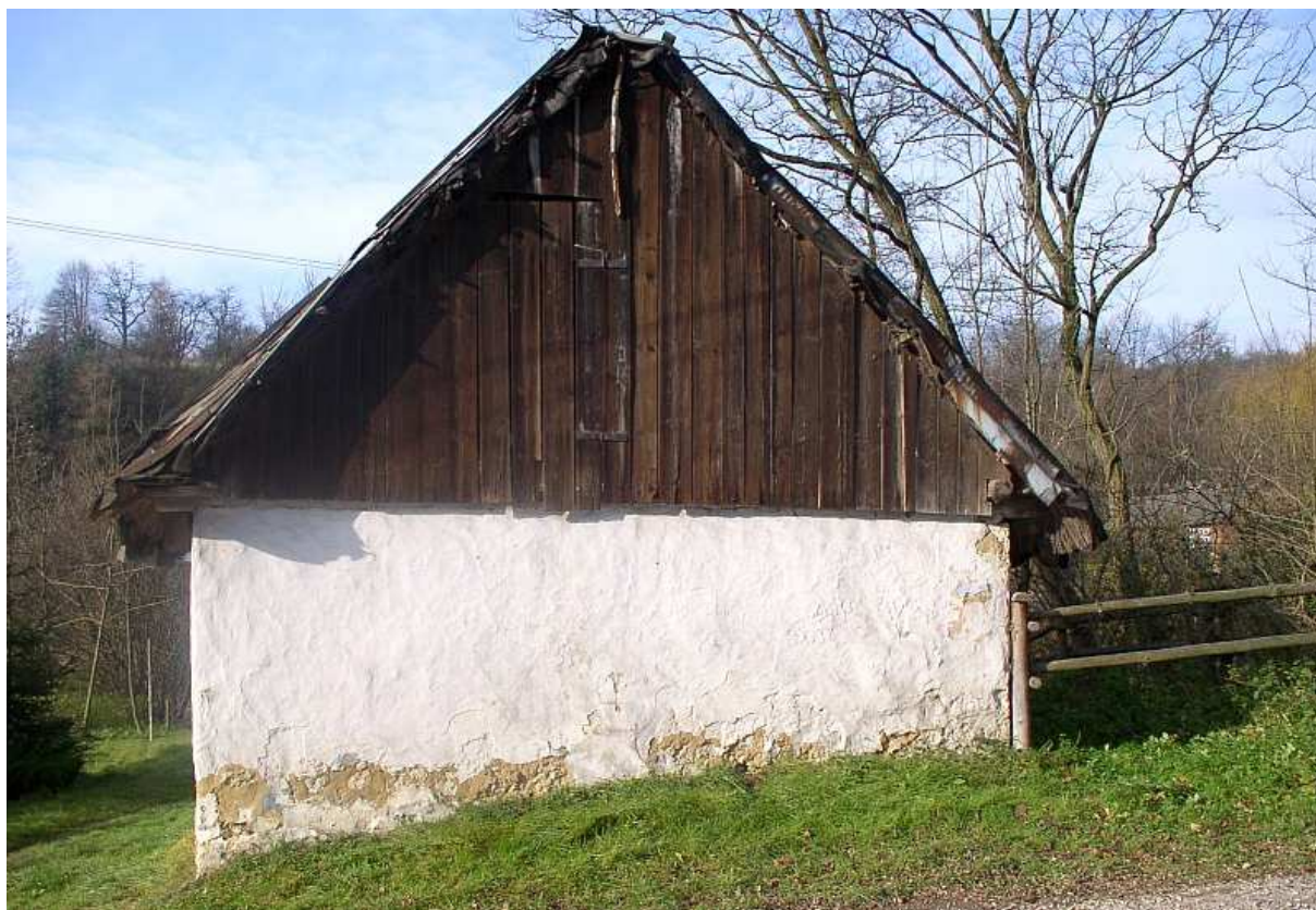
Fot. nr 251. Boczna ściana szczytowa. W prawym narożu dachu, spod pokrycia wygląda jeszcze słoma z dawnej strzechy. (11.11.2010)
