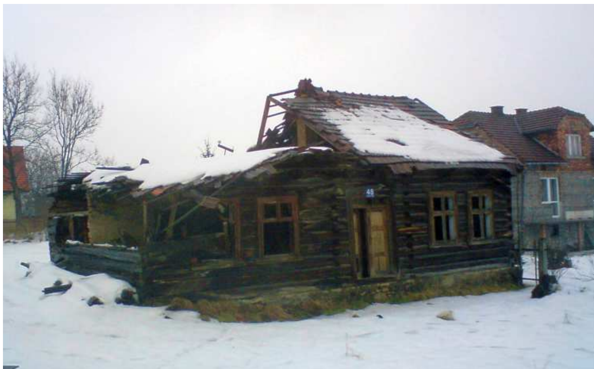
Fot. nr 218. Widok części spalonej. (11.03.2010)
