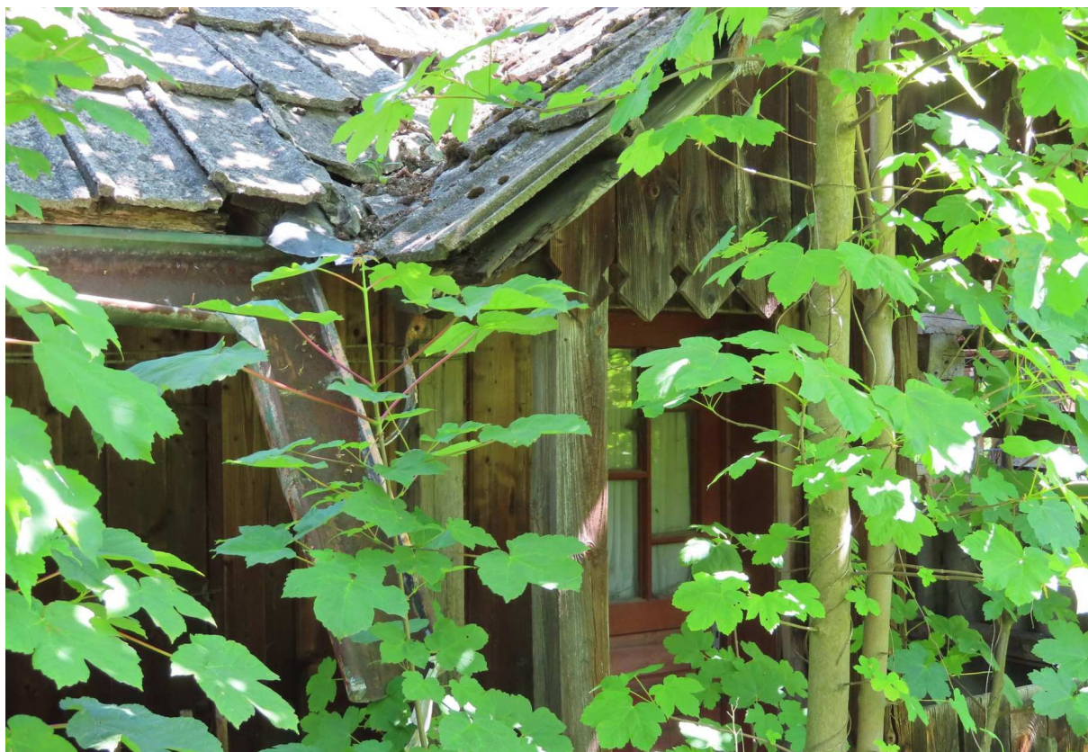
Fot. nr 243. Odkryty ganek pośrodku fasady. Można przypuszczać, że chałupa jest dwutrakowa, z przelotową sienią pośrodku. (11.06.2021)
