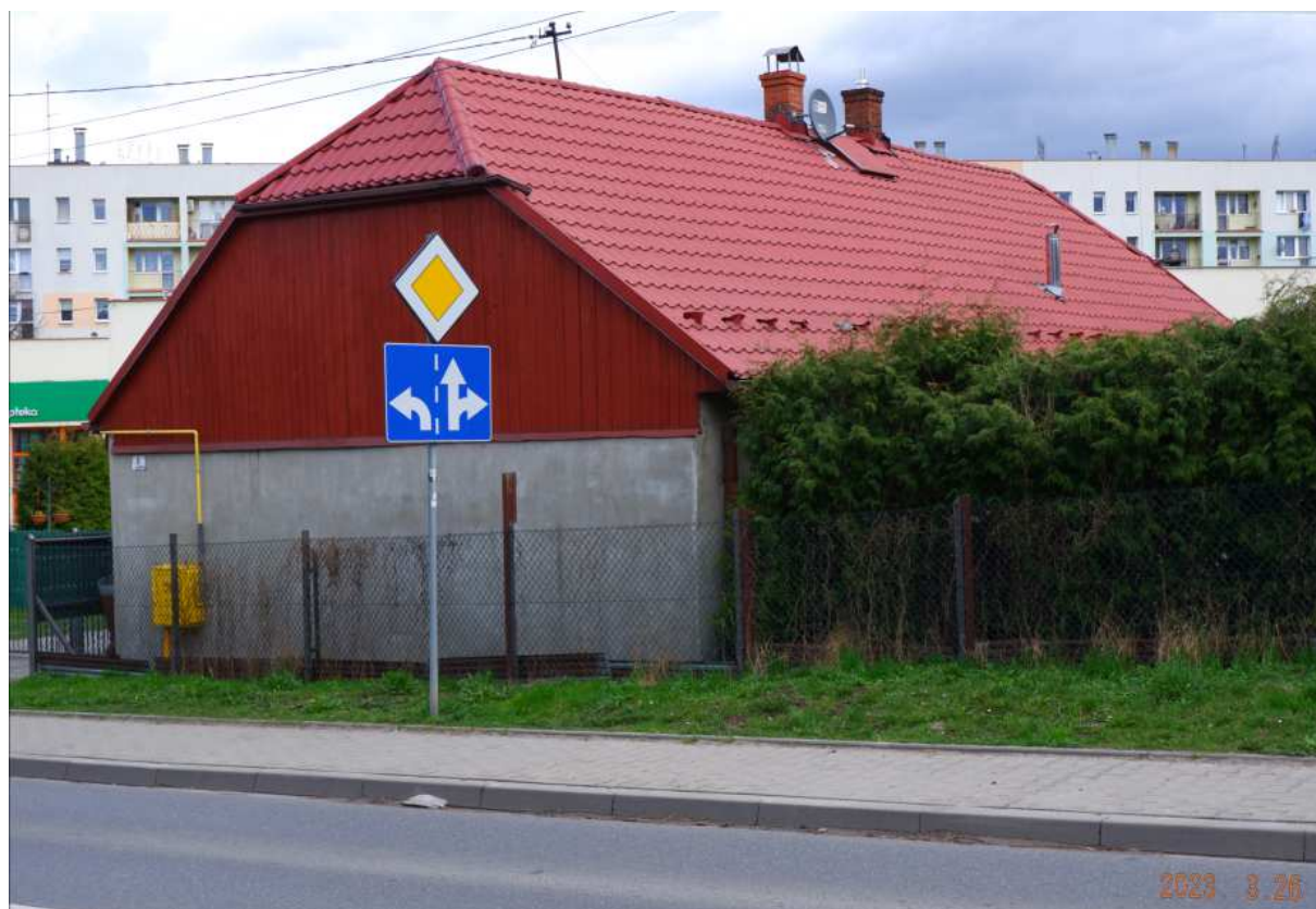
Fot. nr 278. Obudowana współcześnie i pozbawiona dawnych okien dawna chałupa z przełomu XIX i XX wieku pod nr 8. Niewiele pozostało z oryginalnych detali.
