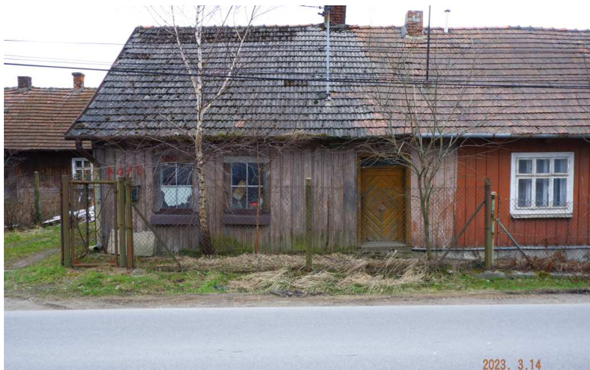
Fot. nr 463. Zaniedbane lewe skrzydło domu.
