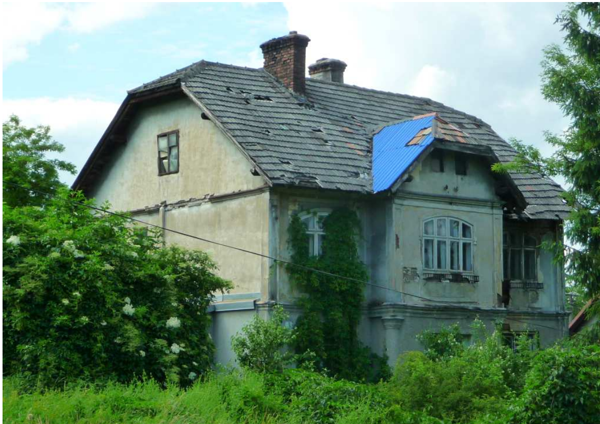
Fot. nr 128 ((128-130). Pochodzący zapewne z końca XIX wieku górniczy dom o cechach klasycystycznych spod nr 8, z zachowaną do dziś oryginalną stolarką okienną. Obiekt systematycznie podupada. (14.06.2022)
