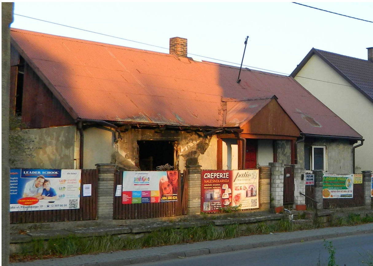
Fot. nr 239. Dom pod nr 28 po niedawnym pożarze. (29.10.2014)
