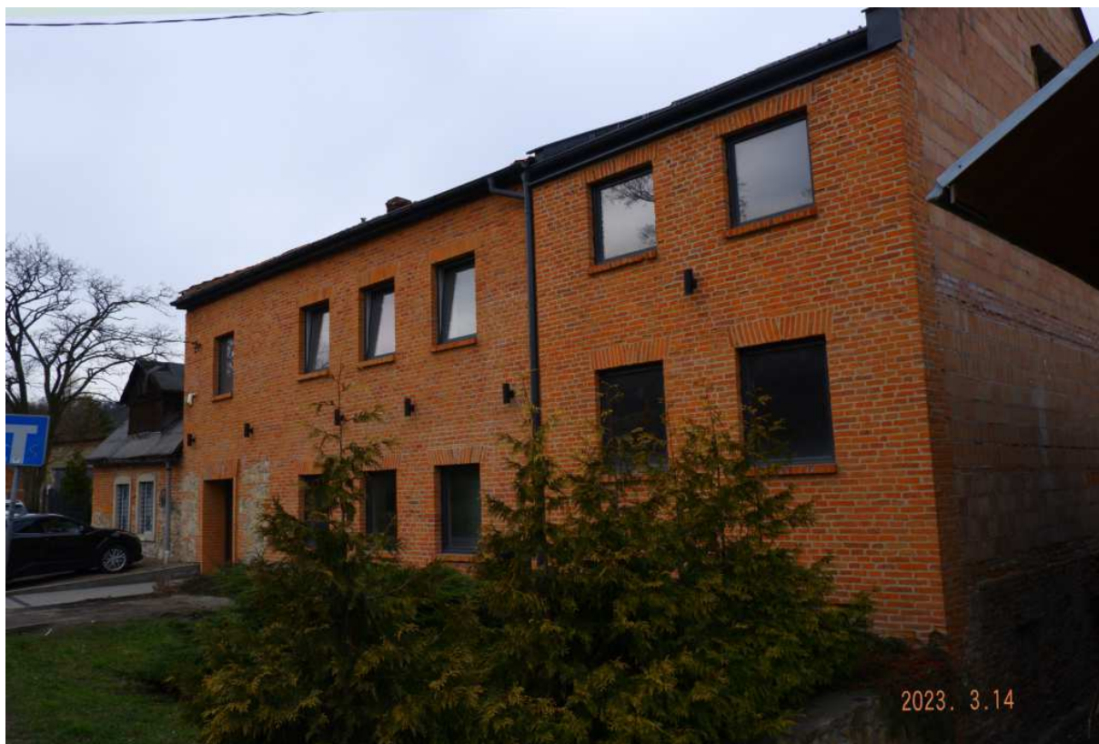
Fot. nr 392. „Zrewitalizowany” dom przy dawnym młynie pod nr 1, gdzie szczególnie rażą nowe okna..
