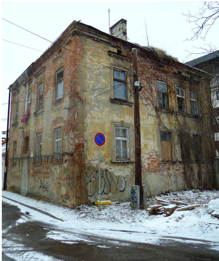
Fot. nr 129 (129-130). Ruina dawnego domu pracowników pobliskich zakładów garbarskich spod nr 16, wybudowanego w latach 30. XX wieku. (05.02.2023)
