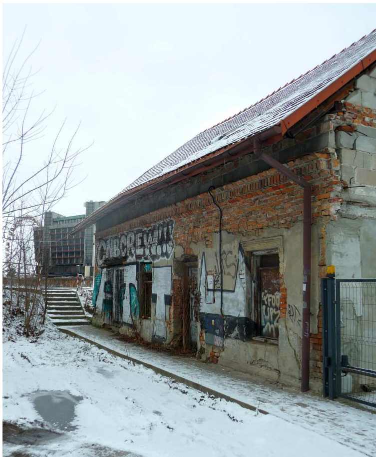
Fot. nr 138. Ruina domu o numerze 6. (05.02.2023)
