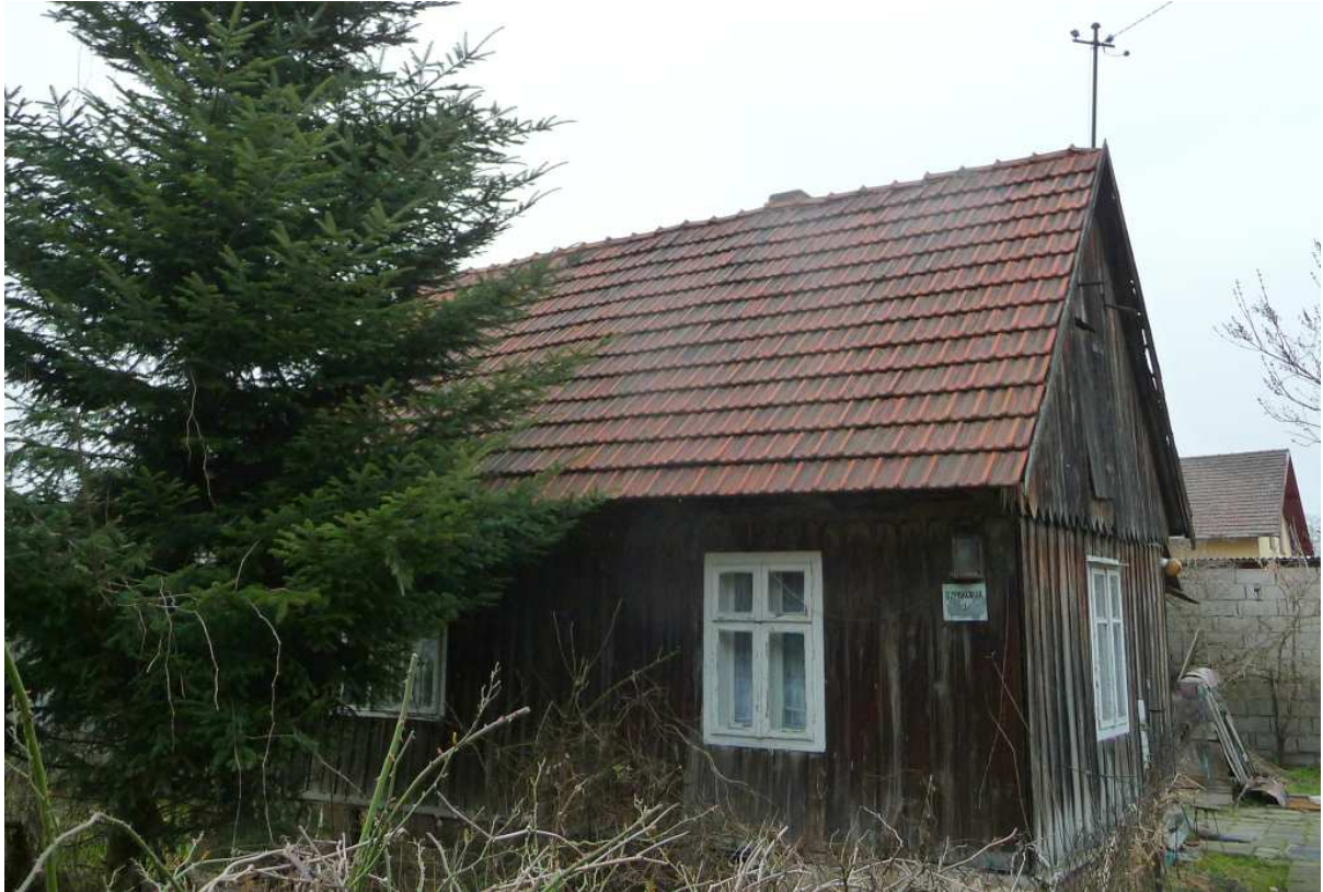
Fot. nr 393 (393-396). Dogorywająca zagroda przy ulicy Szpakowej 3. Próba uchwycenia fasady zapewne ok. 100-letniego domu. (05.03.2023)
