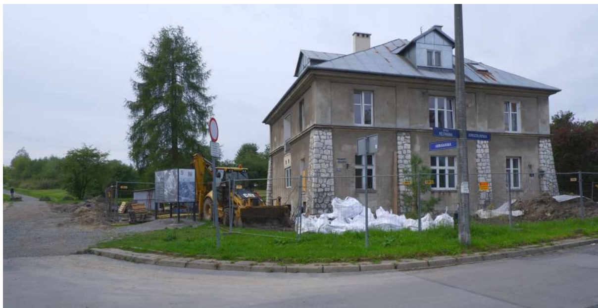
Fot. nr 289 (289-291). Remontowany, dawny budynek administracyjny przy nowym podgórnym kirkucie przy ulicy Jerozolimskiej 3, powstały w okresie międzywojennym, który w czasie istnienia KL Płaszów był siedzibą ss-manów i lokalną katownią. (24.09.2022)
