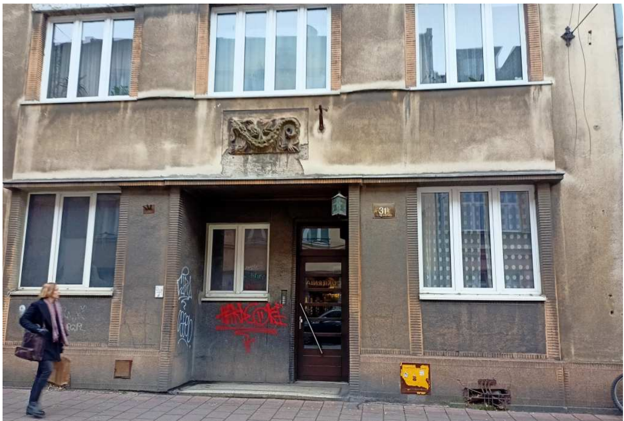
Fot. nr 182. Detale kamienicy pod nr 31b, która powstała w roku 1937 wg projektu Leona Libermana. (01.12.2022)
