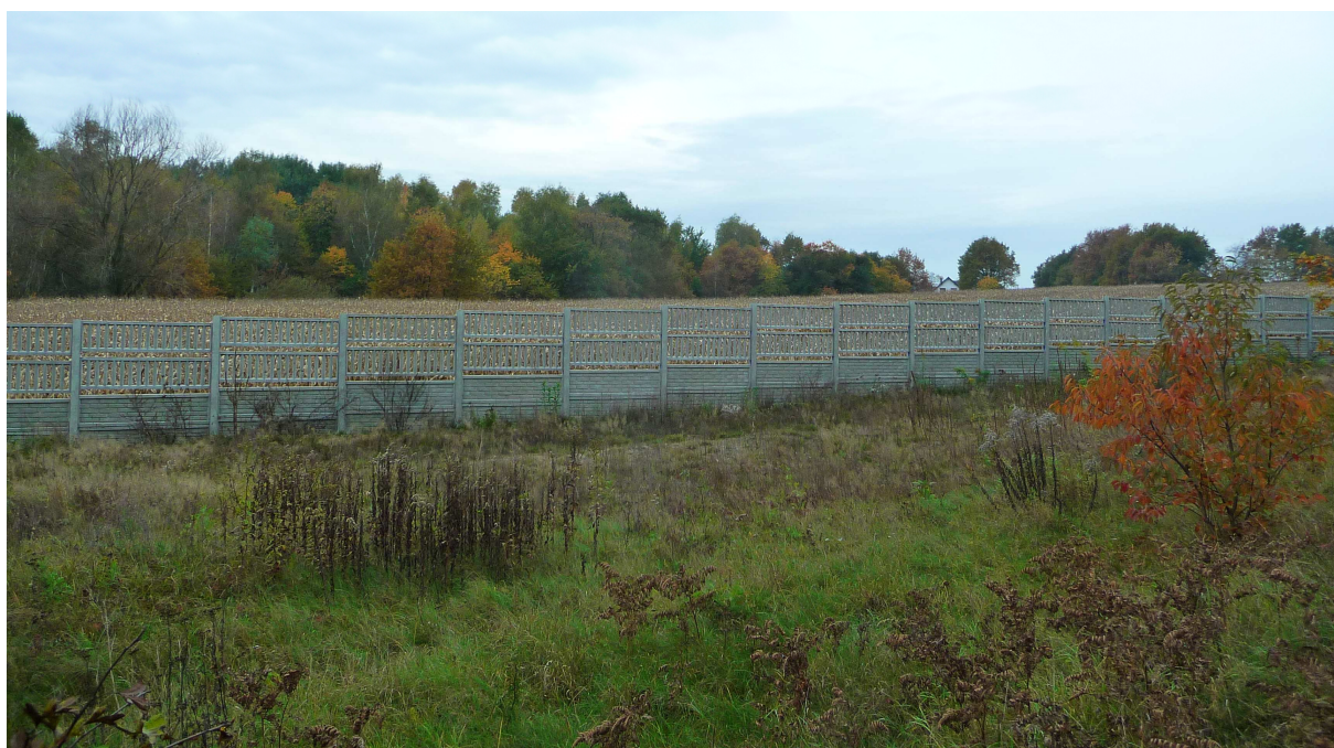
Fot. nr 399 (399-401). Betonowe ogrodzenie od strony ulicy Kostaneckiego, w którym coraz częściej pojawiają się liczne wyłamania. (22.10.2022)
