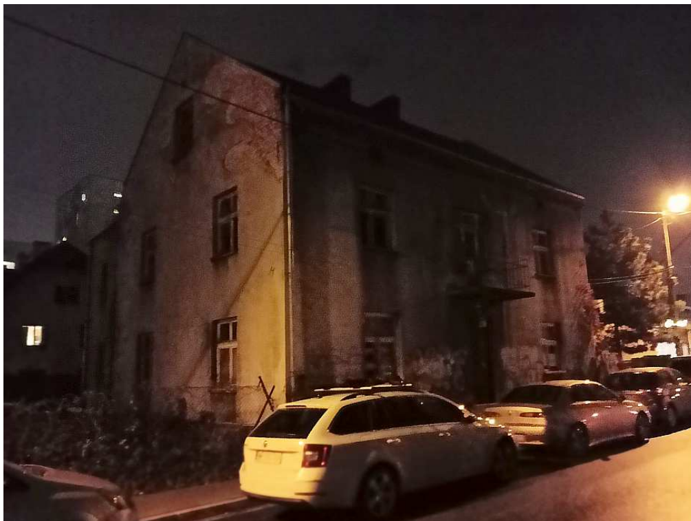
Fot. nr 173 (173-174. Opuszczona od lat kamieniczka pod nr 4. (10.11.2022)
