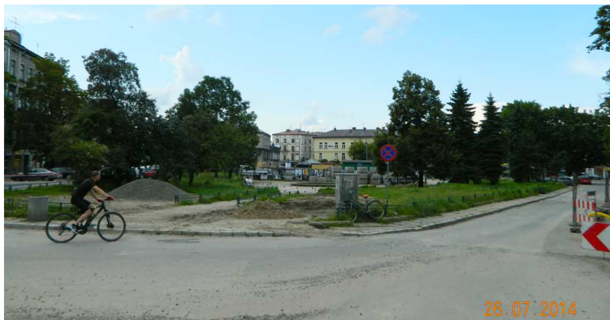
Fot. nr 100 (100-102). Rynek Podgórski w trakcie przebudowy – widoki spod kościoła św. Józefa.
