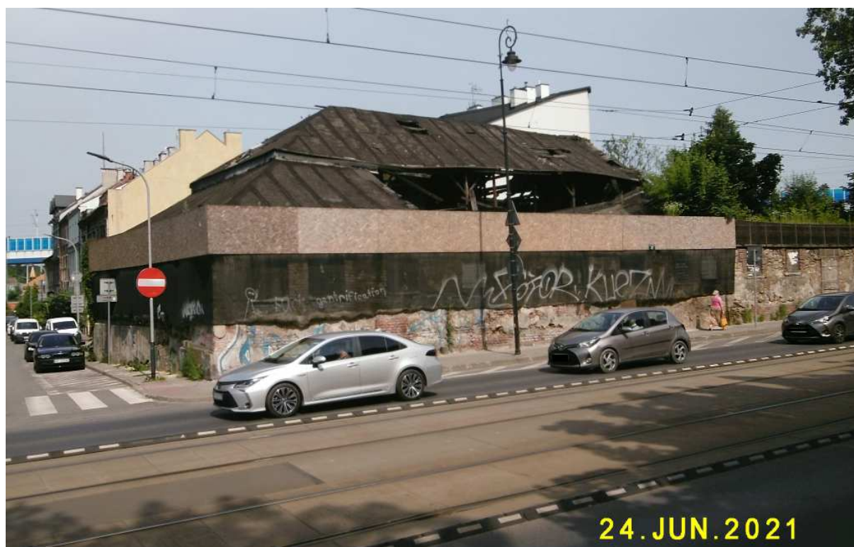
Fot. nr 359. W roku 2021 stan dworku zdegradowanego po pożarze był już tragiczny.
