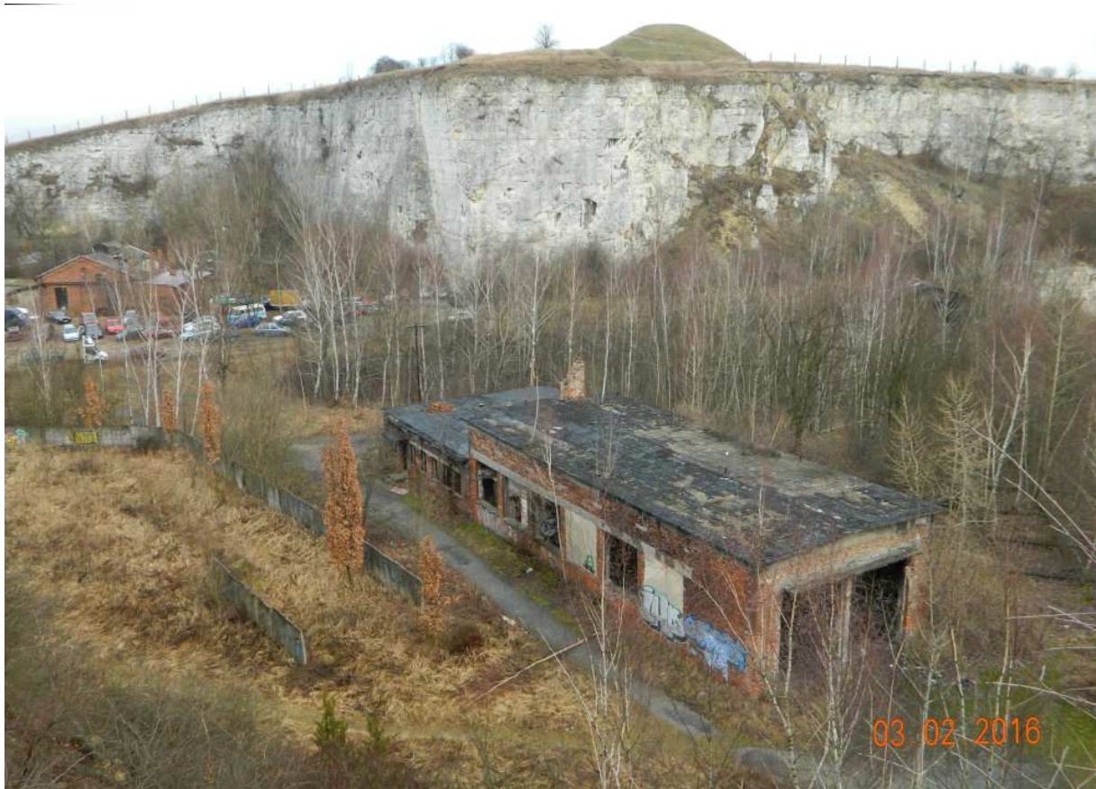
Fot. nr 548 (548-551). Ruina innego budynku z terenu dawnego kamieniołomu Libana, usytuowanego przy instalacji przeróbki mechanicznej wapienia na kruszywo.
