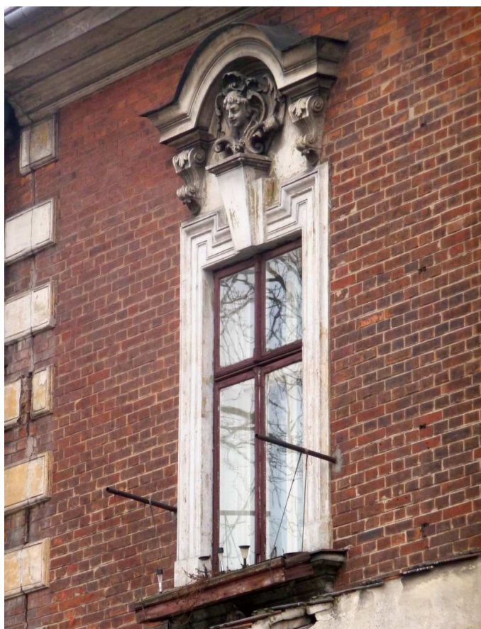
Fot. nr 439. Jedyne oryginalne okno. (27.02.2014)
