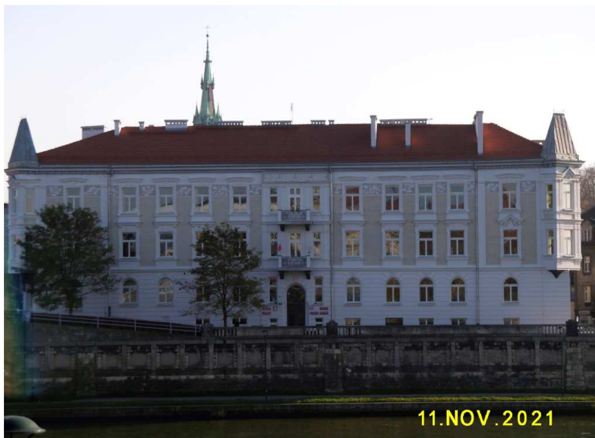
Fot. nr 264 (264-266). Odnowiona kamienica Aleksandrowiczów, gdzie po renowacji doszło jednak do uszkodzenia oryginalnych detali, m.in. szklistej glazury cegieł.
