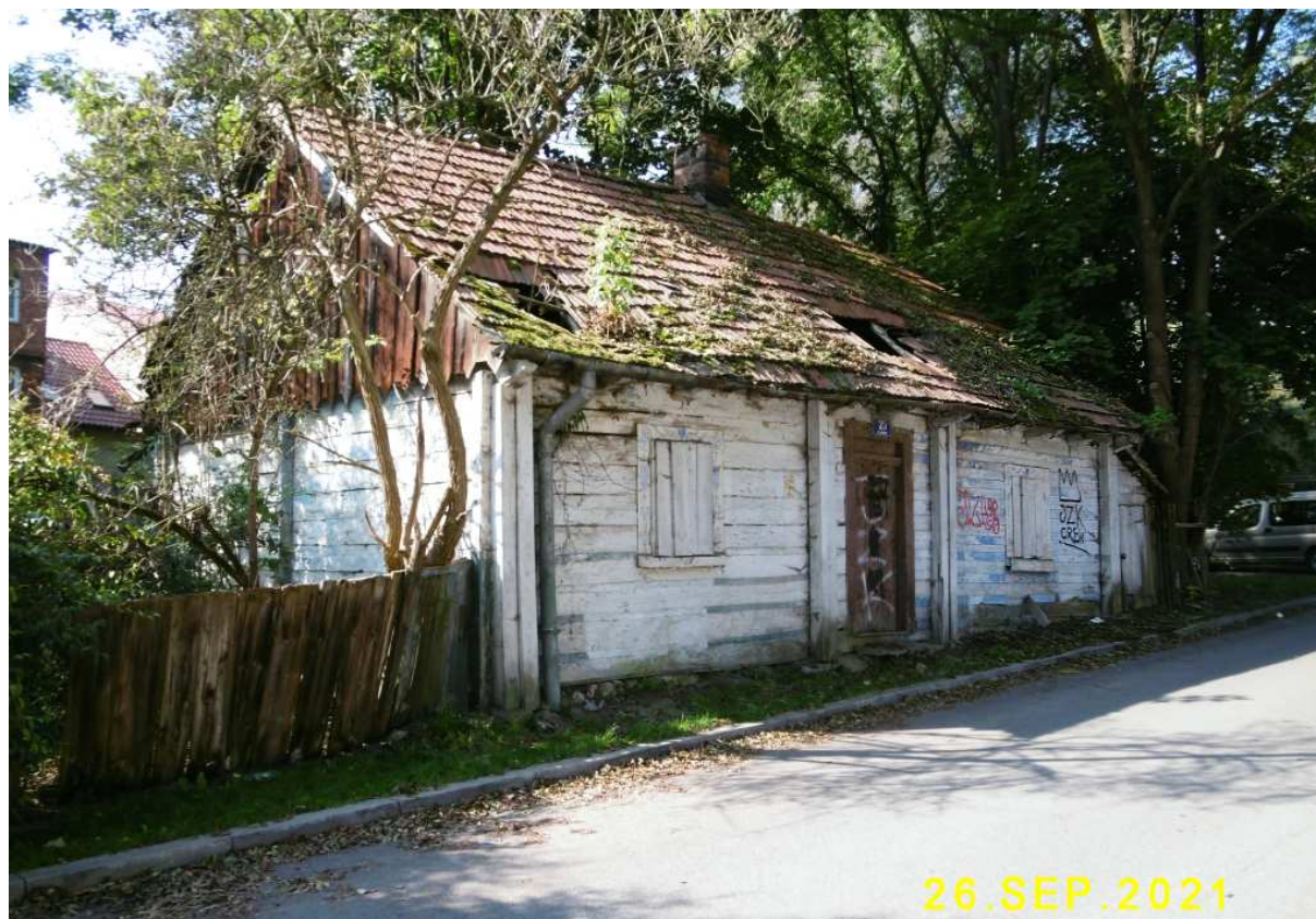
Fot. nr 350 (350-351). Chałupa z roku 1912 spod nr 25. Z uwagi na zły stan techniczny nie jest brana pod uwagę pod kątem przeniesienia do krakowskiego skansenu.
