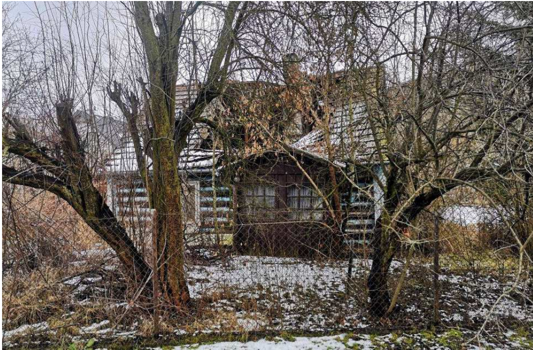
Fot. nr 1a. Niewielka chatka z ulicy Chelmskiej 17 miała wielkie szanse na translokację do nowo powstającego w Branicach skansenu. Niestety czas okazał się dla niej okrutny – pod koniec roku 2020 zawalił się w niej dach i cenny antyk popadł w całkowitą ruinę. Zdjęcie z lutego roku 2021.
