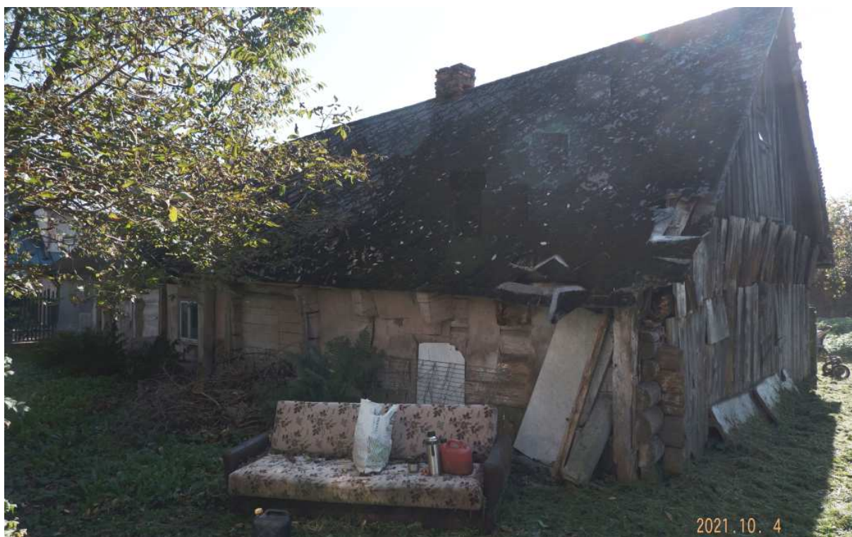
Fot. nr 312 (312-314). Wybudowana w roku 1838 chałupa przy ulicy Na Błonie 27. Z uwagi na zły stan techniczny nie trafi do krakowskiego skansenu.
