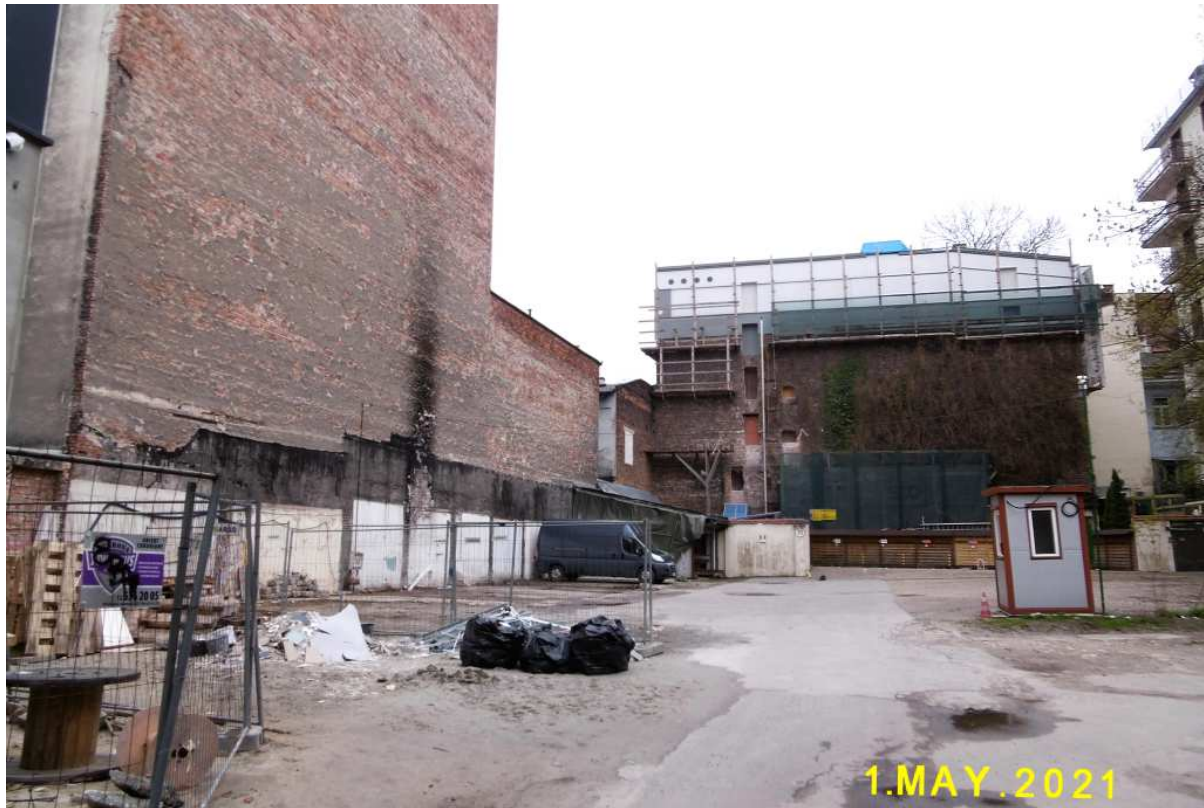
Fot. nr 122. Nie ustają prace budowlane na rozległym, w większości jeszcze zielonym podwórku, ograniczonym zabudową ulic: Karmelickiej 13-17 i Garbarskiej 18-26.
