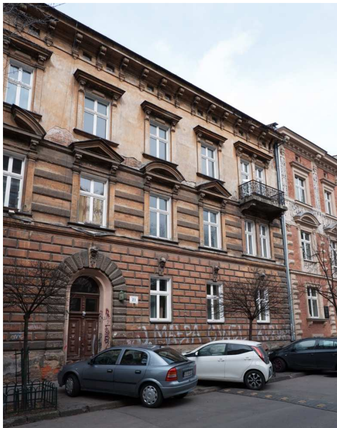
Fot. nr 248. Kamienica pod nr 21, która czeka na remont elewacji. (14.03.2021)
