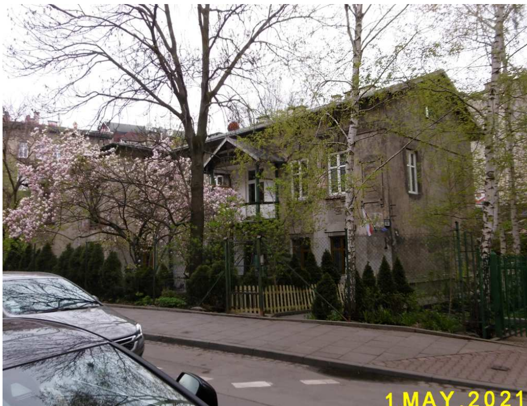
Fot. nr 140 (140-146). Ciągłe mocno zaniedbana willa z ulicy Kochanowskiego 15/Grabowskiego 12, związana z rodziną architekta Bujasa.
