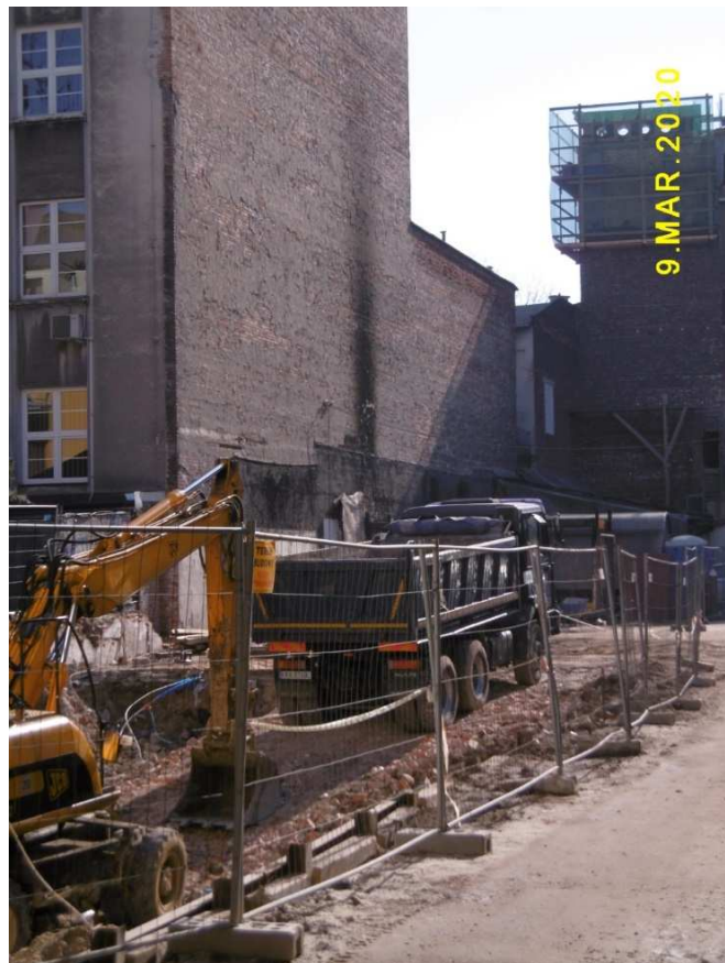
Fot. nr 65. Tyle pozostało po klimatycznej oficynie z adresem: ulica Karmelicka 13.
