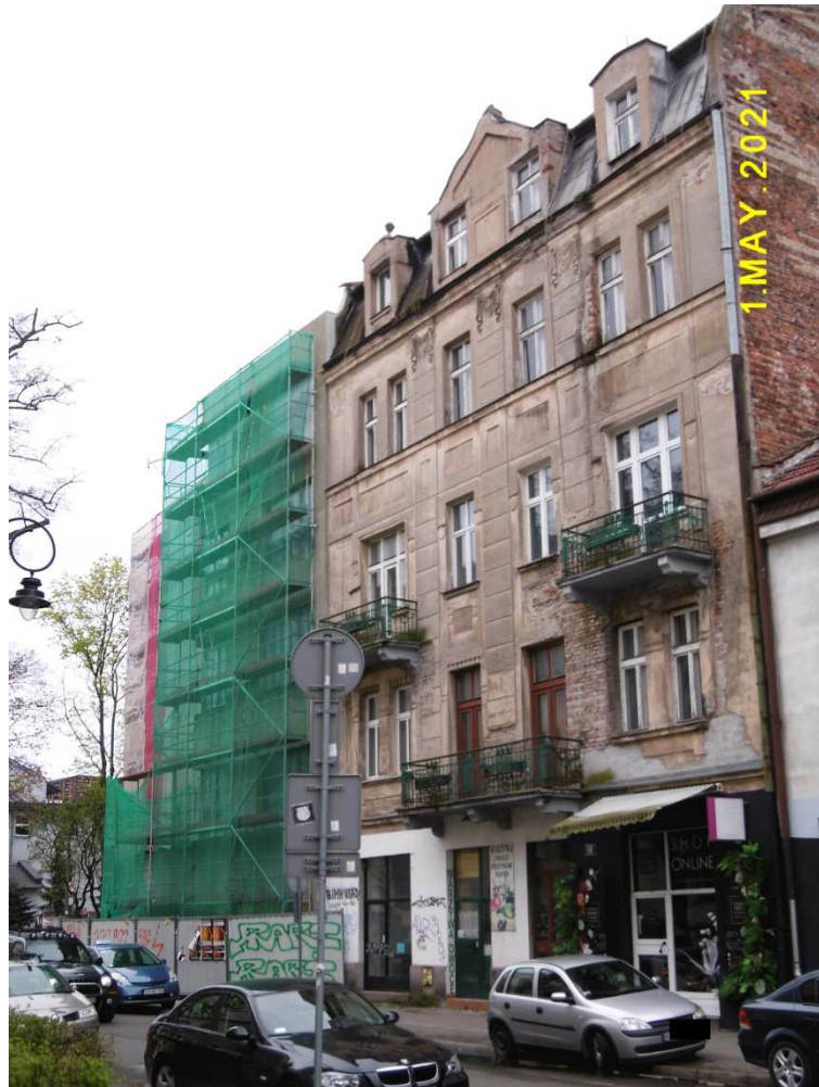
Fot. nr 148 (148-149). Kamienica pod nr 20 na etapie przed planowanym remontem.
