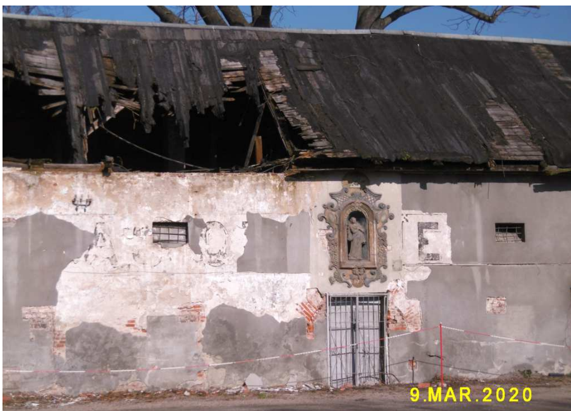
Fot. nr 79 (79-80). Jaki los czeka tą rokokową figurę wbudowaną w ścianę walącego się budynku?
