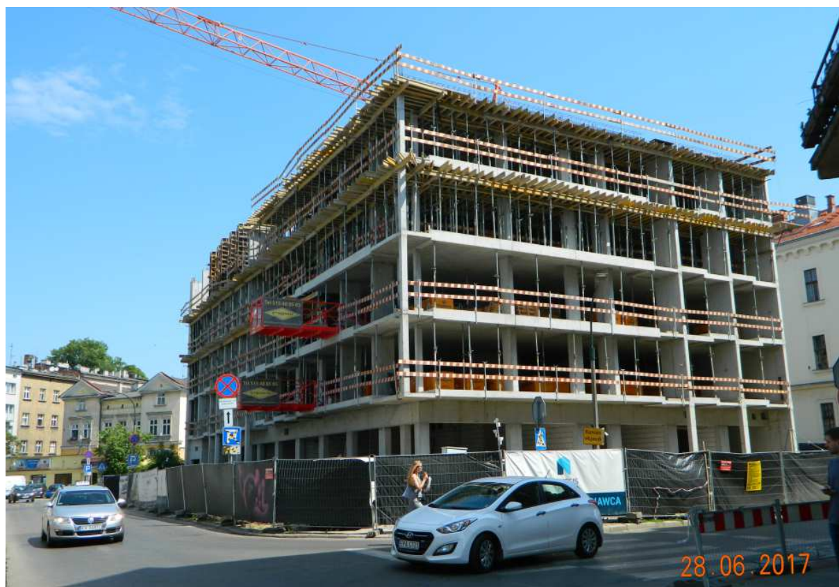
Fot. nr 240 (240-245). Przewymiarowane betonowe blokowisko z ulicy Dolnych Młynów 11 (róg z Rajską), które powstaje w miejscu dawnego, dwupiętrowego lazaretu przy c.k. koszarach. Tak zdaniem WKZ wygląda „powrót do zabudowy tej ulicy z lat 50-tych”.
