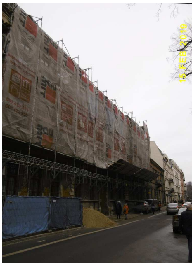
Fot. nr 430 (430-433). Ulica Krupnicza. Tu remont i rozbudowa kamienicy pod nr 11a.
