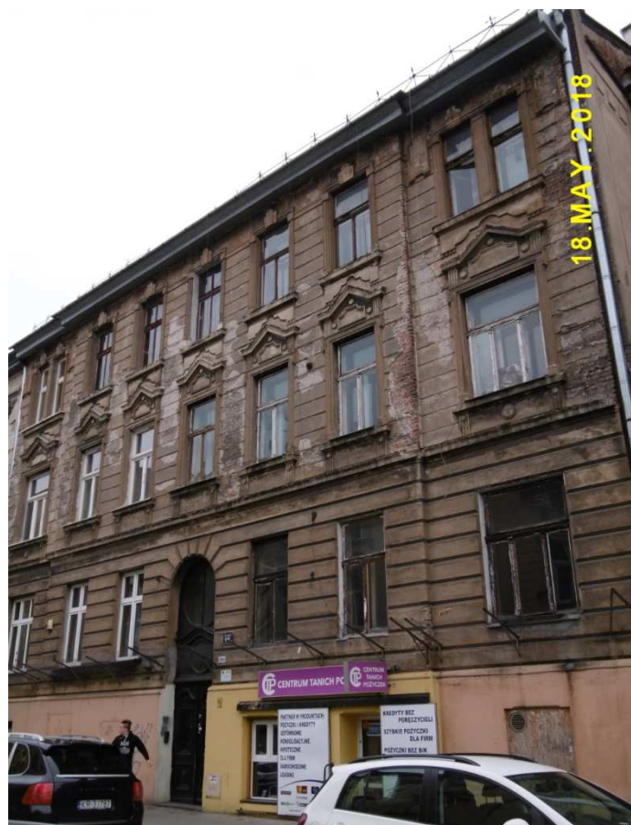
Fot. nr 345. Równie dramatycznie zaniedbana fasada kamienicy pod nr 16.
