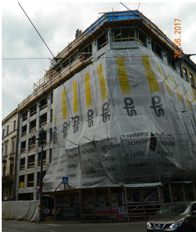
Fot. nr 187 (187-189). Betonowy szkielet przewymiarowanej kamienicy z naroża ulic: Piłsudskiego 1 i Straszewskiego 24, która powstaje w miejscu piętrowego budynku dawnej „Barcelony”. W okresie międzywojennym funkcjonował tam szynk H. Goldmanna.
