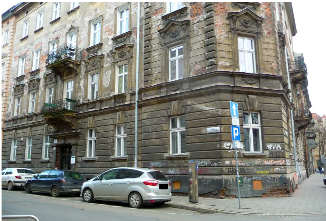
Fot. nr 309. Odrapana kamienica z naroża ulic: Studenckiej 8 i Loretańskiej 10. (05.02.2018)
