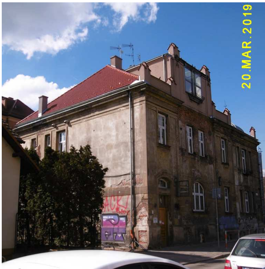
Fot. nr 475. Ciągłe zaniedbana secesyjna willa z ulicy Czarnowiejskiej 8.
