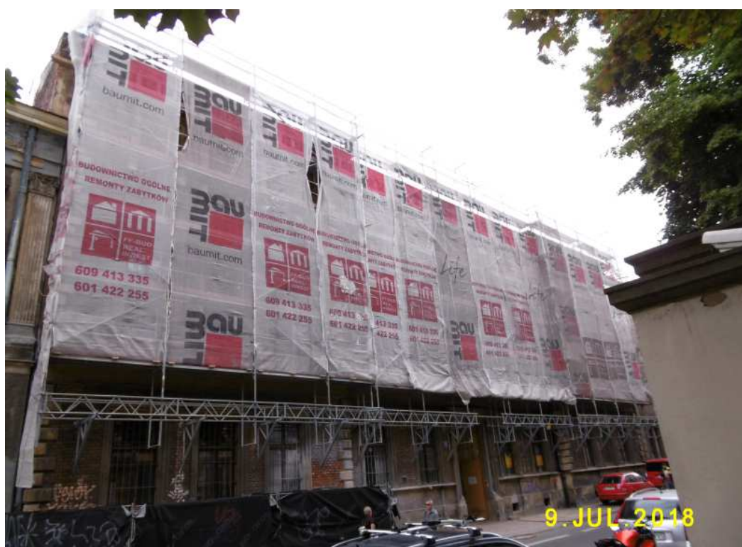
Fot. nr 380 (380-381). Kamienica spod nr 11A na etapie remontu i dobudowania oficyny.
