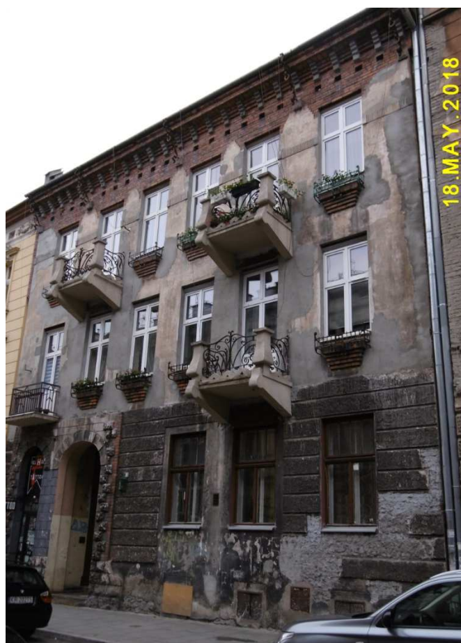
Fot. nr 344. Mocno zniszczona fasada kamienicy pod nr 19.
