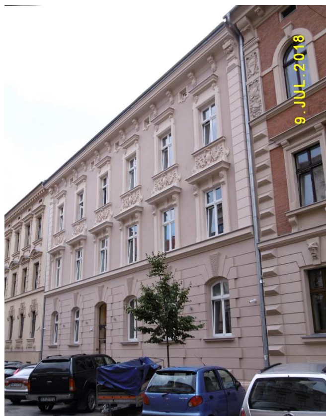
Fot. nr 390 (390-391). Kolejny przykład wzorcowej wręcz odnowy elewacji, ale też wnętrza. To dawna kamienica Zollów ze Studenckiej 25 po przeróbce na apartamentowce.
