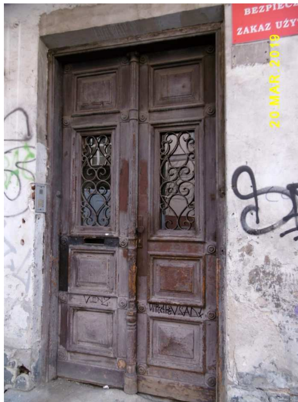
Fot. nr 492. Drzwi jeszcze do uratowania.
