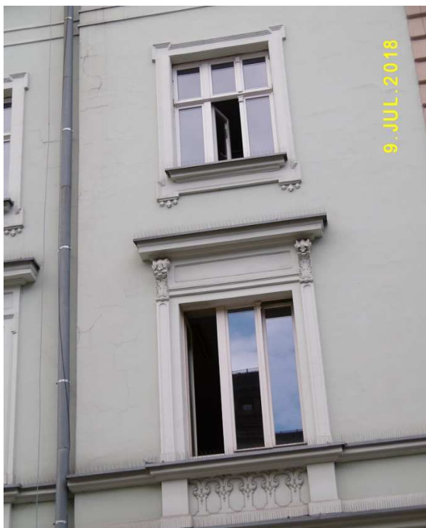
Fot. nr 385. Przykład wyjątkowego niechlujstwa ze strony wykonawców i dozoru.
