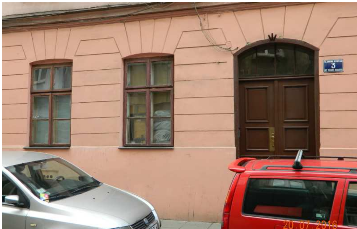
Fot. nr 140. Oryginalne okna kamienicy z ulicy Meiselsa 3, jeszcze z cienkimi szprosami.
