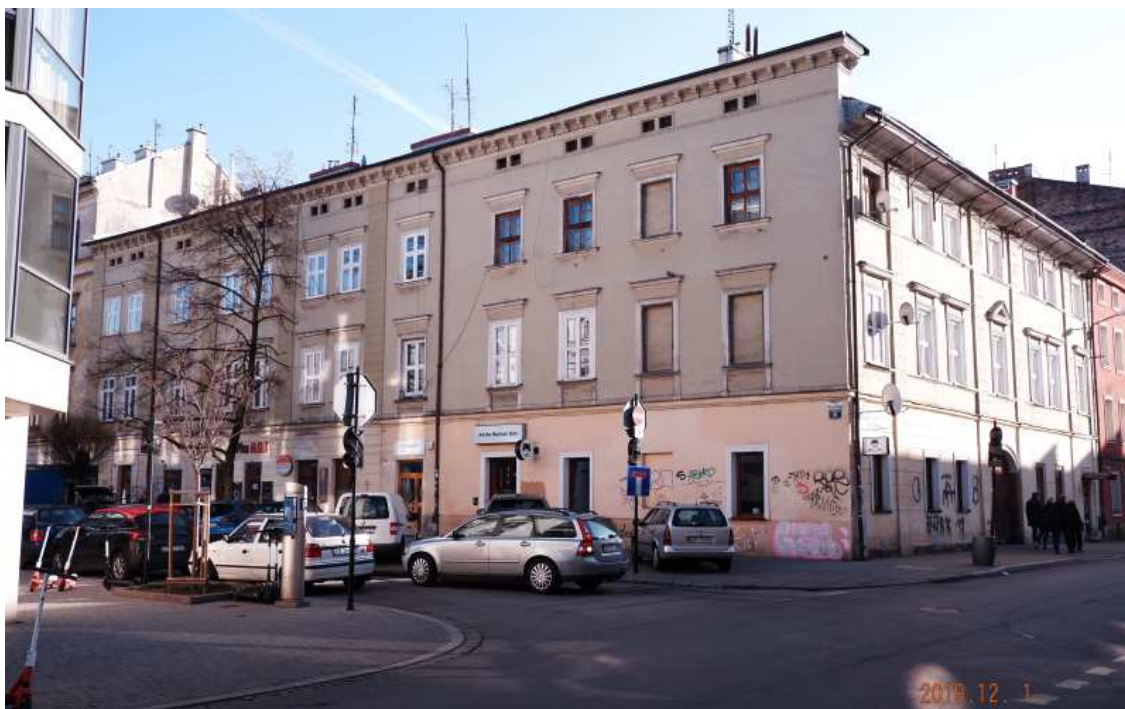
Fot. nr 392. 200-letnia kamienica z naroża ulic: Augustiańskiej 26 i Węglowej 4, której nieuporządkowana fasada budzi niesmak.
