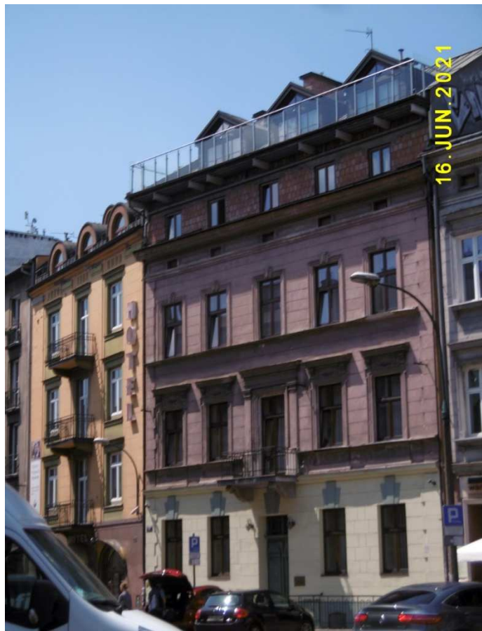
Fot. nr 454. Kamienica pod nr 16 i jej nielegalna nadbudowa.
