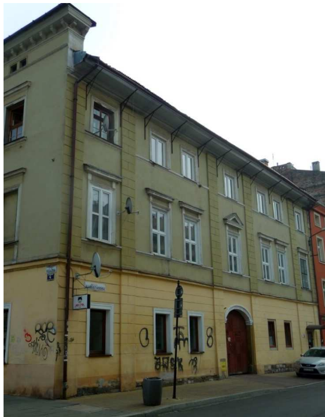
Fot. nr 320. Blisko 200-letnia kamienica w narożu ulic: Augustiańskiej 26 i Węglowej 4, gdzie oryginalne okna zastąpiły już chaotyczne, plastikowe podróbki. (07.11.2018)
