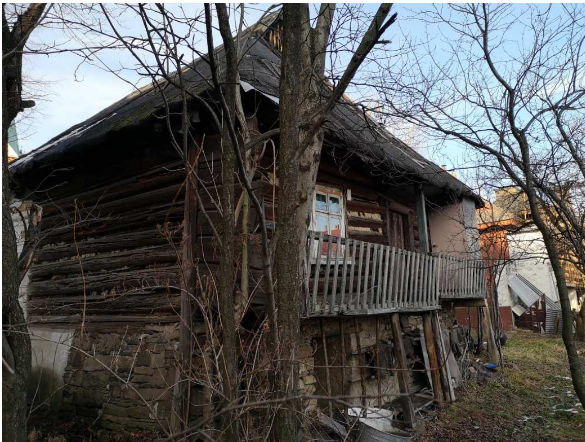
Fot. nr 433. Widok na tylną część.
