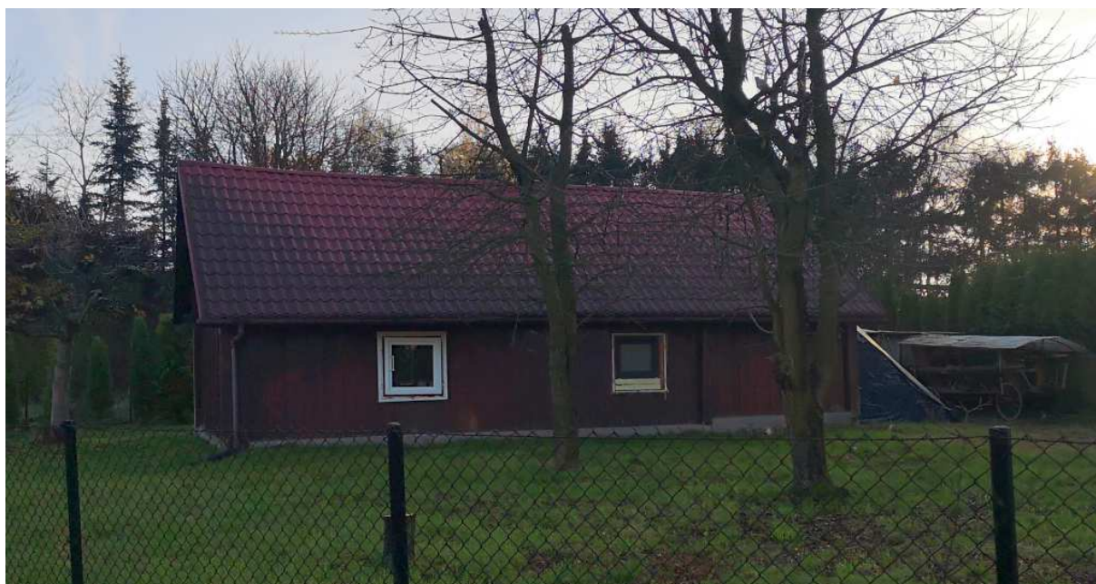
Fot. nr 48 (48-49). Mocno zniekształcona fasada starej chałupy z ulicy Szkolnej 84.
