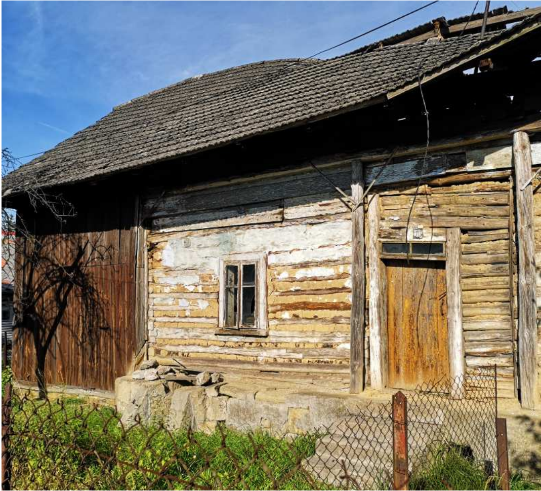
Fot. nr 277. Widok z częściowo już zawalonym dachem we wrześniu 2020.
