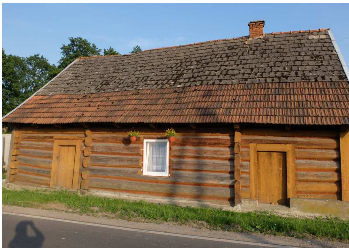
Fot. nr 142. Część chałupy pod nr 75 w ujęciu od strony ulicy. Oryginalne okno zastąpił już bezpodziałowy „plastik”.
