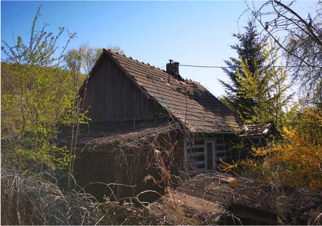
Fot. nr 91 (91-92a). Wybudowana zapewne w okolicy przełomu XIX i XX wieku skromna chatka z ulica Chełmskiej 17, w której na początku roku 2021 zawalił się dach, co najwyraźniej oznacza jej koniec. (30.04.2020)
