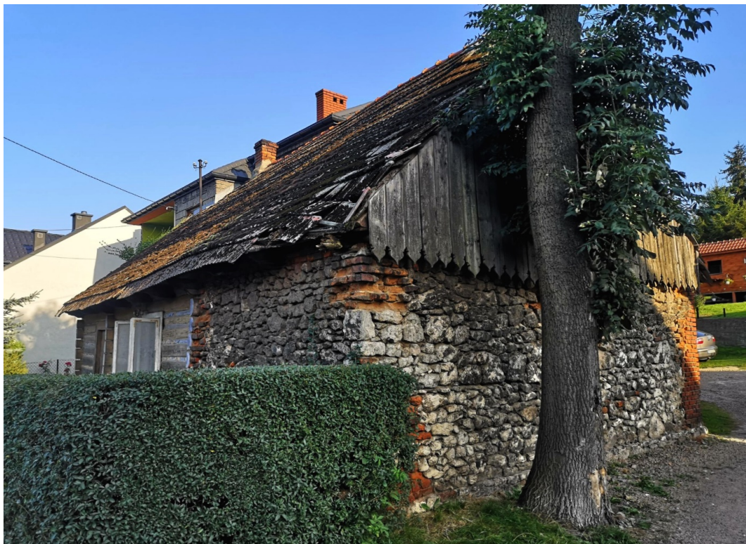
Fot. nr 172 (172 -175). Skromna chatka drewniana spod nr 63, z dobudowaną do niej z kamieni wapiennych częścią gospodarczą i jej detale.
