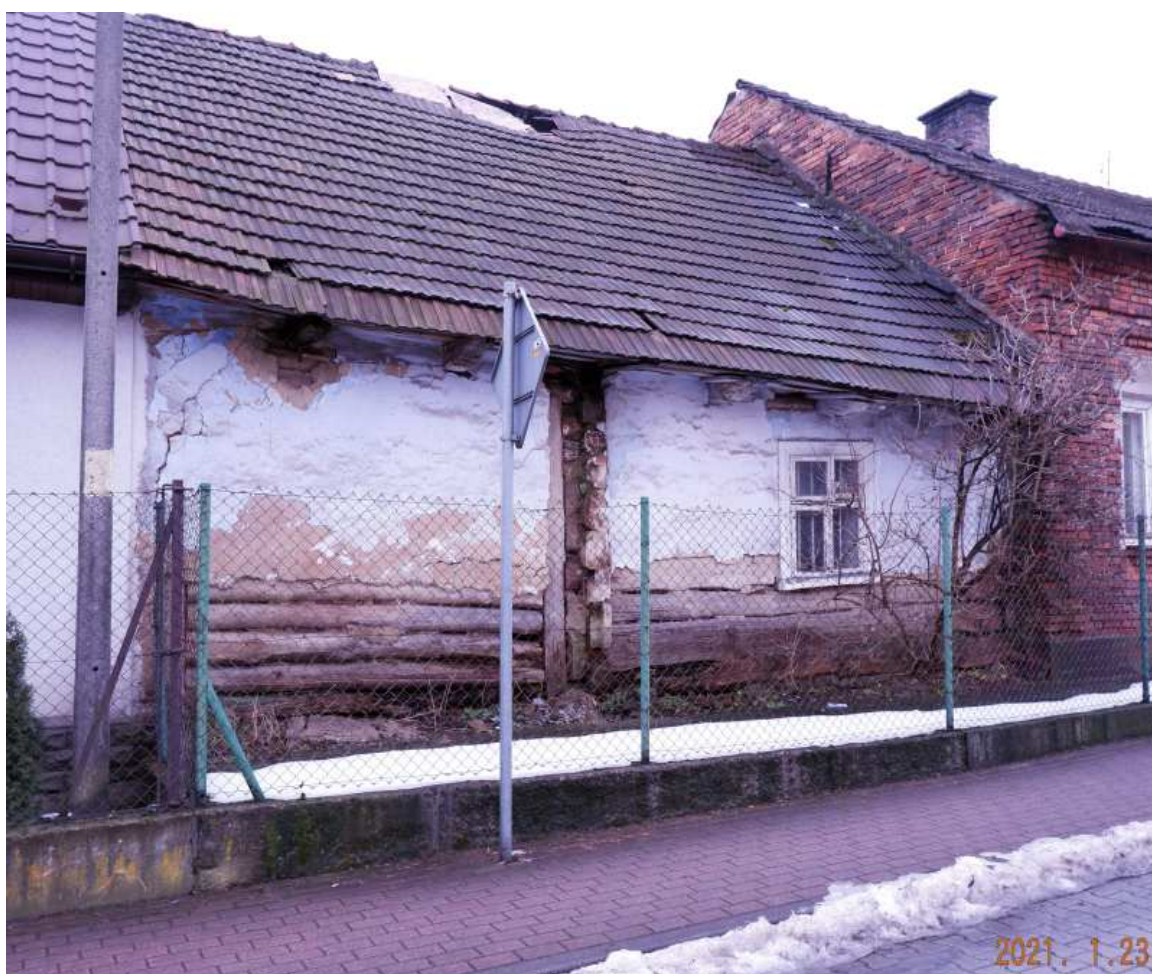
Fot. nr 495 (495-495a). Frontowa ściana niszczejącej od lat chałupy z ulicy Kijanki 28, która mogła powstać na przełomie XIX/XX wieku.
