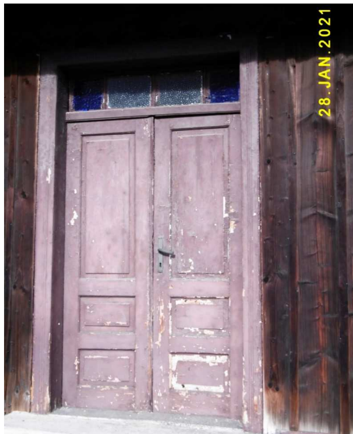
Fot. nr 479. Drzwi zoryginalnym świetlikiem w zwieńczeniu, który jest wypełniony kolorowymi szybkami.
