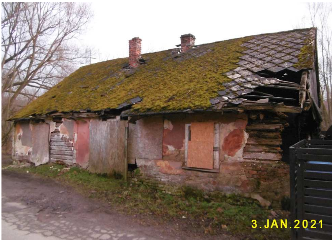
Fot. nr 316. Dogorywający od lat drewniany dom z ulicy Mokrej 26. Od strony ogrodu posiada on odsłonięty ganek, ale nie sposób tam dotrzeć.
