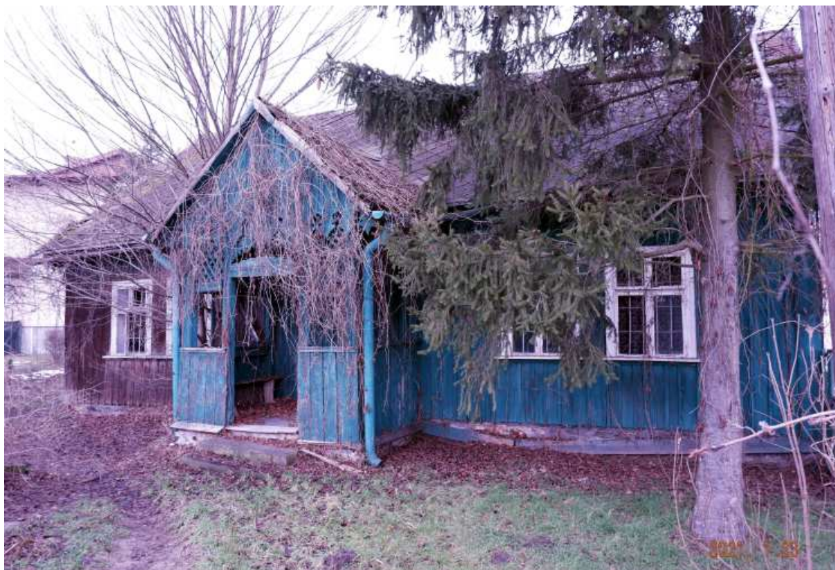
Fot. nr 460 (460-461). Fasada oszalowanego domu, z profilowanym gankiem i oknami typu ościeżnicowego. Obiekt mógł powstać w okolicy przełomu lat 20/30. Dom niszczeje od lat.
