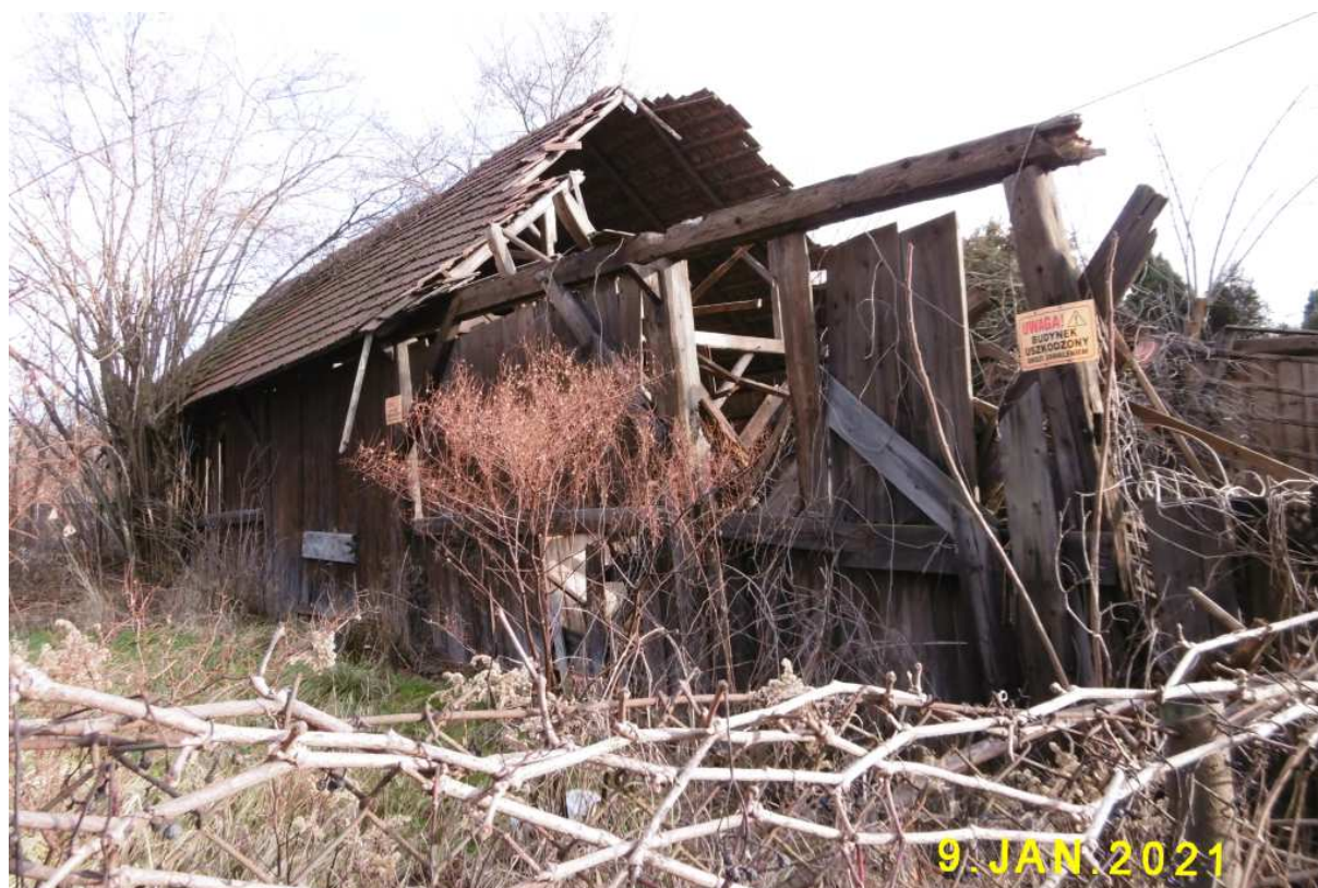
Fot. nr 353 (353-355). Postępująca agonia starej stodoły na posesji pod nr 13.
