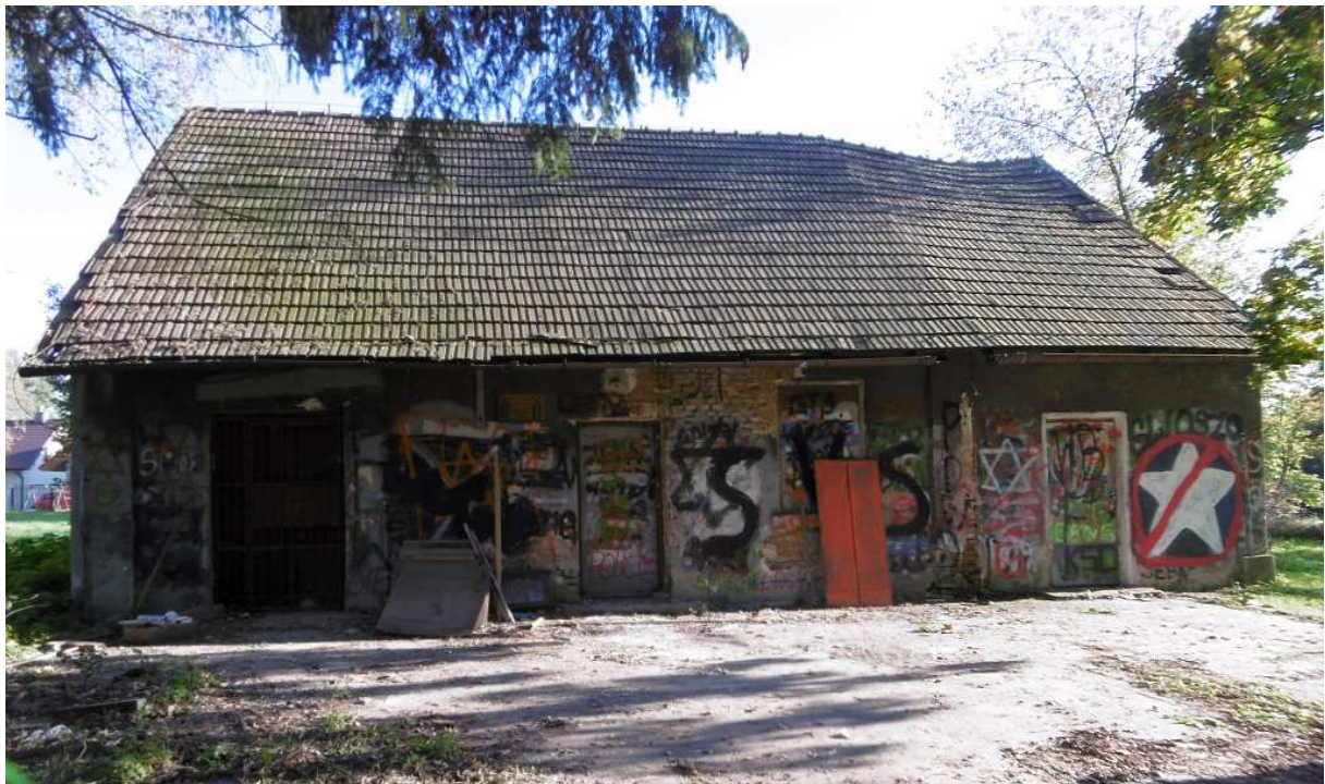
Fot. nr 559 (559-561). Ruina domu przy ulicy Lusińskiej 17.
