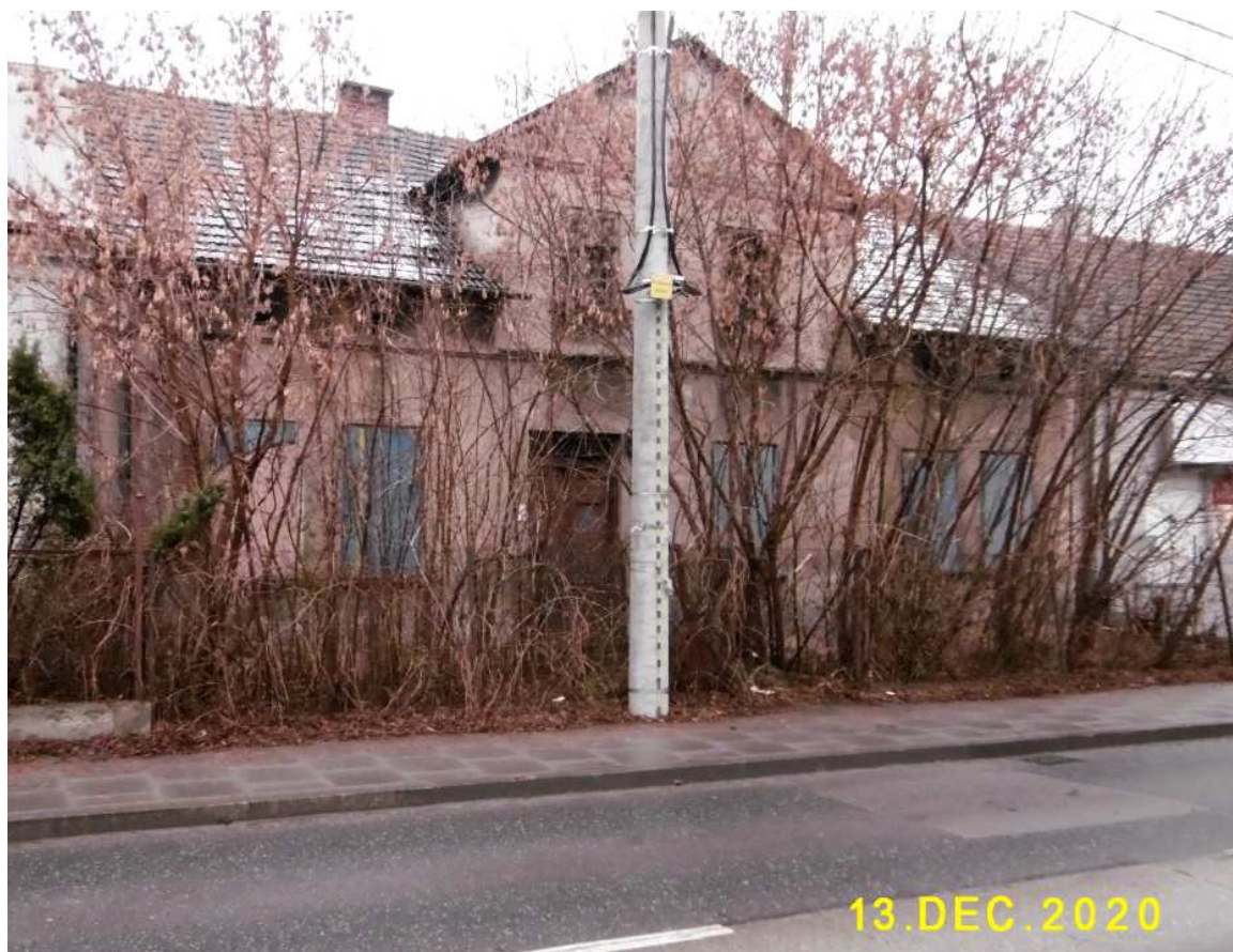
Fot. nr 212 (212-213). Ruina domu spod nr 63, który dorywa ponad dekadę.
