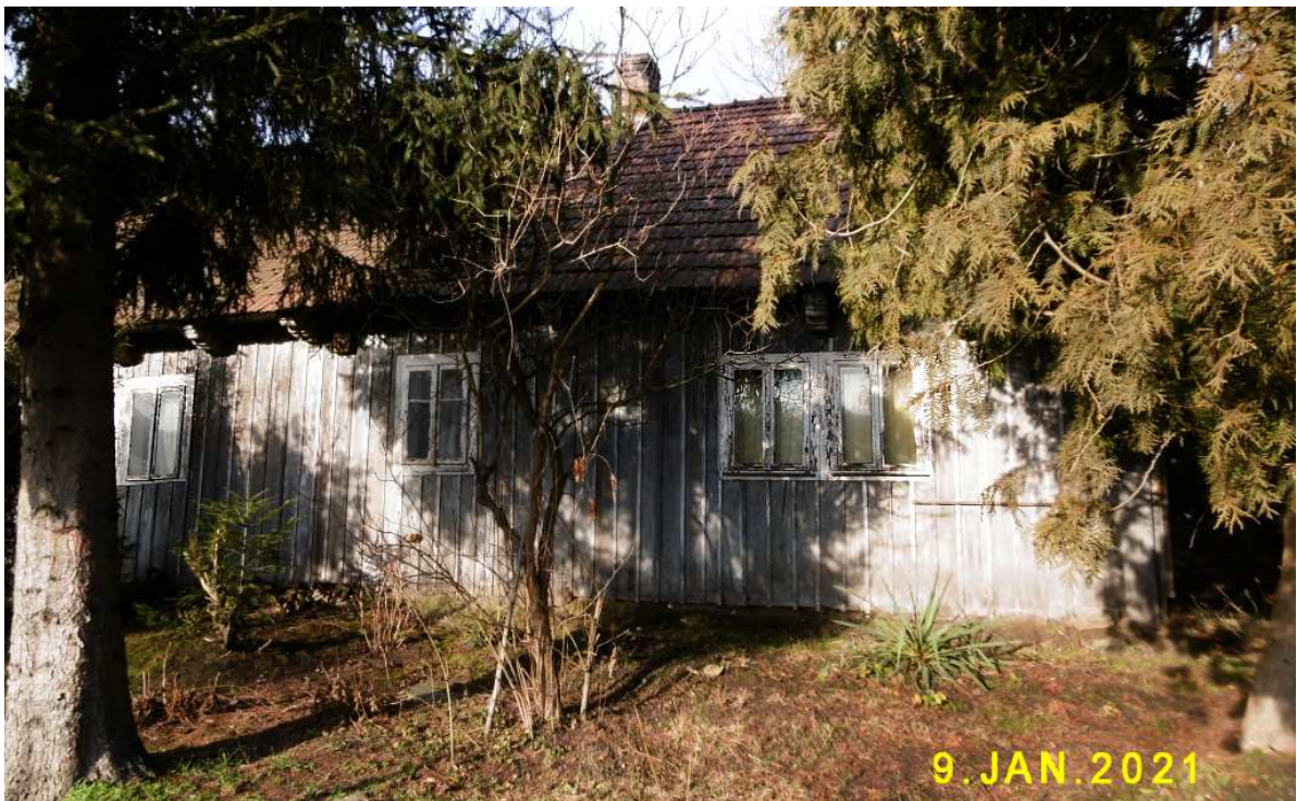
Fot. nr: 515-537 – wzdłuż ulicy Kosocickiej. Fot. nr 515 (515-517). Pokryta dziś szalunkiem chałupa spod nr 16, pochodząca z końca XIX wieku, której fasadę niełatwo uchwycić zza drzew.
