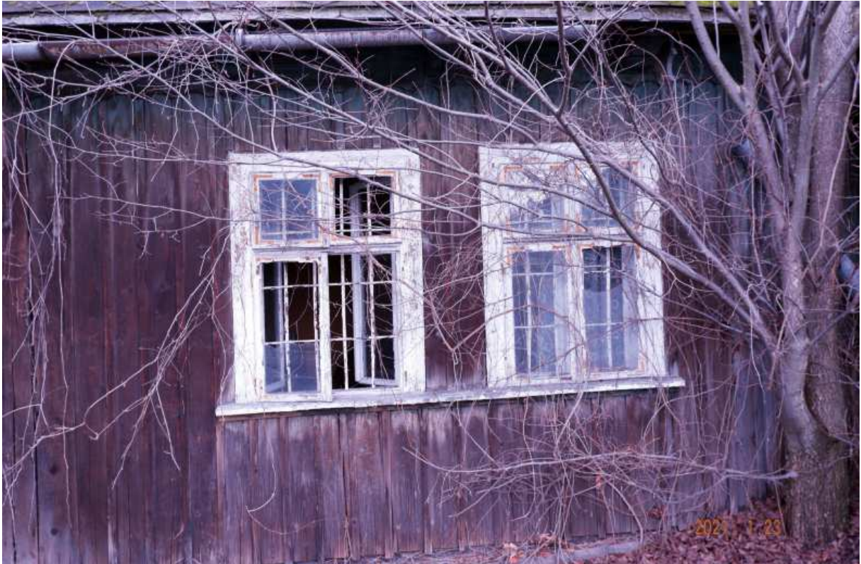
Fot. nr 464. Okna typu ościeżnicowego.
