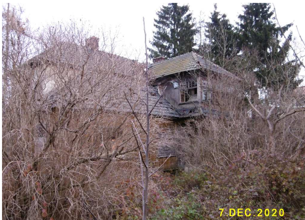
Fot. nr 239 (239-242). Fasada willi, którą coraz mocniej przysłaniają chaszcze.
