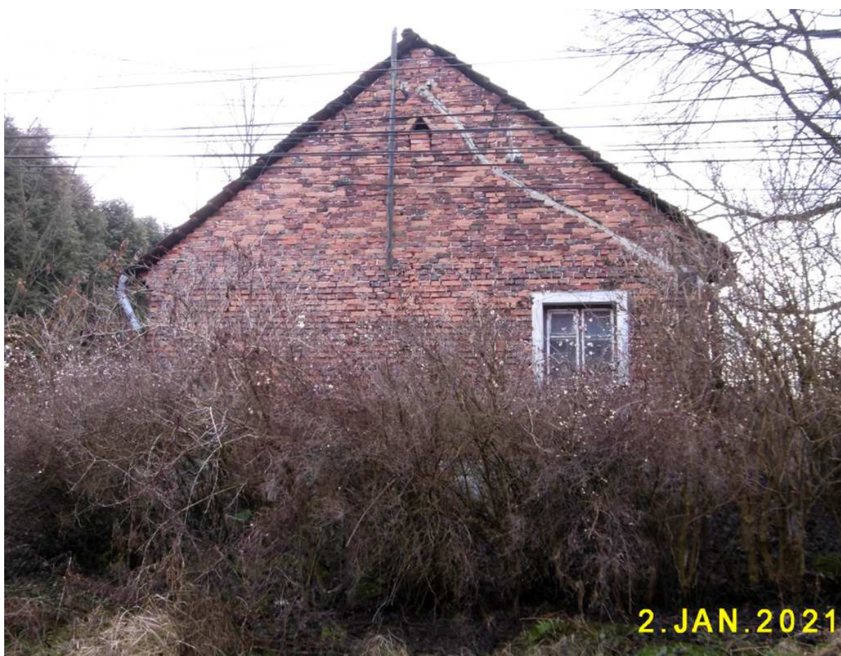
Fot. nr 222. Szczytowa ściana zapewne przedwojennego domu pod nr 21.
