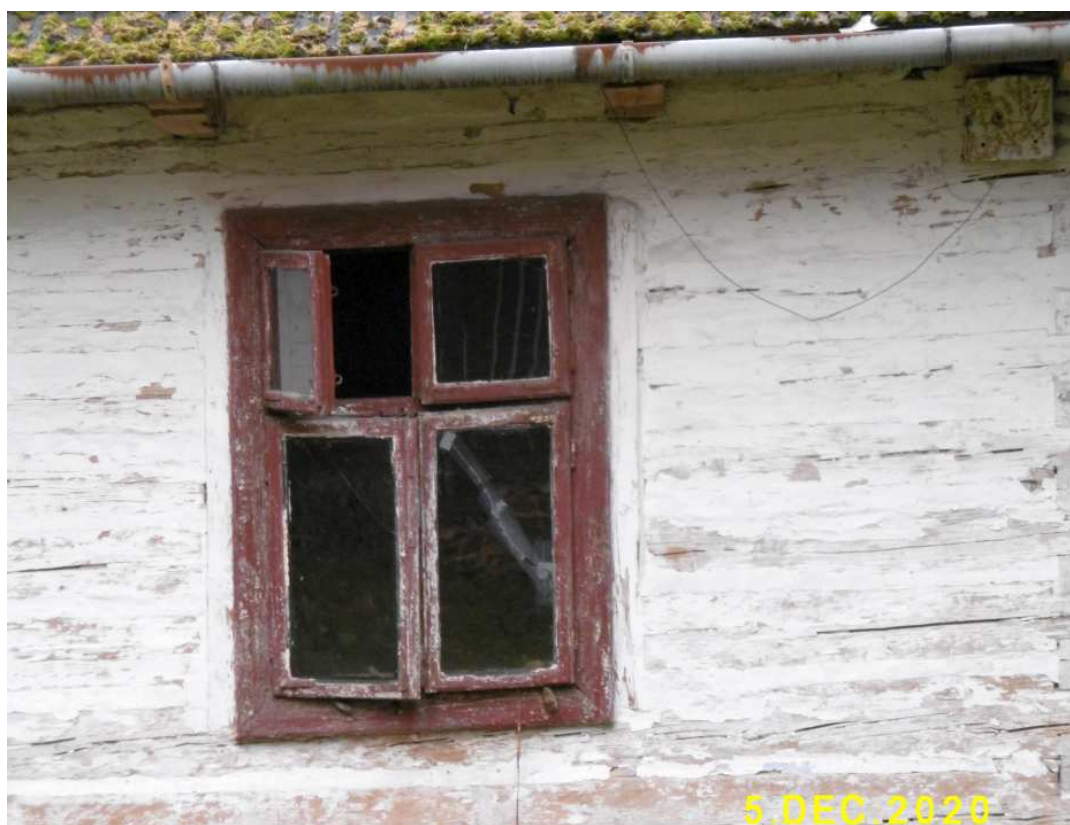
Fot. nr 41. Oryginalne okno typu ościeżnicowego.
