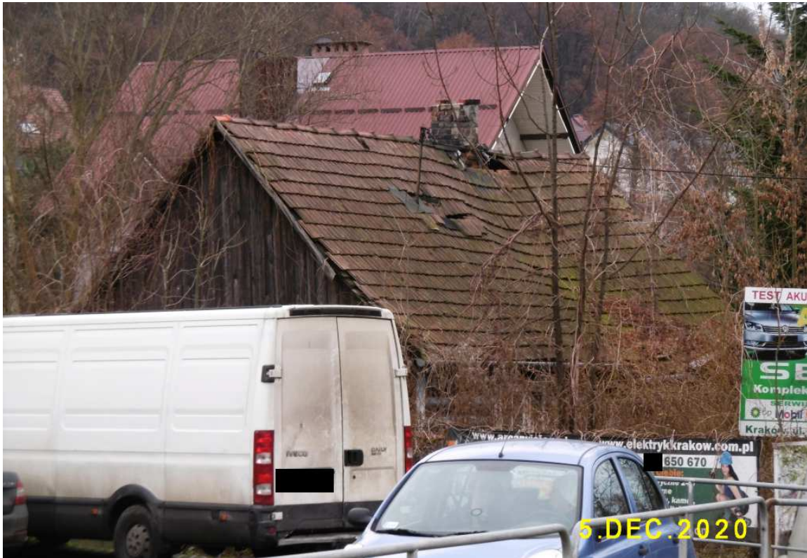
Fot. nr 89 (89-95). Dogorywająca od dekady oryginalna chałupa z ulicy Chełmskiej 17, która mogła zostać wybudowana na przełomie XIX i XX wieku i jej detale.
