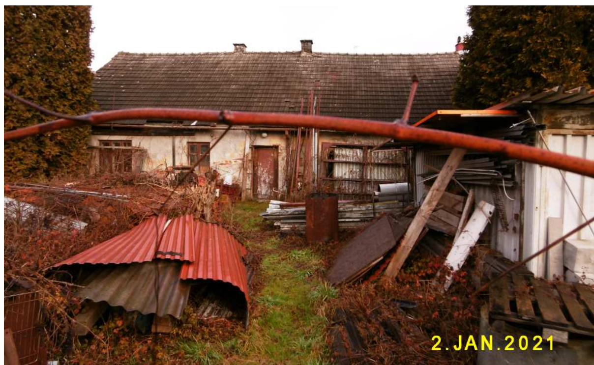
Fot. nr: 242-245. Wzdłuż ulicy Ojcowskiej Fot. nr 242 (242-243). Ruina kompleksu mieszkalno-gospodarczego pod nr 55.
