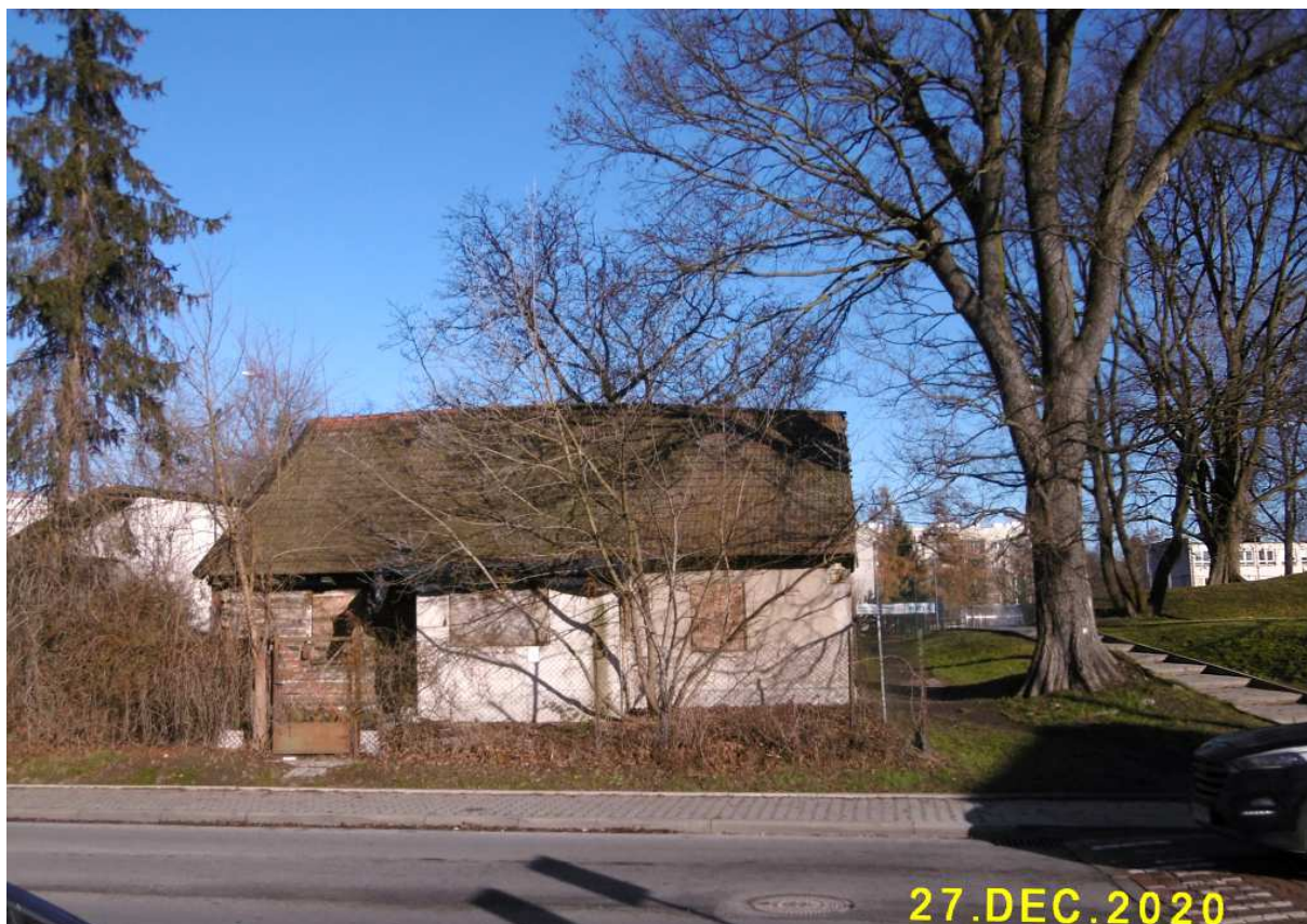
Fot. nr 171 (171-175). Częściwo otynkowana ruina drewnianej chałupy pod nr 97.
