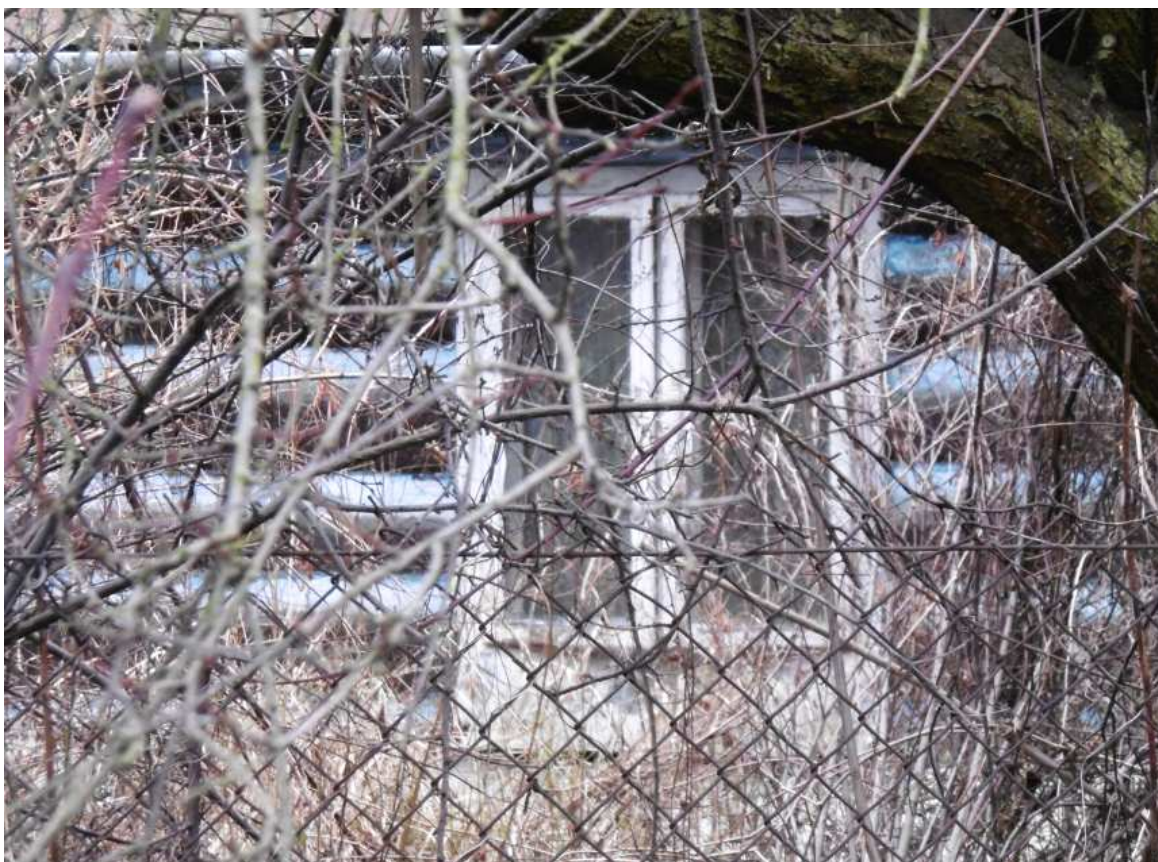
Fot. nr 93. Nieoryginalne juž okno.
