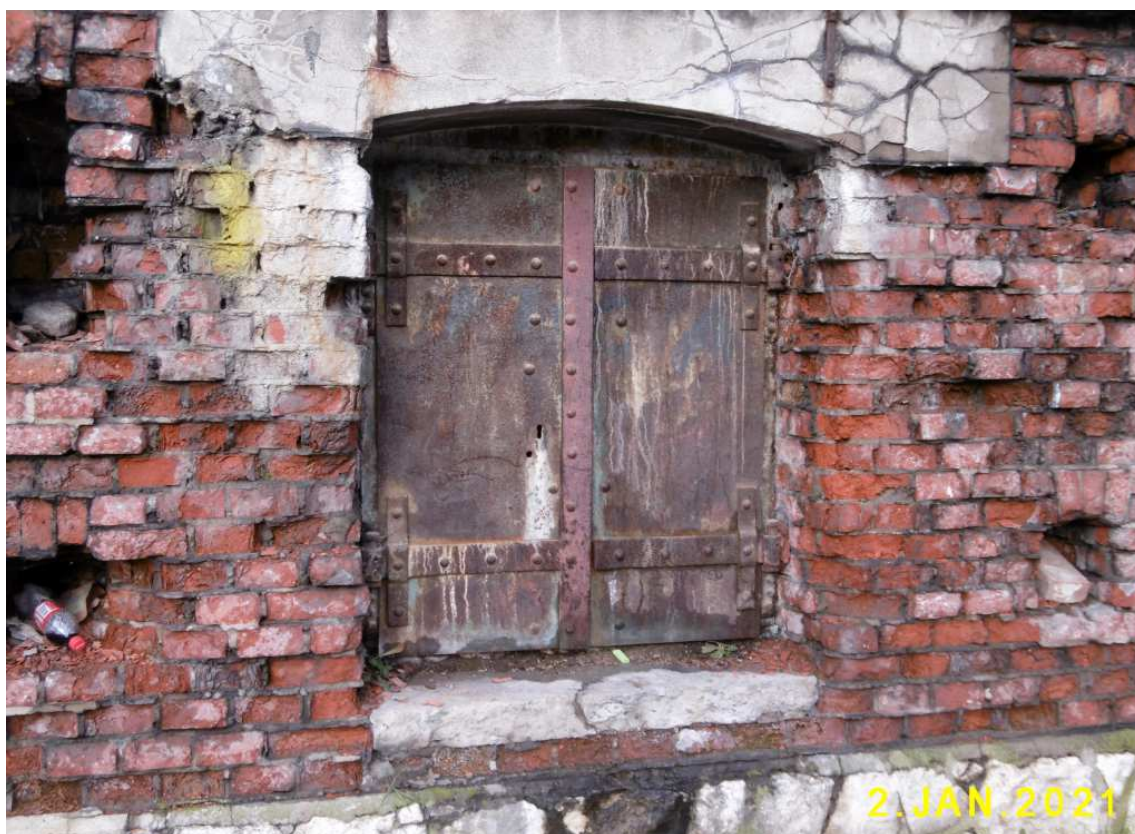
Fot. nr 285 (285-286). Metalowe osłony okien.
