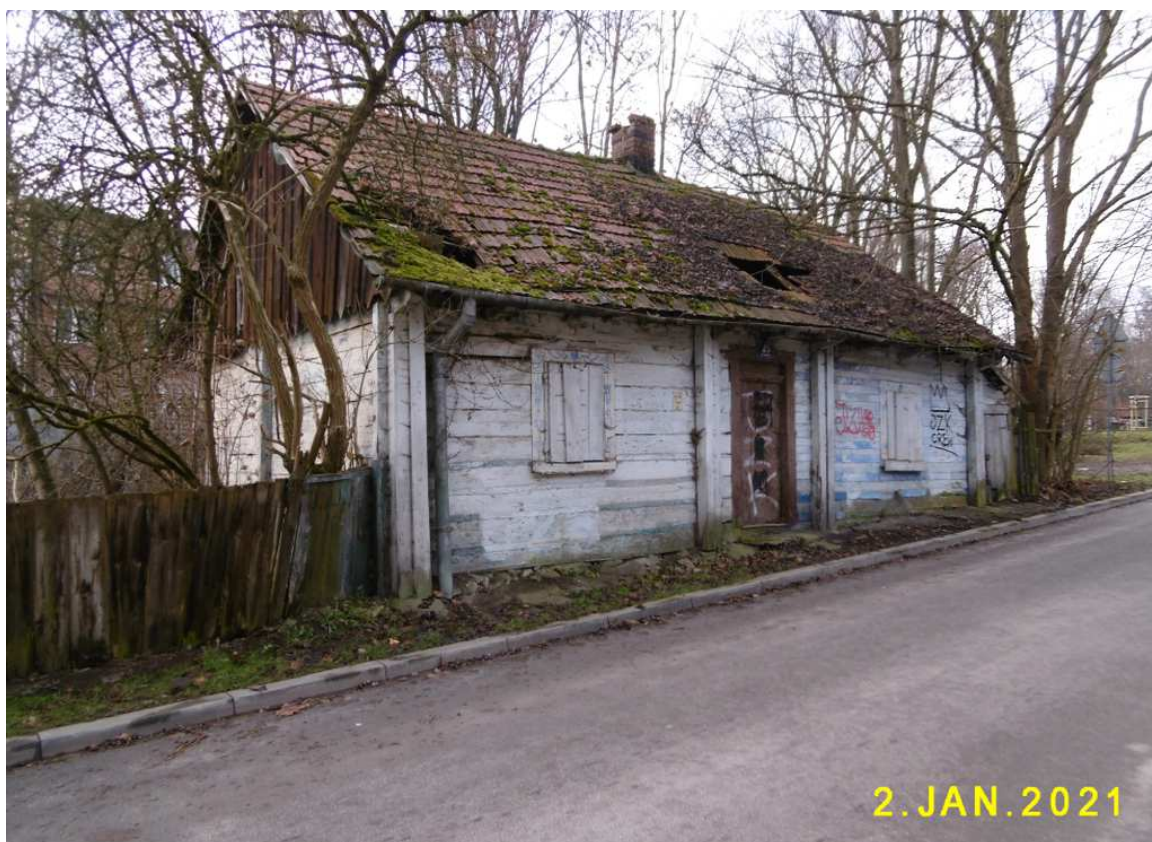
Fot. nr 192 (192-195). Serce się kraje patrząc na ruinę chałupy spod nr 25, wybudowanej w roku 1912. Początkiem jej końca jest dziurawy dach.
