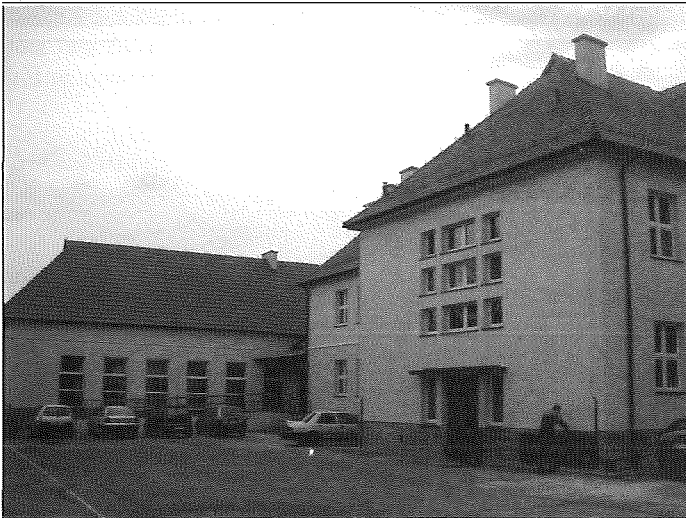
Zakończono remont budynku szkoły podstawowej, który docieplono, wykonano nową elewację i dach.
