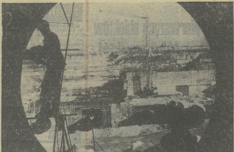
Jedną z największych inwestycji na terenie woj. gdańskiego jest budowa elektrowni w Żarnowcu. Będzie to elektrownia szeptowo-pompowa o docelowej mocy 4 x 170 MW. Pierwszy prąd z Żarnowca popłynął ma w 1980 r.
