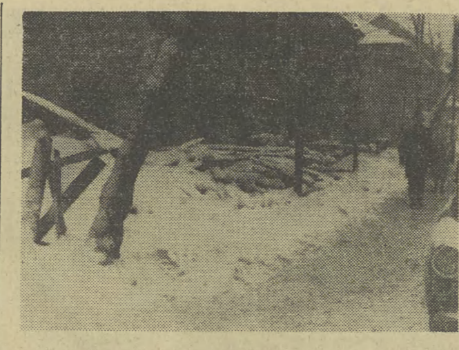
Taki oto obraz przedstawia oddział ul. Limanowskiego, (przed Zakładami „Wawel”), gdzie po remoncie zostawiono ogromny nieporządek. Trudno jest w ogóle przejść chodnikiem.
