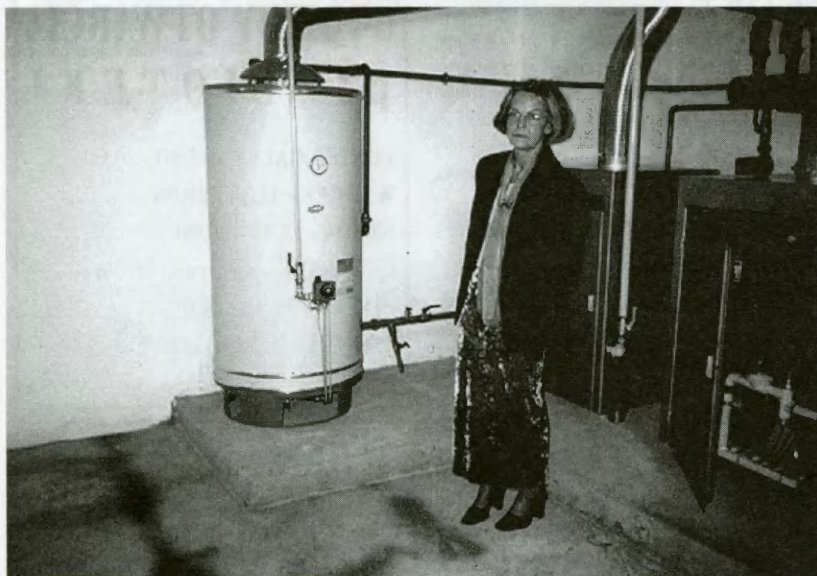
kotłownia w szkole
