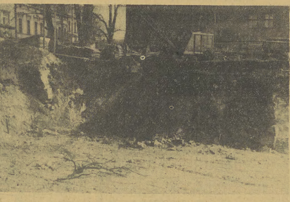
Ogromny wykop — pod fundamenty przyszłego Hotelu Turystycznego, który stanie u zbiegu ulic Westerplatte, Błity pod Lenino i Kopernika. Na razie sytuacja turystyczna w Krakowie jest nieszezęliwa, czekamy więc niecierpliwie na nowy obiekt (prace postępują dość powoli), który przynajmniej częściowo rozwiąże trudności z zakwaterowaniem turystów.
