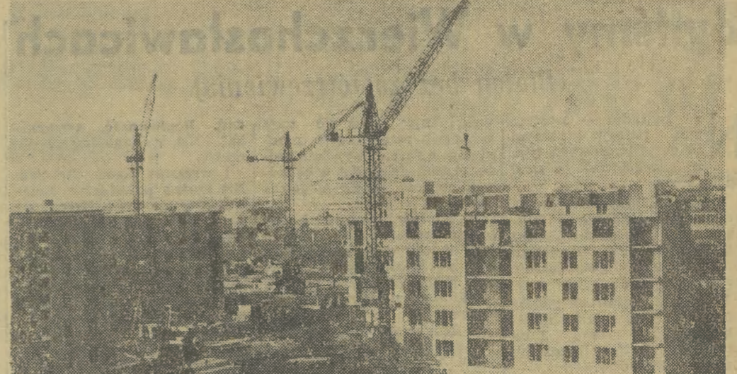
W Warszawie na Wierzbnie powstaje osiedle mieszkaniowe wznoszone metodą przemysłową. Na zdjęciu nowe bloki mieszkalne w budowie.
