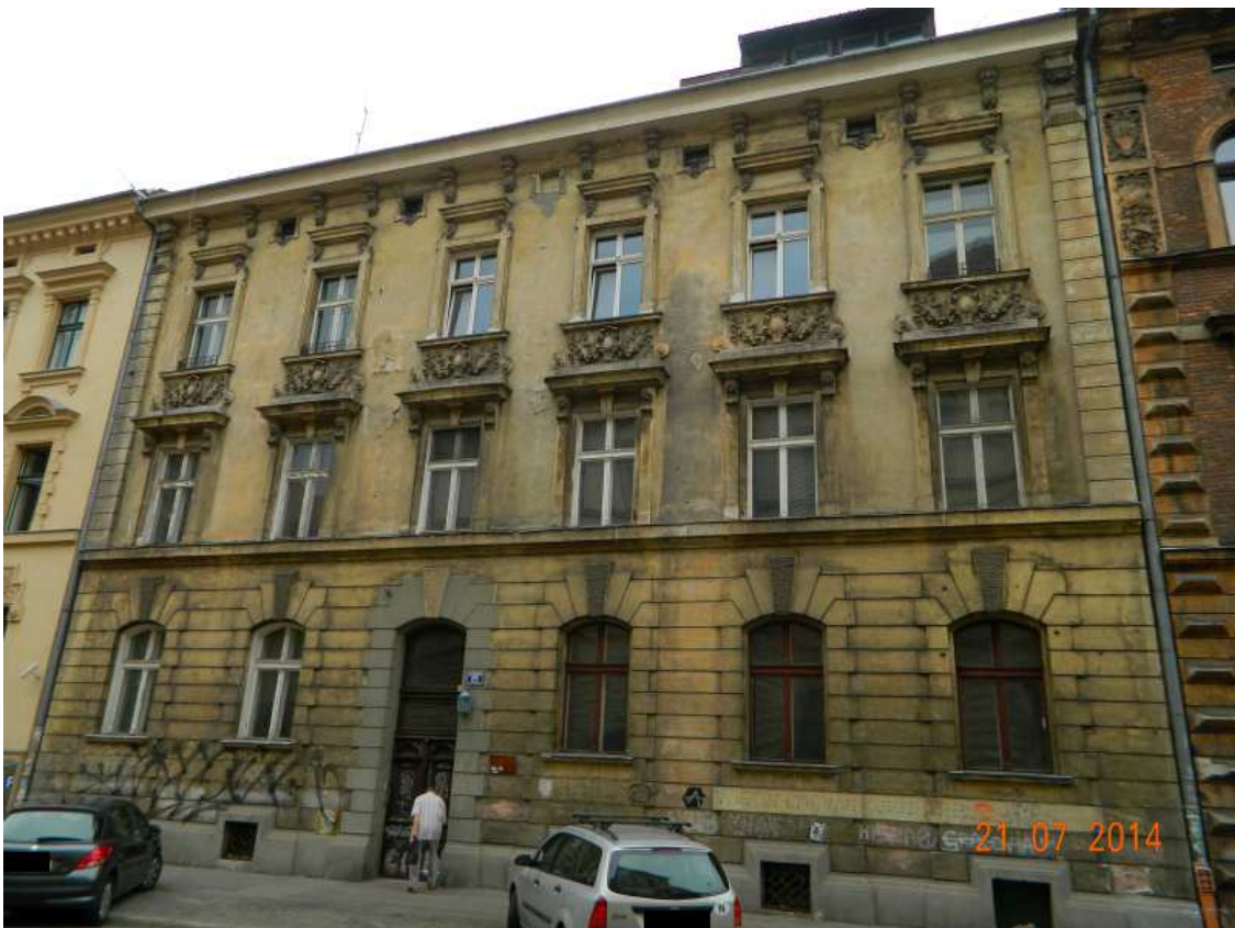
Fot. nr 247. Kamienica Zollów spod nr 25, z lat 1891-93, w oczekiwaniu na remont.
