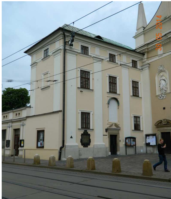
Fot. nr 111 (111-125). Zespół klasztorny Karmelitów Trzewickowych w ujęciach z ulic: Karmelickiej i Garbarskiej. Nr 111-113-budynek klasztorny; tu z pustą wnąka po obrazie.
