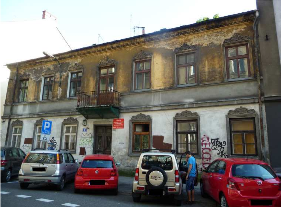
Fot. nr 194 (194-195). Blisko 150-letni dom z ulicy Batorego 8, który od lat systematycznie niszczeje. (17.09.2014)
