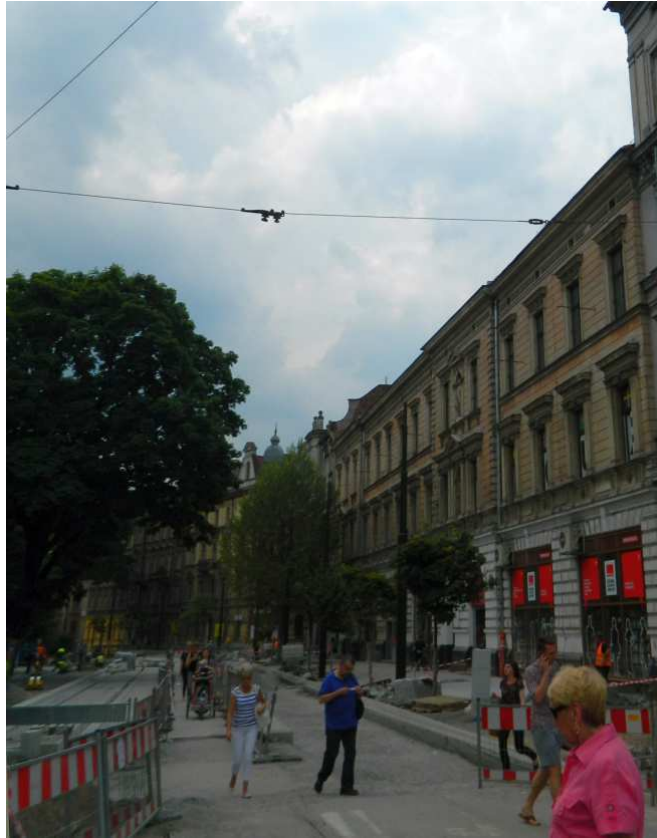
Fot. nr 224. Ulica Podwale w trakcie remontu. Z prawej gmach dawnego gimnazjum żeńskiego pod nr: 5-6, który powstał w I połowie XIX wieku.
