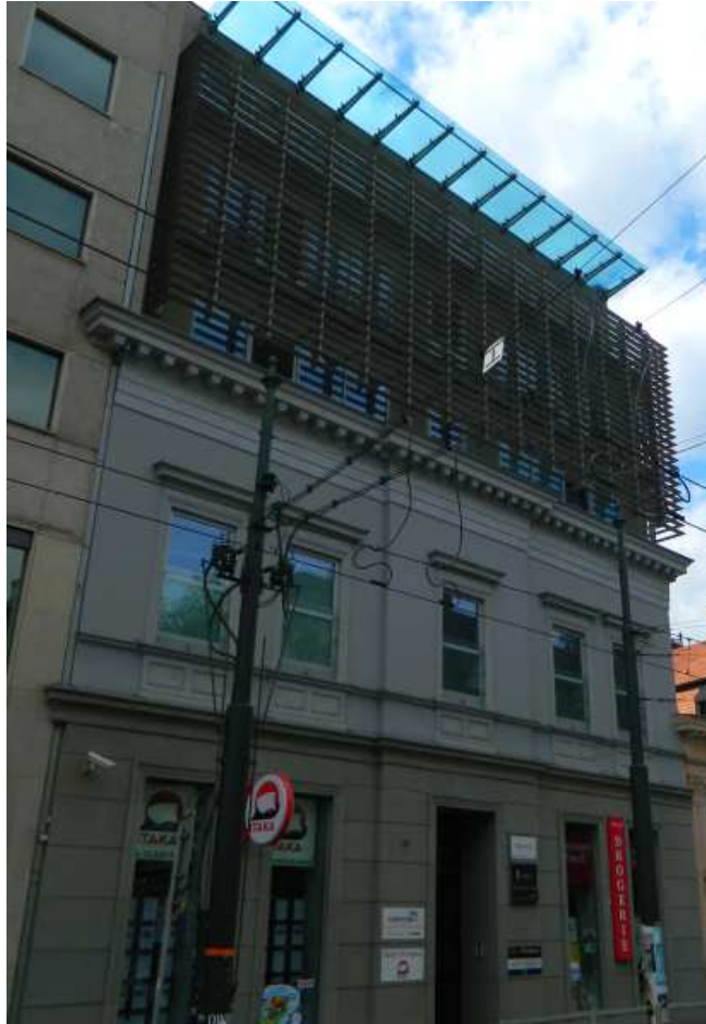
Fot. nr 80. Fatalnie zdewastowana fasada sierocińca, który powstał w roku 1821.
