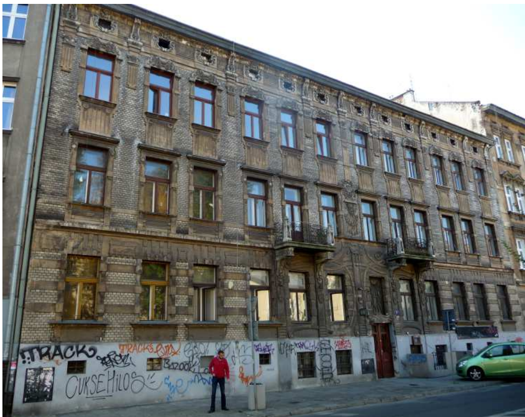
Fot. nr 208. Wybudowana już w I dekadzie XX wieku kamienica spod nr 4 w oczekiwaniu na remont. (17.09.2014)
