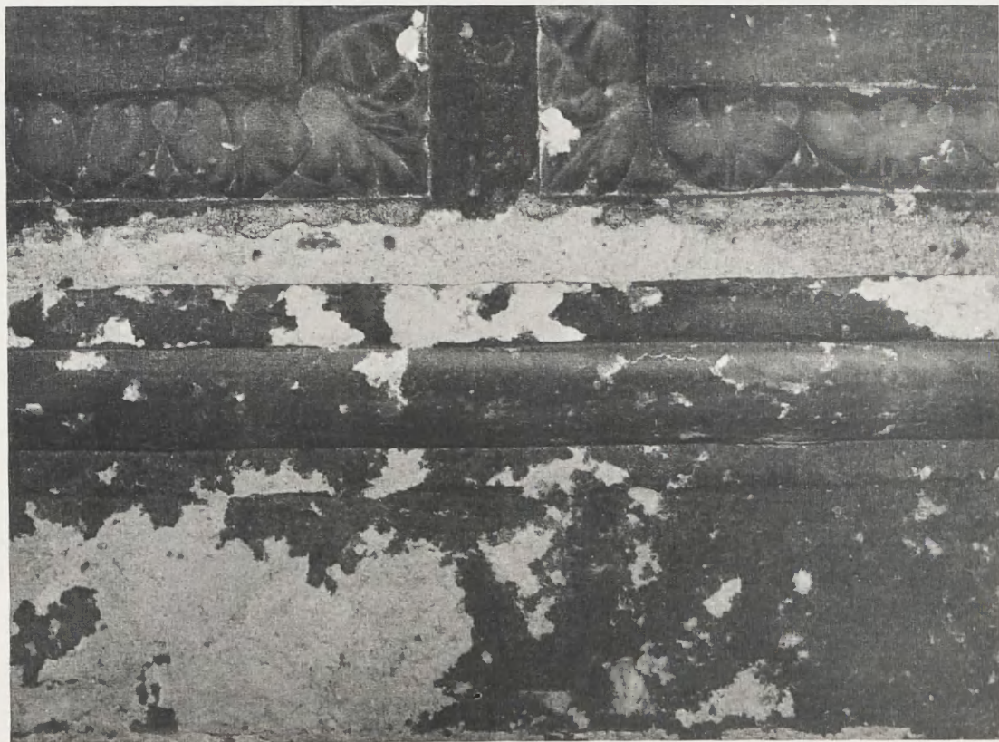
14. Dekoracje sieni wjazdowej zamku w Niepołomicach (1550–1571). Daleko posunięta korozja wapienia prowadząca do przemiany w gips i rozkruszenia powierzchni
