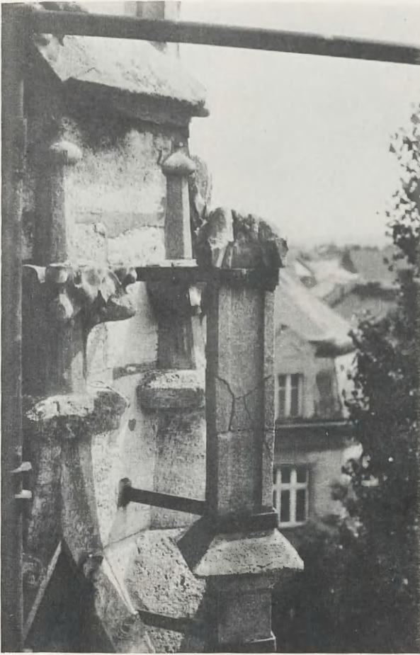
32. Fiala boczna (koniec XIX wieku) zwieńczenia przypory prezbiterium kościoła Św. Katarzyny. Pęknięcie bloku kamiennego na skutek korozji rdzenia żelaznego
