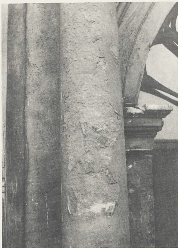
2. Złuszczenia powierzchni kolumny z piaskowca karpackiego. Portal Szarej kamienicy (druga połowa XVII wieku)
