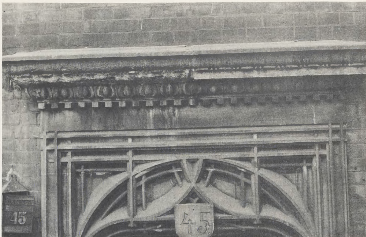
8. Kamienica Pod Orłem, Rynek Główny 45, neogotycki portal wykonany z odpornej na wietrzeń odmiany wapienia, jedynie lewa, górna część gzymsu wykazuje silne zniszczenie
