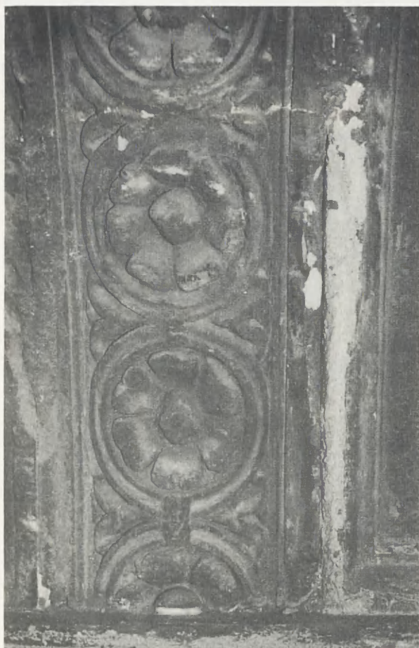
15. Fragment arkady wewnętrznej sieni wjazdowej zamku na Wawelu (1507). Rozety pomimo pokrycia cienką zabrudzoną warstwą gipsu są dobrze zachowane
