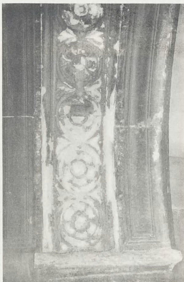
16. Fragment arkady wewnętrznej sieni wjazdowej zamku na Wawelu. Daleko posunięta korozja wapienia prowadząca do powstania kory gipsowej, pod którą postępuje rozkruszanie kamienia
